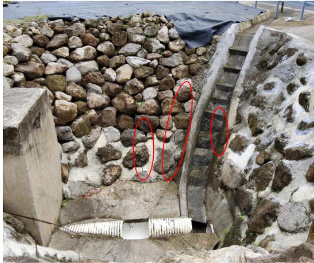
Figura 9 Condición actual de la estructura de contención y registro de aguas
