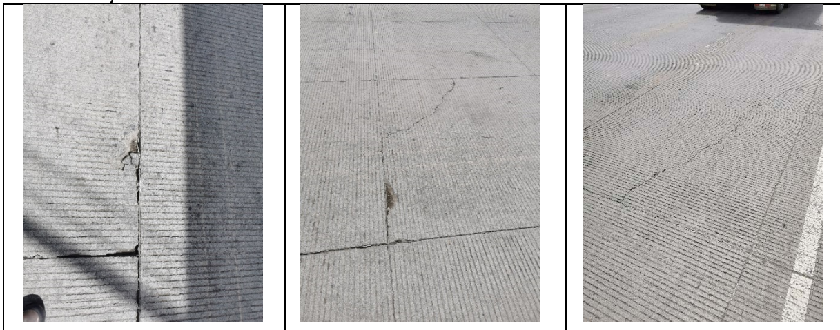
Figura 8. Deterioros observados en Ruta Nacional 2, Sección de control 30730 (Límite Cantonal La Unión / Cartago (Quebrada Quirazú) - Taras (Ruta 236)). Entre los estacionamientos 17+867 a 18+879. Fecha 15 de junio de 2022. Fuente: LanammeUCR
