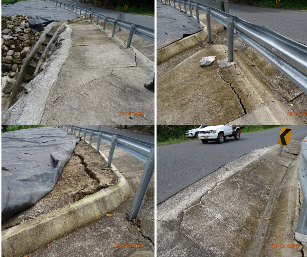
Figura 40. Deterioros de trabajos ejecutados en el Sector Puente Casa con meses de antigüedad. Ruta Nacional 141, Sección de control 20630 (Ciudad Quesada R140 – Florencia R35) Estacionamiento 55+600. Fecha 26 de septiembre de 2022. Fuente: LanammeUCR
