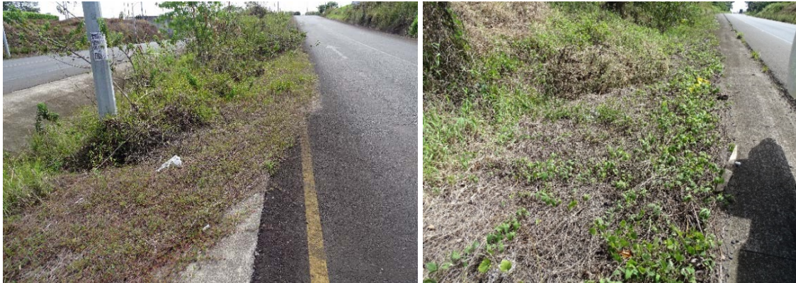
Figura 23. Cunetas cubiertas de maleza. Ruta Nacional 4, Sección de control 40540 (Bajos de Chilamate (R126)-Límite Cantonal Sarapiquí-Grecia). Estacionamiento 0+146 y 1+0820. Fecha 22 de marzo de 2022. Fuente: LanammeUCR
