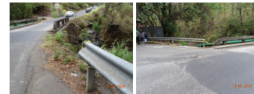
Figura 19. Estado de las reparaciones de los accesos al puente sobre el Río Ipís, Ruta Nacional 117, Sección de control 19035 (El Límite (RN102) – Límite Provincial San José/Heredia (Río Virilla)). Estacionamiento 1+545. Fecha 15 de febrero de 2023. Fuente: LanammeUCR
