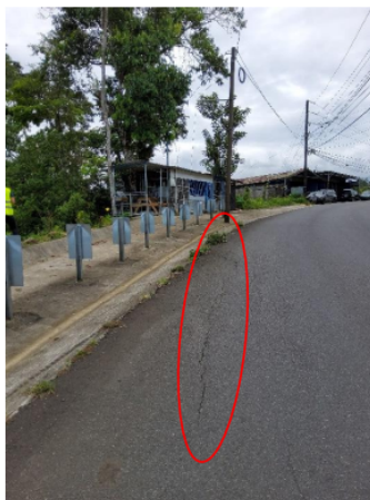
Figura 1 Grieta localizada en la superficie de pavimento
