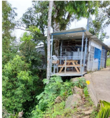
Figura 3 Vivienda ubicada en la corona del talud
