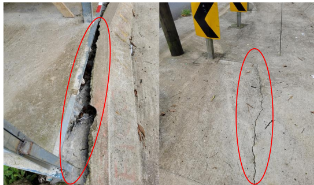
Figura 4 Agrietamientos en los alrededores de la vivienda
