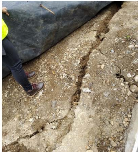
Figura 11 Formación de surcos en el relleno por filtración de agua de escorrentía
