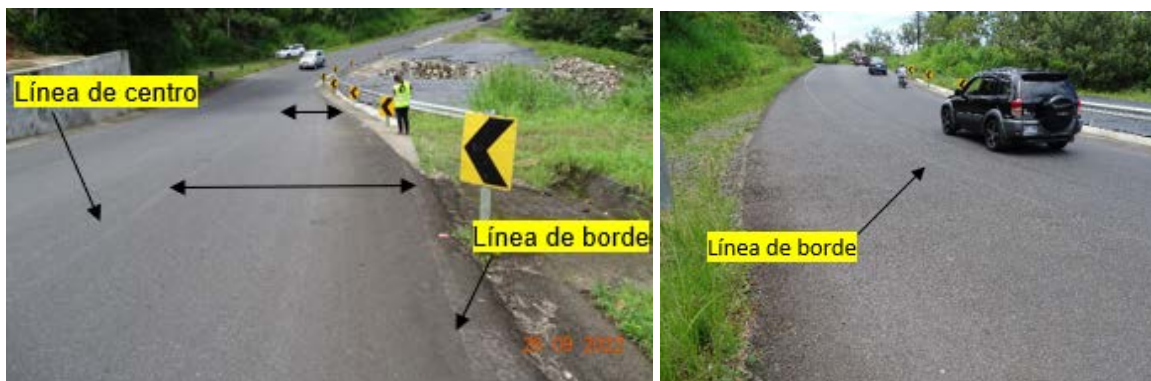
Figura 41. Modificación del trazado original de la ruta sentido Ciudad Quesada - Florencia. Ruta Nacional 141, Sección de control 20630 (Ciudad Quesada R140 – Florencia R35) Estacionamiento 55+600. Fecha 24 de marzo de 2022. Fuente: LanammeUCR
