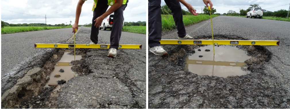
Figura 25. Formación de huecos. Ruta Nacional 1, Sección de control 50040 (Liberia (RN21 y RN918) – Límite Cantonal Liberia/La Cruz (Quebrada Puercos)). Estacionamiento 228+675 y 228+315. Fecha 30 de junio de 2022. Fuente: LanammeUCR
