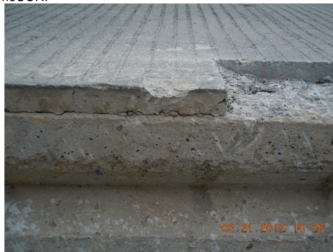
Figura 12. Las reparaciones realizadas no abarcaban la totalidad de las grietas. Ubicación: ruta nacional 2, km 18+700. Sección de control 30730, Lte. Cant. La Unión/Cartago - Taras. Fecha: 21 de marzo de 2012. Fuente: LanammeUCR.
