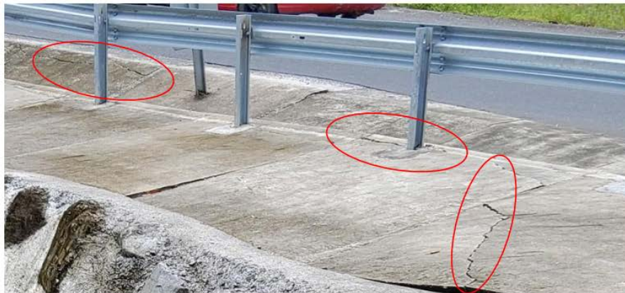
Figura 8 Agrietamiento de la corona y cuneta correspondientes al talud inferior de la vía en el sitio "Puente Casa"
