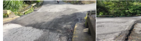
Figura 18. Reparaciones de los accesos al puente sobre el Río Ipís, Ruta Nacional 117, Sección de control 19035 (El Límite (RN102) – Límite Provincial San José/Heredia (Río Virilla)). Estacionamiento 1+545. Fecha 21 de diciembre de 2022. Fuente: Dirección Central de la Gerencia de Conservación de Vías y Puentes del Conavi.
