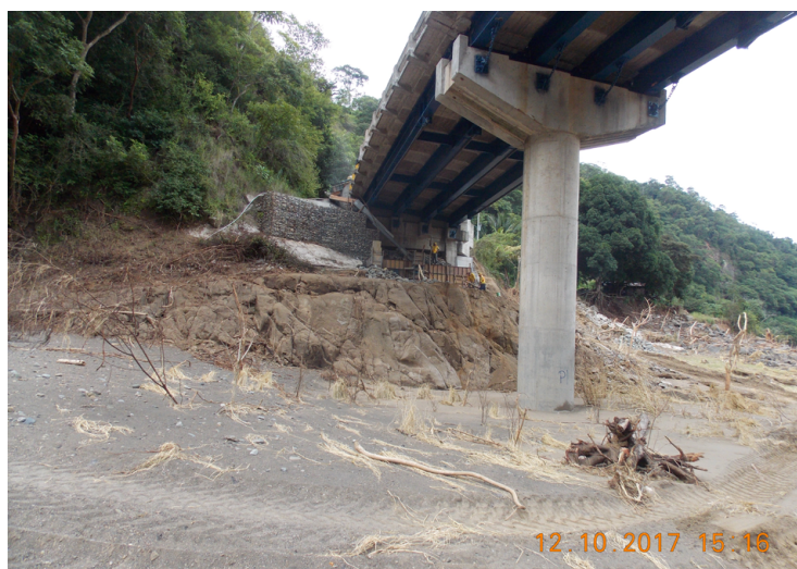
Figura 1. Puente sobre el río Puerto Nuevo en la RN2 después de la tormenta tropical Nate. Fuente: LanammeUCR, 2017
