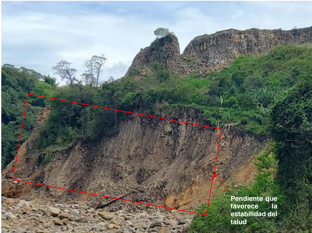
Figura 8. Vista desde el pie del deslizamiento, pendientes residuales en apariencia a favor de la estabilidad
