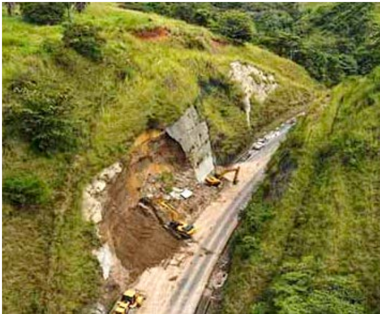
Figura 69. Fotografías del segundo deslizamiento en el talud ubicado en el estacionamiento 40+800, noviembre 2020.
