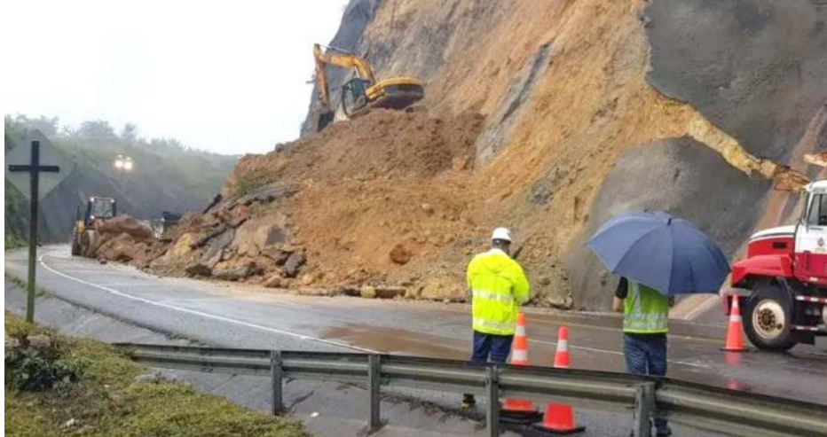
Figura 68. Estacionamiento 38+600. Remoción de los materiales que cayeron en los dos carriles de la vía el 4 de noviembre del 2020.
