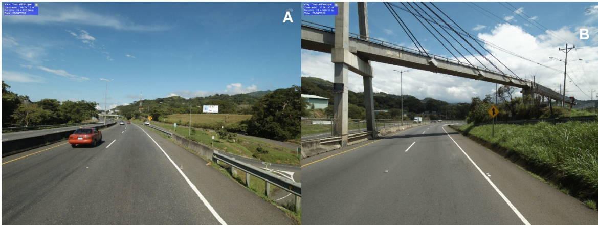
Figura 114. Deficiencias críticas a nivel de discontinuidades en barrera medianera (A) y en pretel de puente (B)
