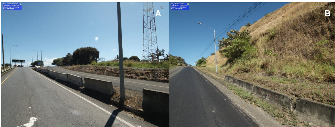
Figura 137. Deficiencias críticas a nivel de discontinuidades en barreras de concreto en la Radial El Coyal (A) y Radial Atenas (B)
