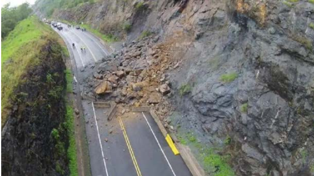
Figura 66. Deslizamiento en el estacionamiento Pk 46+000 que generó el cierre completo de la vía entre Balsa-Atenas y Orotina, junio 2015.
