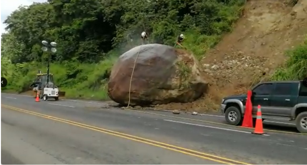
Figura 67. Fotografía de uno de los bloques de roca métricos que cayeron sobre la vía en el estacionamiento Pk 48 y por lo que se tuvo que cerrar la vía mientras se removía, octubre 2017.
