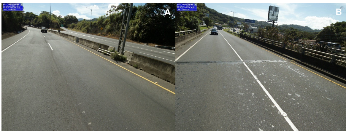
Figura 122. Deficiencias críticas a nivel de discontinuidades en barrera medianera (A) y en pretil de puente (B)
