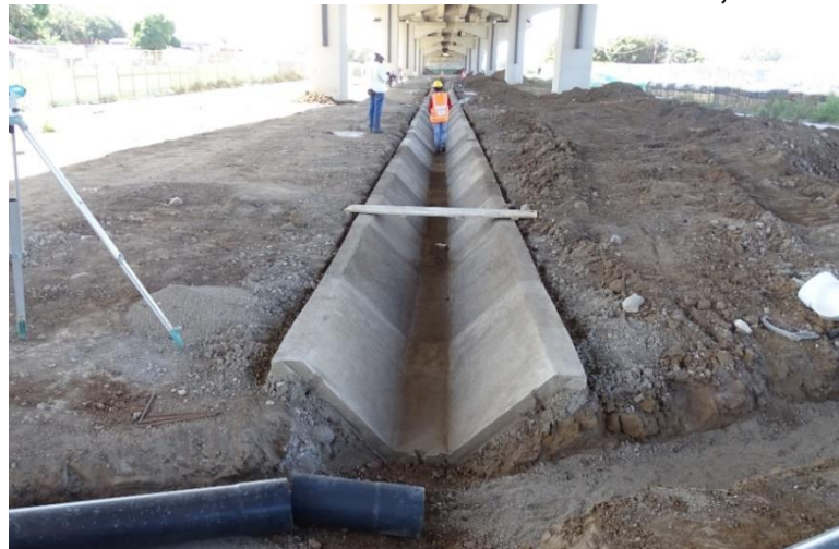
Figura 20. Cunetas y acera en construcción en costado sur de marginal entre pilas 34 y 38 de UF3. Fecha: 10 de febrero de 2021. Nota Informe LM-IC-D-0127-2021, LanammeUCR
