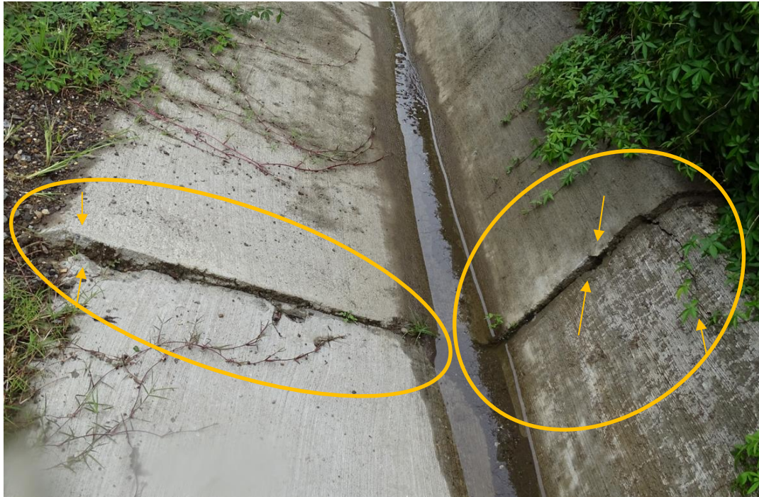
Figura 25. Asentamientos y agrietamientos en cunetas construidas al costado sur del Viaducto entre pilas 8 y 20, UF 3. Fecha: 20 de agosto de 2021. Fuente: Nota Informe LM-IC-D-0728-2021, LanammeUCR.
