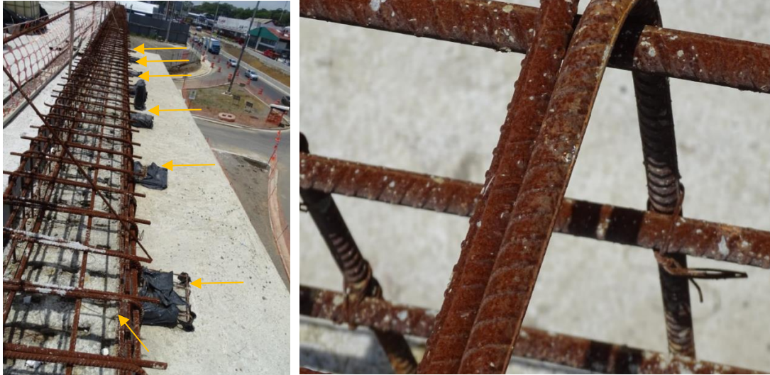
Figura 4. Acero expuesto en bastión Norte, Unidad Funcional 1. Se nota que se protegió el acero de los apoyos pero se ha ido deteriorando la protección con plástico dejando de nuevo expuesto parte del acero. Fecha: 16 de julio de 2021. Fuente: LM-EIC-D-646-2021, LanammeUCR.
