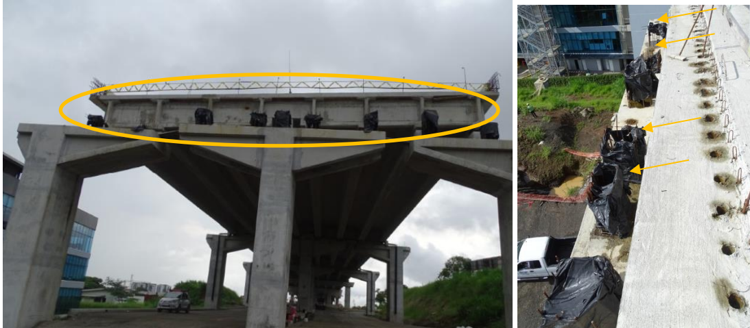
Figura 6. Se nota que se protegió el acero de los apoyos pero la cobertura con plástico se ha ido deteriorando dejando nuevamente expuesto parte del acero en Pila 49, Unidad Funcional 4. Fecha: 15 de junio y 24 de setiembre de 2021. Fuente: LanammeUCR.
