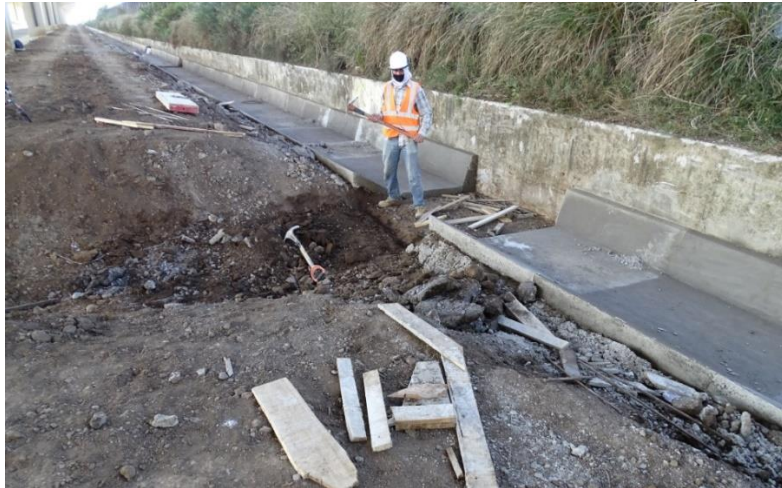
Figura 19. Cunetas en construcción debajo del viaducto entre pilas 1 y 8 de UF3. Fecha: 5 de febrero de 2021. Fuente: Nota Informe LM-IC-D-0127-2021, LanammeUCR
