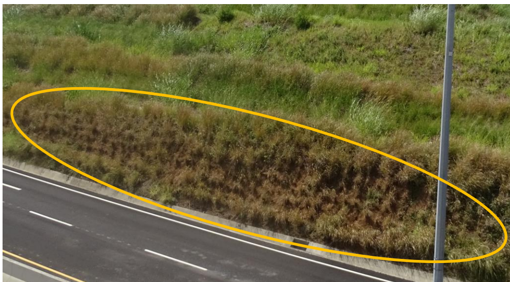
Figura 16. Zona medianamente afectada por erosión por falta de desarrollo de vegetación en la Radial Heredia, lado oeste en Unidad Funcional 2B. Se nota la caída de material a la cuneta. Fecha: 16 de diciembre de 2021. Fuente: LanammeUCR.
