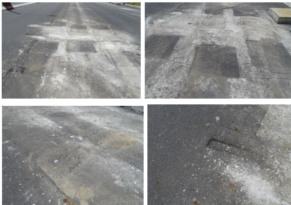
Figura 11. Deterioros en capa asfáltica colocada de la Unidad Funcional 2B. Fecha: 4 de agosto de 2021. Fuente: LanammeUCR.
