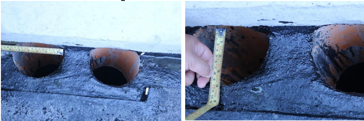
Figura 27. Sumideros con parte de la circunferencia bloqueada por la barrera, en Pila 22. Fecha: 16 de agosto de 2021. Fuente: LanammeUCR.
