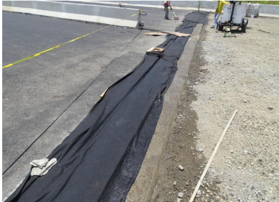
Figura 8. Junta de expansión Oeste del puente sobre Radial Heredia recién colada, en proceso de cura. Unidad Funcional 2B. Fecha: 3 de setiembre de 2021. Fuente: LanammeUCR.
