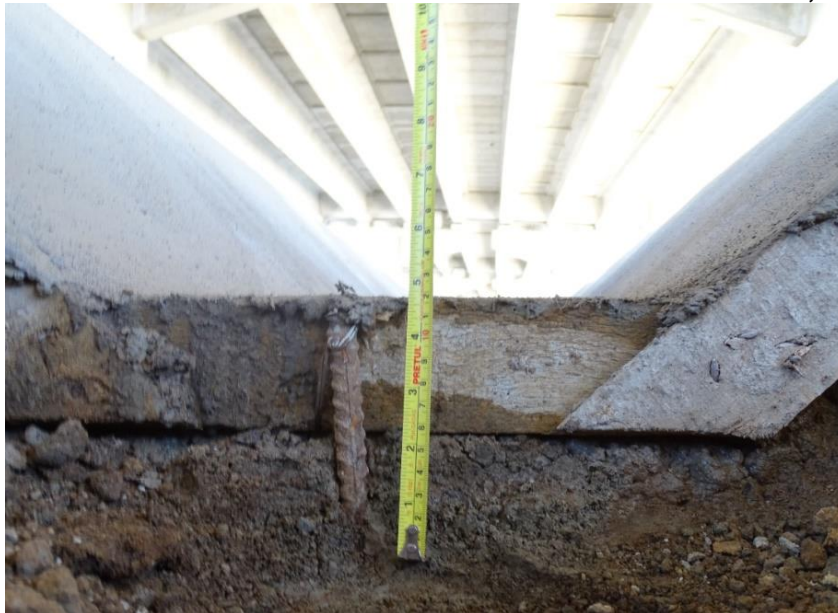
Figura 22. Medición de 12 cm de espesor en el fondo de la cuneta construida. Cerca de pila 2 de UF3. Fecha: 10 de febrero de 2021. Fuente: Nota Informe LM-IC-D-0127-2021, LanammeUCR
