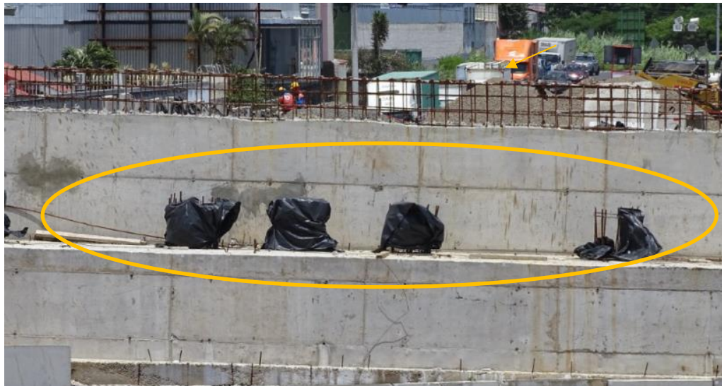
Figura 5. Acero expuesto en bastión Sur, Unidad Funcional 1. Se nota que se protegió el acero de los apoyos pero se ha ido deteriorando la protección dejando nuevamente expuesto parte del acero Fecha: 16 de julio de 2021. Fuente: Fuente: LM-EIC-D-646-2021, LanammeUCR.
