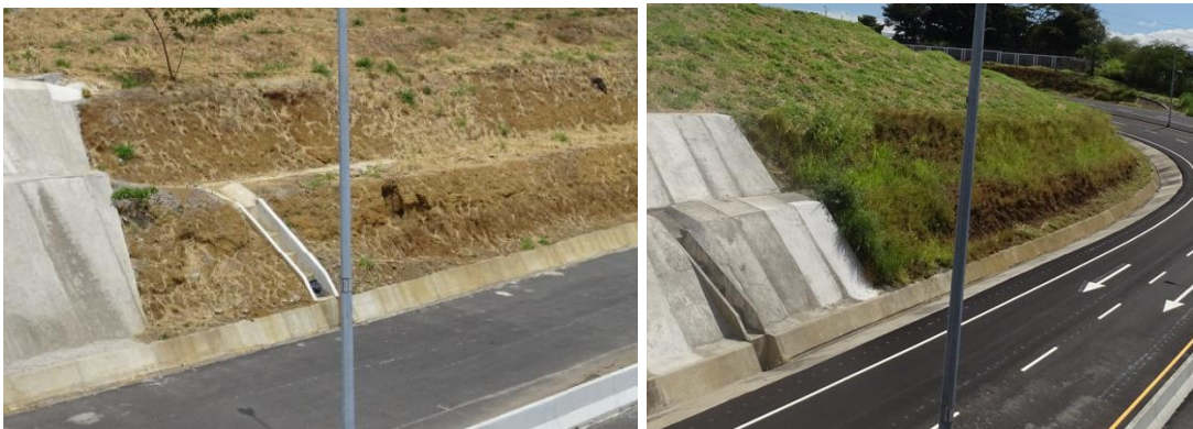
Figura 14. Se revisitó el talud afectado en la Radial Heredia, lado Este en Unidad Funcional 2B. Se nota alguna afectación en zona contigua no revestida. Fecha: 15 de abril de 2020 y 16 de diciembre de 2021 respectivamente. Fuente: LanammeUCR.
