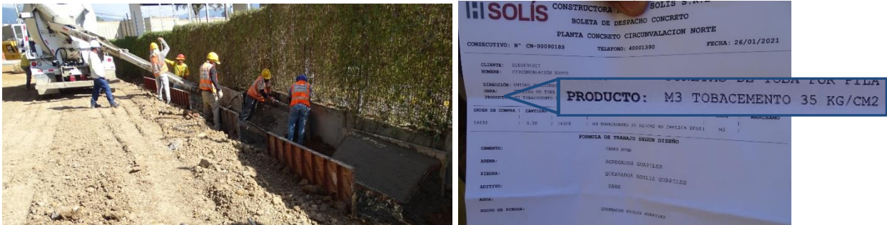
Figura 18. Cunetas construidas en costado norte del viaducto entre pilas 8 y 20 de UF3. Fecha: 26 de enero de 2021. Fuente: Nota Informe LM-IC-D-0127-2021, LanammeUCR
