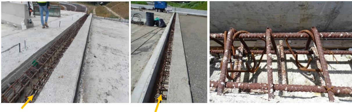
Figura 7. Acero expuesto en la junta de expansión Oeste del puente sobre Radial Heredia. Unidad Funcional 2B. Fecha: 25 de abril de 2019 y 16 de julio de 2021, respectivamente. Fuente: LanammeUCR.
