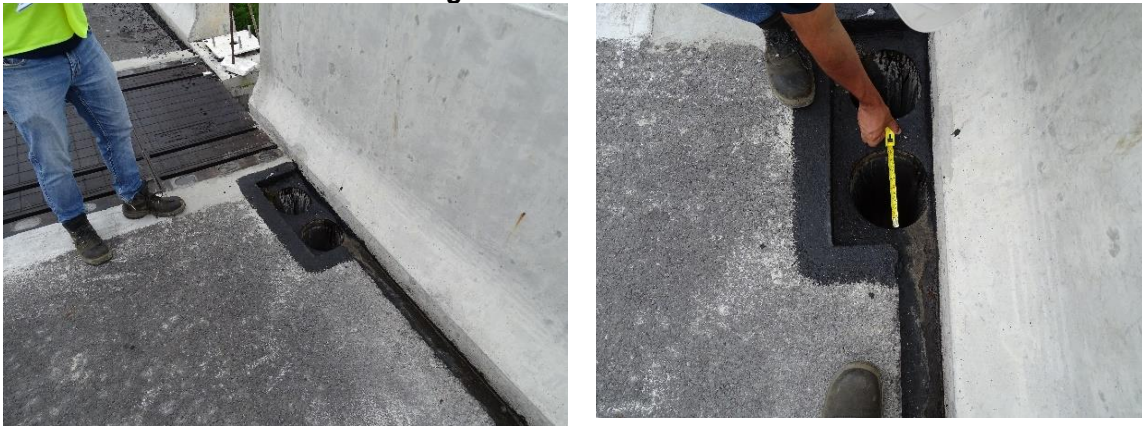
Figura 29. Sumideros con toda la circunferencia disponible para la captación de aguas. Pila 30. Fecha: 16 de agosto de 2021. Fuente: LanammeUCR.
