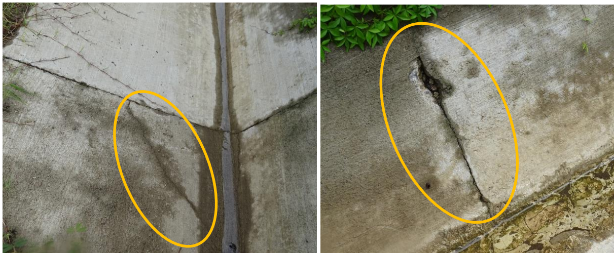
Figura 24. Agrietamientos y quebraduras de borde en cunetas construidas al costado sur del Viaducto entre pilas 8 y 20, UF 3. Fecha: 20 de agosto de 2021. Fuente: Nota Informe LM-IC-D-0728-2021, LanammeUCR.
