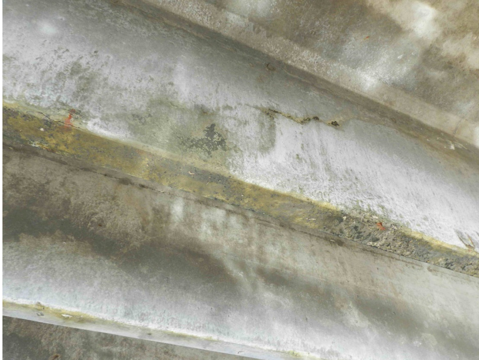
Fotografía n.º 5: Grieta diagonal reportada en la plataforma del SAEP en viga principal de superestructura n.º 1.
