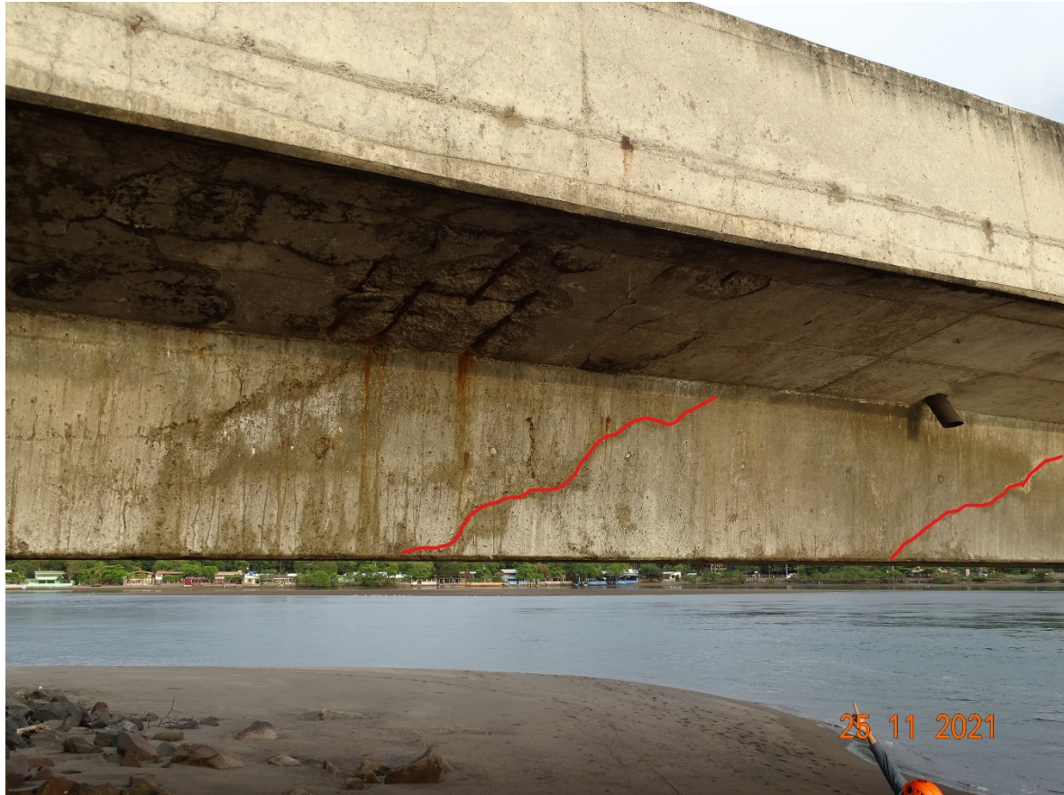
Fotografía n.º 3: Grietas diagonales en primera viga principal (enumerando las vigas desde el costado aguas abajo) de la superestructura n.º 1.
