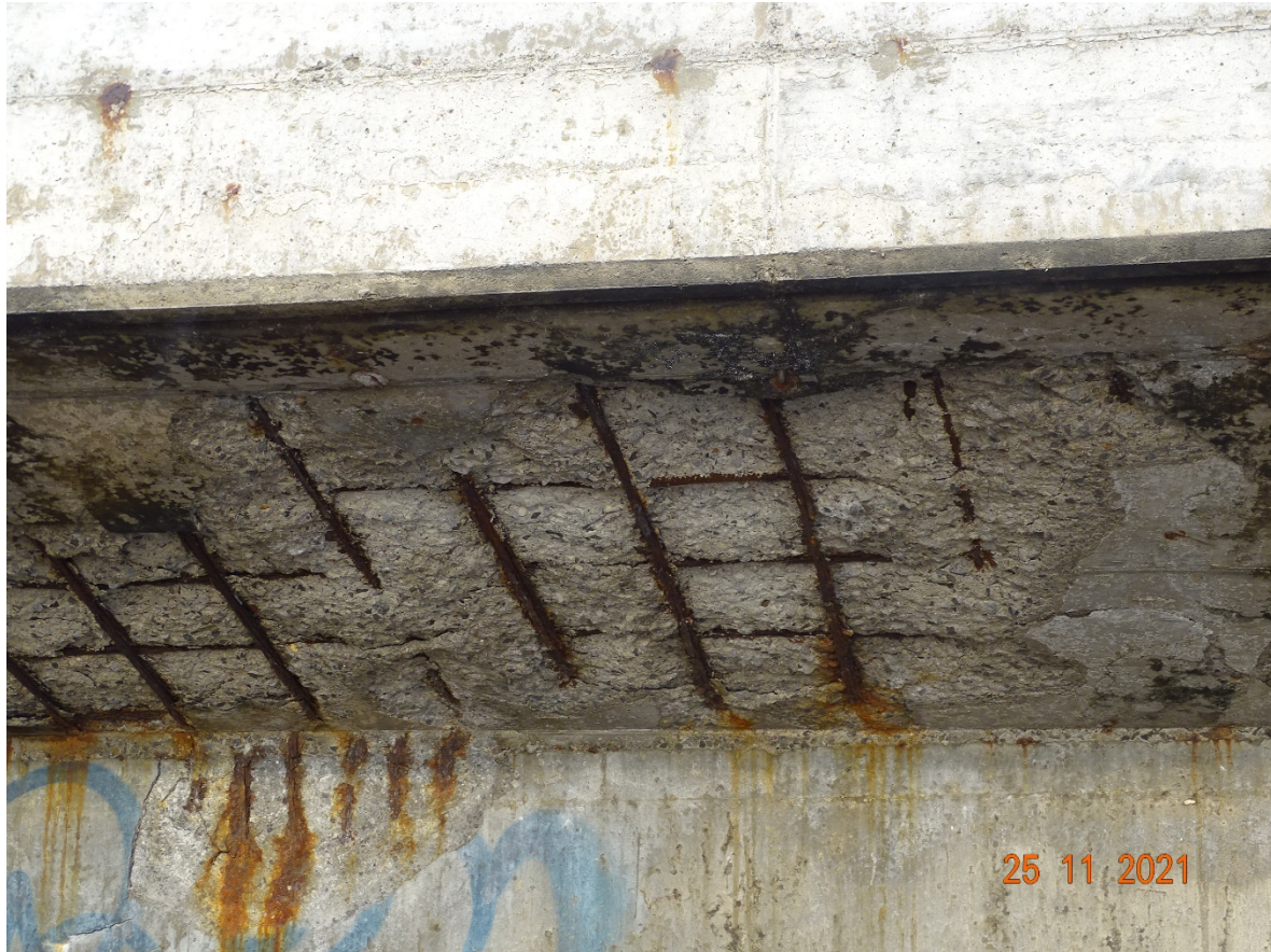
Fotografía n.º 2: Desprendimientos en el voladizo del tablero de concreto reforzado y acero de refuerzo expuesto, corroído con pérdida de sección.
