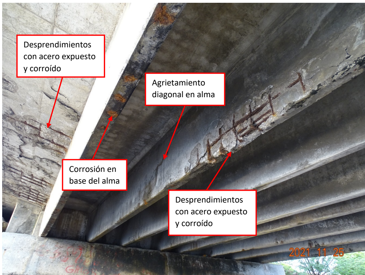
Fotografía n.º 1. Deficiencias observadas en el voladizo del tablero de concreto reforzado y en primera viga principal (enumerando las vigas desde el costado aguas abajo) de la superestructura n.º 1.
