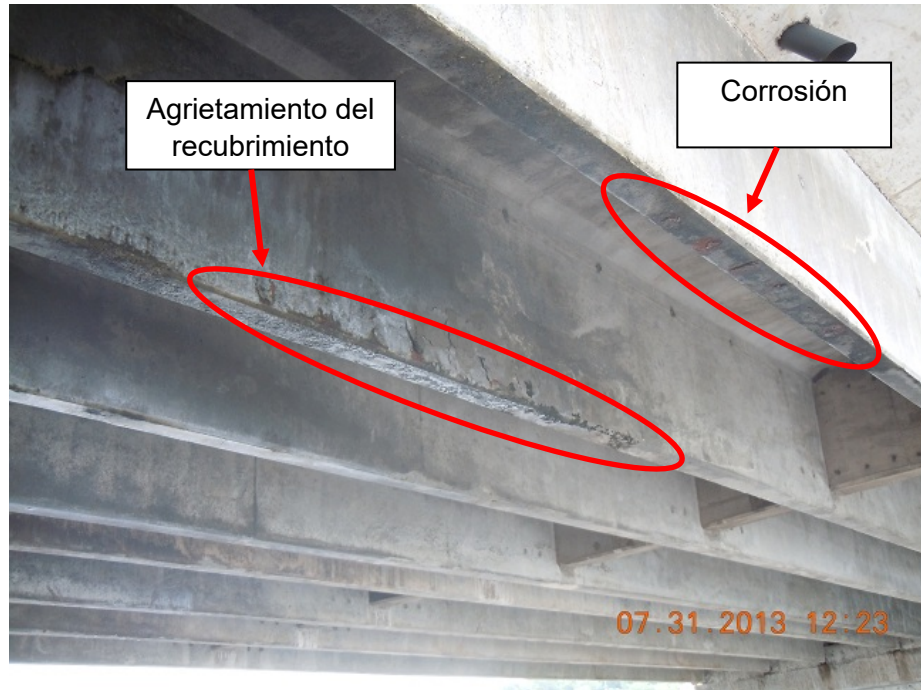
Fotografía n.º 4: Daños en almas de primera viga principal (enumerando las vigas desde el costado aguas abajo) de la superestructura n.º 1 observadas en julio de 2013.
