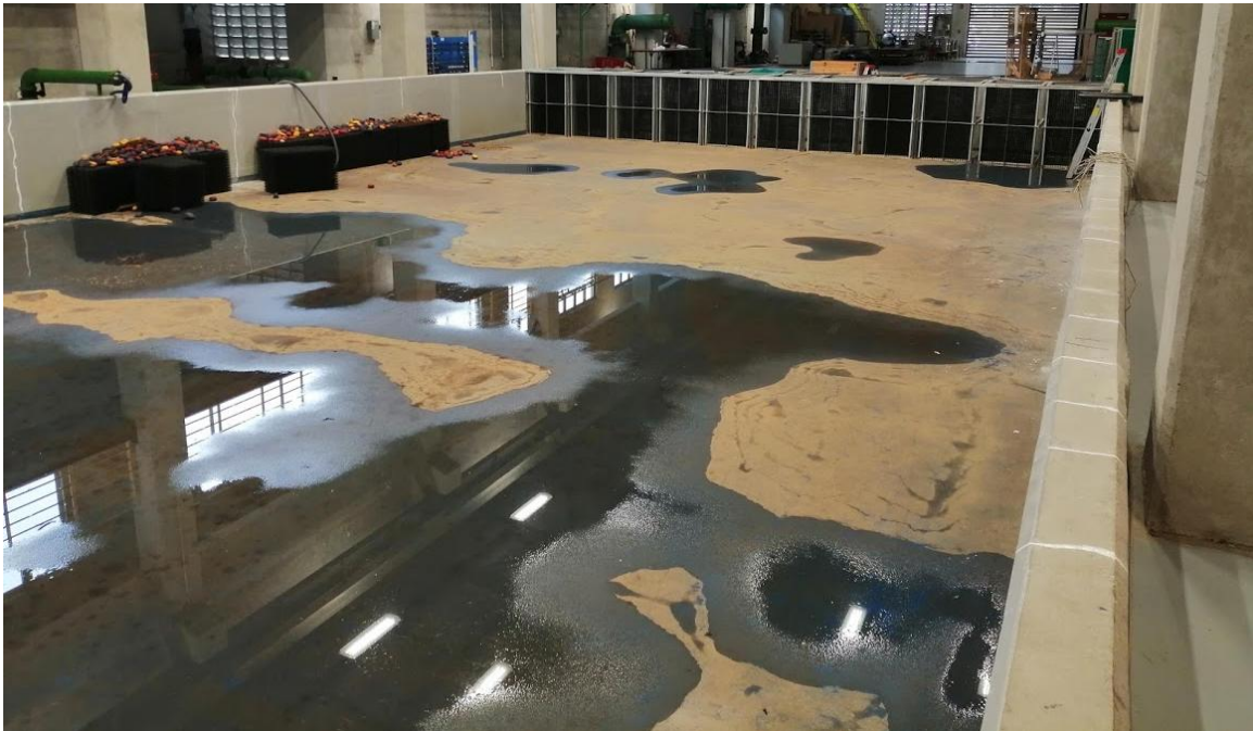
Figura 1: Empozamientos de agua en el fondo de la pileta durante el proceso de secado, imagen facilitada por el Ing. Cornejo.
