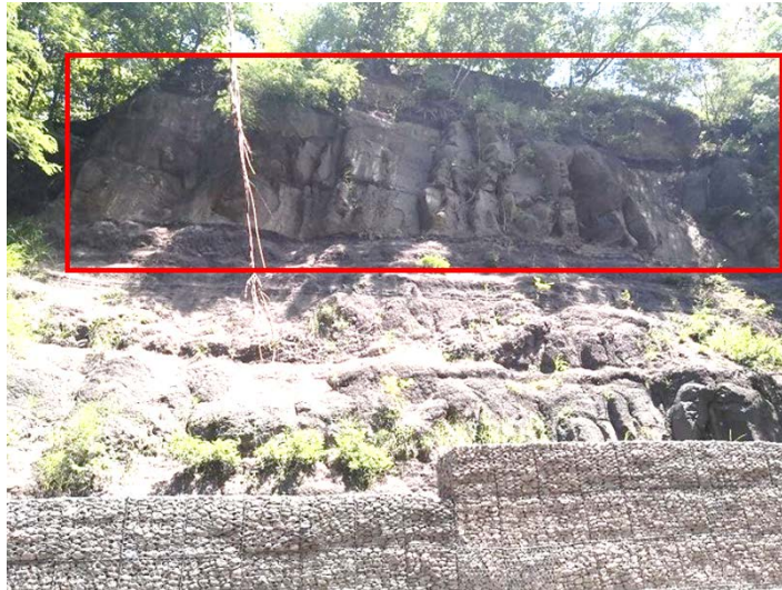
Figura 74. Parte alta del talud en el km 75+900. Se destaca dentro de la línea roja la zona que aparenta potencial de provocar desprendimientos de bloques similares al que sobrepasó el muro de gaviones y cayó en la carretera.
