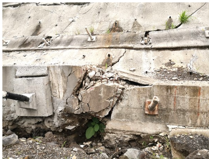
Figura 72. Falla en la viga de amarre al pie del muro anclado.
