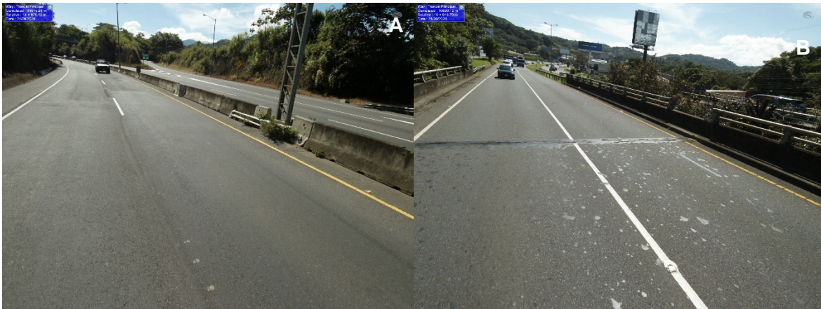
Figura 101. Deficiencias críticas a nivel de discontinuidades en barrera medianera (A) y en pretil de puente (B)
