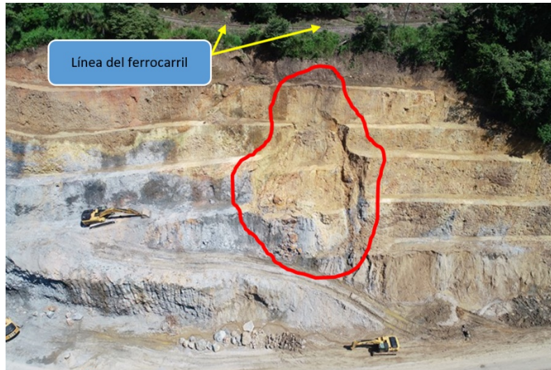
Figura 67, Detalle de un sector del talud de corte en el km 38+600. Dentro de la línea roja se observa un deslizamiento reciente. Se destaca también la cercanía con la línea del ferrocarril.
