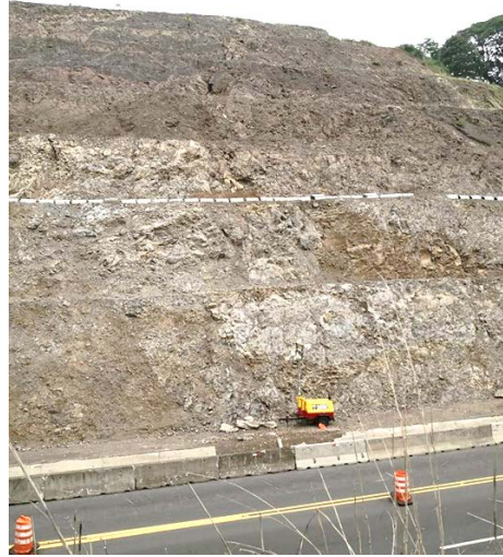
Figura 62. Detalle de un sector del talud del estacionamiento 37+500. En el tramo central se presenta meteorización y fracturación intensa junto con la exposición de bloques de roca con potencial de caer en la carretera
