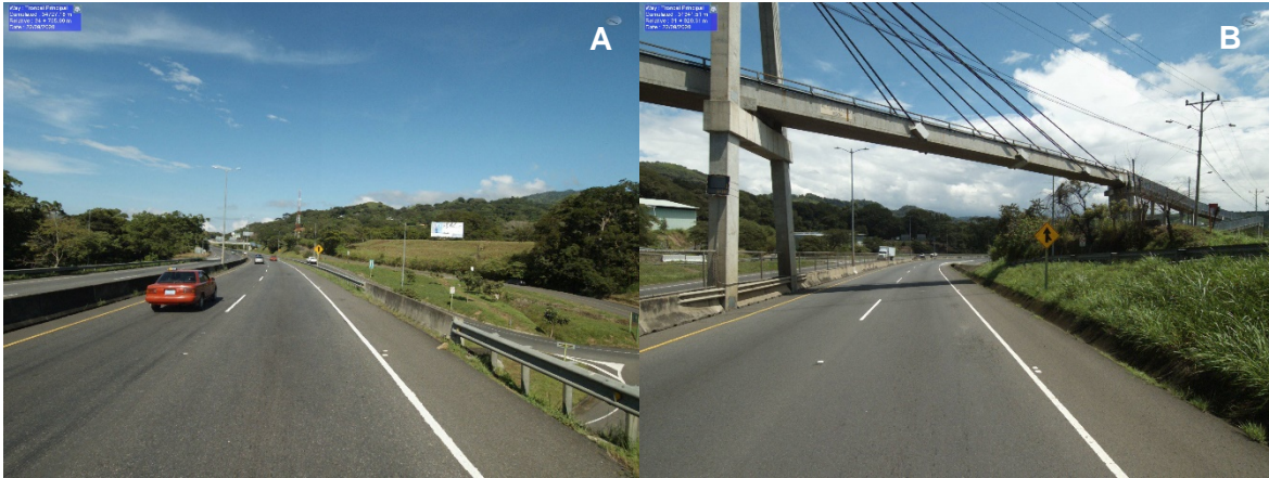
Figura 102. Deficiencia regular en transición de barreras laterales (A) y deficiencia crítica en transición de barrera medianera (B)
