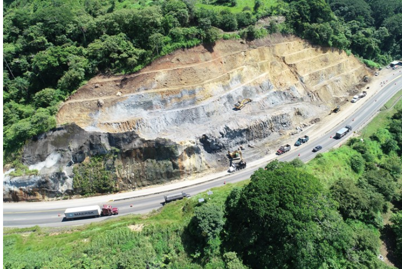
Figura 66, Vista aérea del talud de corte en el estacionamiento 38+600. Se observa el avance que presenta el corte realizado por el Concesionario.
