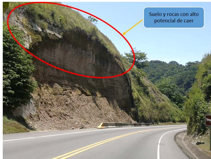
Figura 69. Fotografía del estacionamiento 40+800 de la Ruta Nacional No.27 donde se presentó el deslizamiento, dentro de la línea roja se destaca el material que está sin soporte y con potencial de caer.
