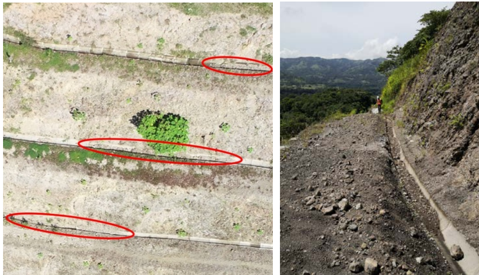
Figura 64. A la izquierda vista aérea de las cunetas con sedimentación a la derecha se muestra el detalle de la acumulación de los sedimentos en las cunetas del talud recientemente cortado en el km 37+500.
