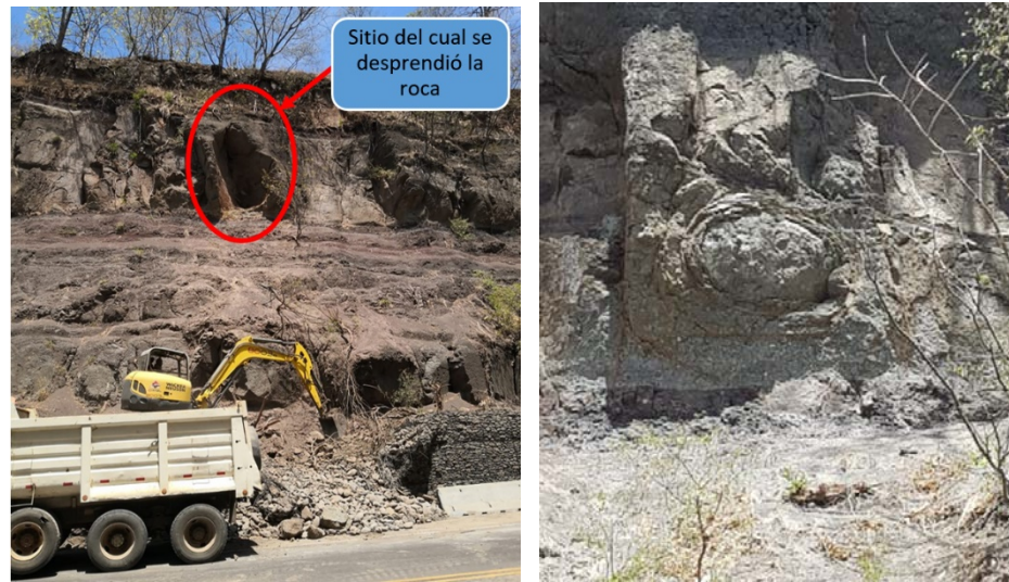
Figura 73 Talud en el km 75+900 luego de la caída de la roca, se aprecia parte del daño que ocasionó en el muro de gaviones y las labores de remoción del material caído. A la derecha se muestra el proceso de meteorización esferoidal que se da en el nivel donde se encuentran las rocas.
