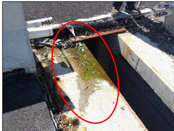
Figura 15. Presencia de agua entre la carpeta asfáltica y el tablero de concreto reforzado del viaducto.
