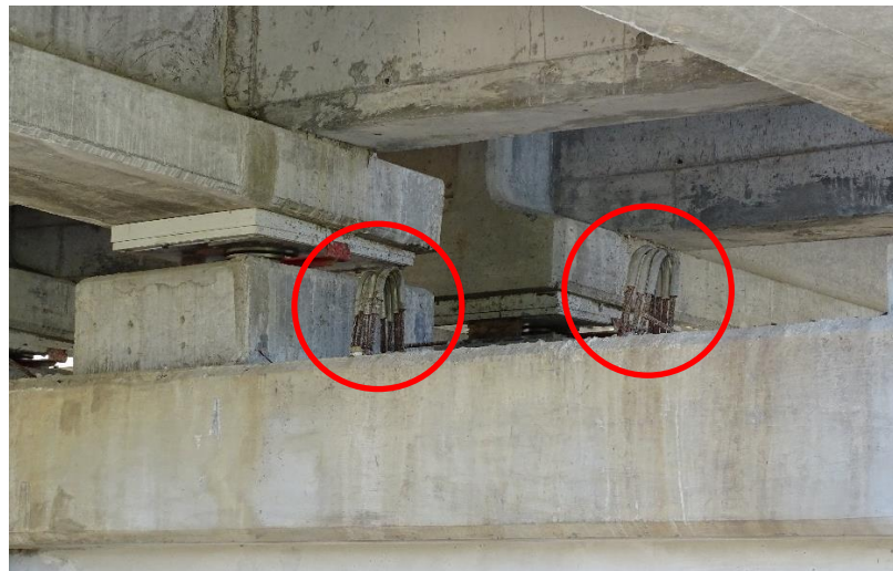
Figura 8. Ganchos para el izaje de la viga cabezal de la pila que aún no han sido removidos.
