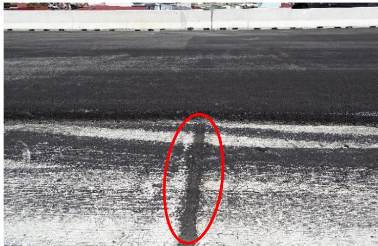
Figura 14. Sello de material flexible colocado en las rótulas de continuidad.
