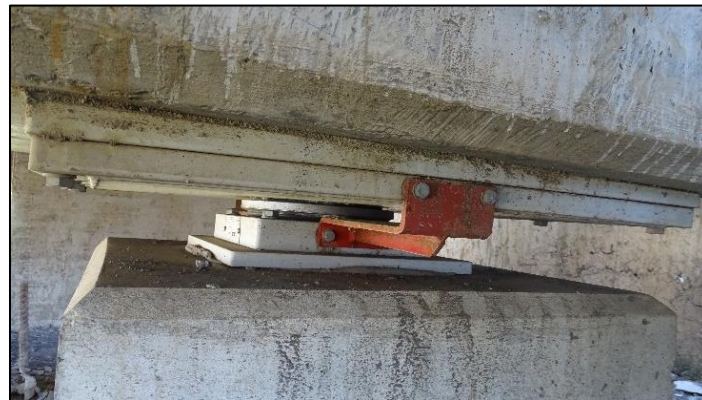
Figura 5. Elemento rígido (color rojo) que une la base del apoyo esférico con la placa superior.
