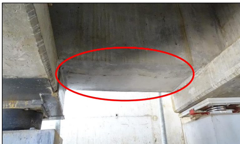
Figura 11. Junta de construcción que permite apreciar el aumento en el espesor del diafragma de bastión de la rampa sur.
