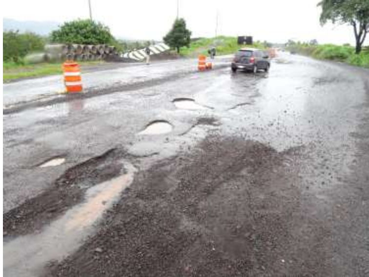
Figura 7. Deterioros en la capa de rueda existente, bajo condiciones lluviosas los baches se llenan con agua y representan riesgo para los usuarios, estacionamiento 1+150 (luego de paso a desnivel de Barrio Socorro). Fecha: 23 de julio de 2021. Fuente LanammeUCR.
