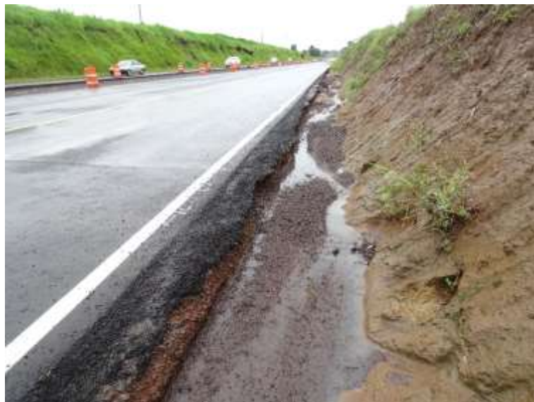
Figura 11. La ausencia de cunetas ha causado erosión en la margen lateral de la carretera afectando la estructura de pavimento recién construida, estacionamiento 1+260. Fecha: 23 de julio de 2021. Fuente LanammeUCR.
