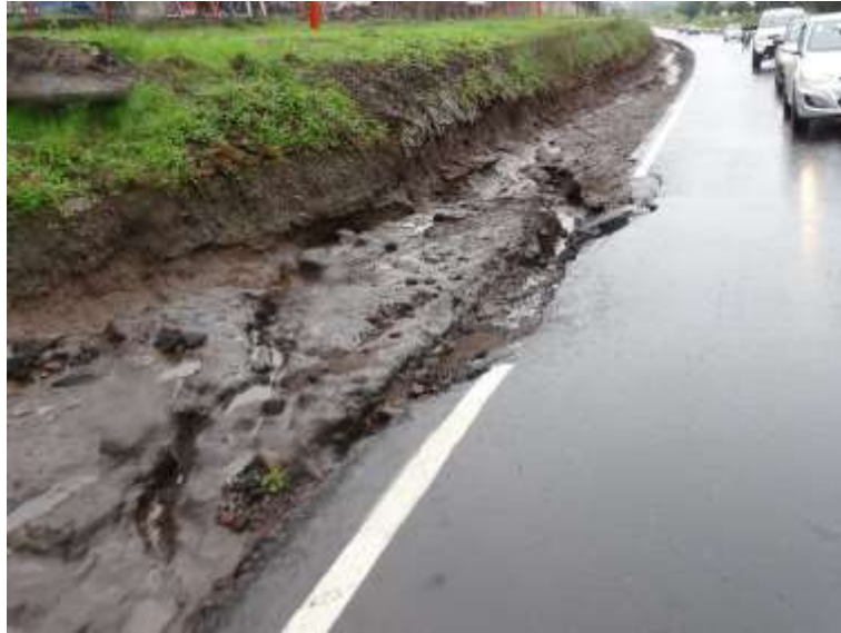
Figura 16. Deterioro en la capa de mezcla asfáltica producto de la socavación de las capas subyacentes y ausencia de confinamiento lateral, estacionamiento 2+360. Fecha: 23 de julio de 2021. Fuente LanammeUCR.
