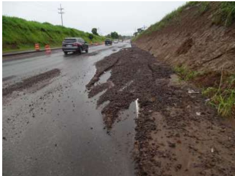
Figura 13. Acumulación de materiales granulares sobre la calzada que se convierte en un riesgo para los usuarios, estacionamiento 1+560. Fecha: 23 de julio de 2021. Fuente LanammeUCR.
