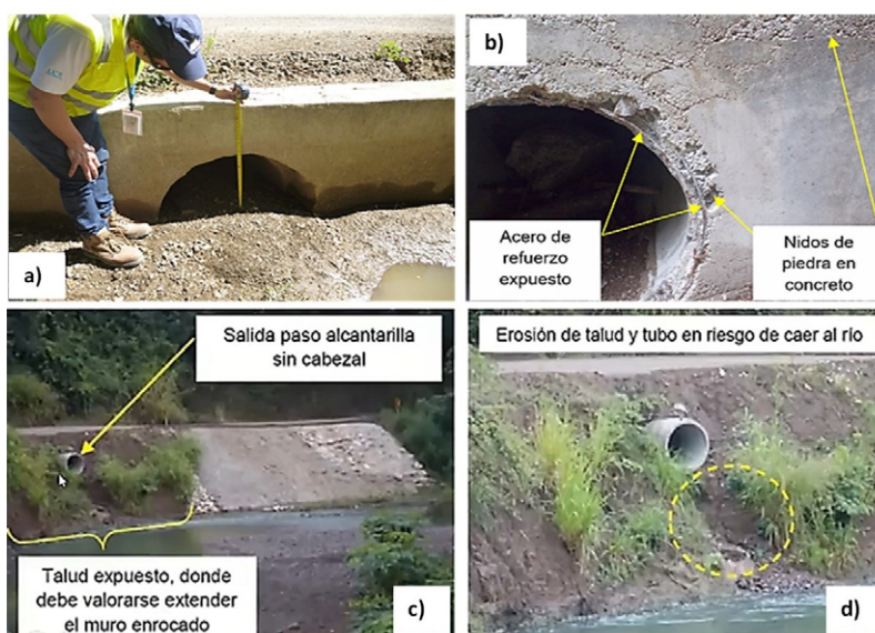
Figura 3. Problemas con el sistema de drenaje: a) Drenajes obstruidos b) Nidos de piedra en concreto y acero de refuerzo expuesto, c) Salida para alcantarilla sin cabezal y taludes expuestos, d) Erosión de talud y tubo en riesgo de caídas a cuerpos de agua
