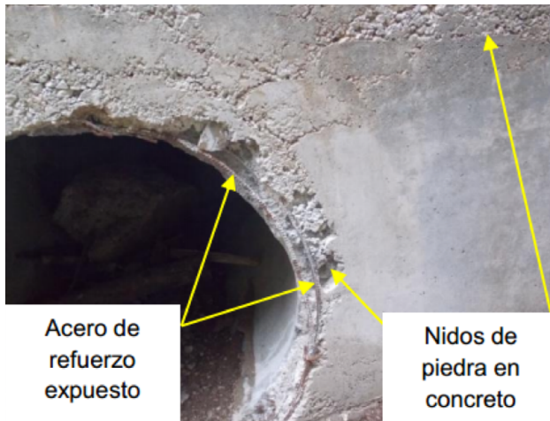
Figura 25. Cabezal de entrada en paso de alcantarilla donde se observa acero expuesto y nidos de piedra (“hormigueros”) en el concreto Fuente: LanammeUCR, 2018
