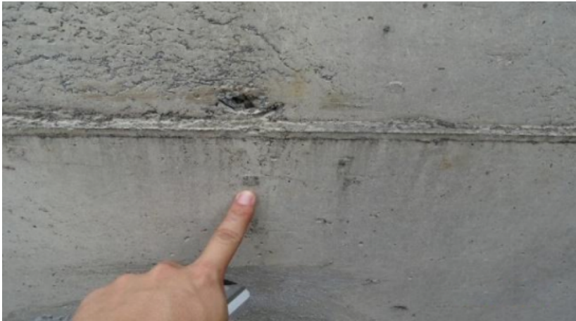
Figura 14. Desprendimiento de agregado y varilla utilizada como separador en capa superficial de concreto Fuente: LanammeUCR, 2019
