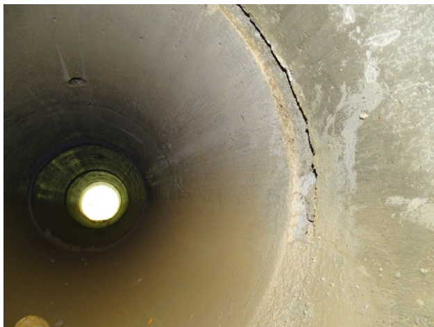
Figura 19. Tubería con cubrimiento deficiente de mortero en juntas (solaqueo deficiente)
