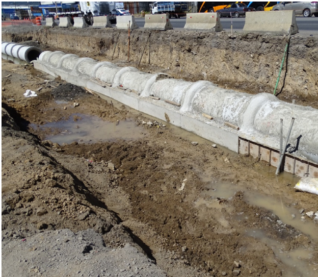
Figura 18. Tubería con un adecuado solaqueo externo
