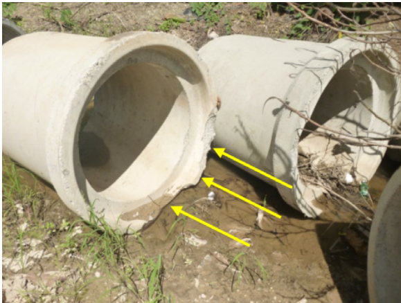
Figura 6. Tubería de concreto para paso de alcantarilla con quebraduras en campana y acero de refuerzo expuesto Fuente: Lanamme, 2016
