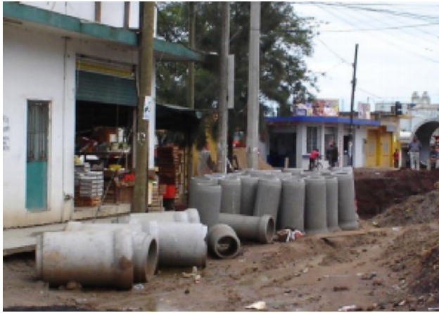
Figura 21. Forma incorrecta de almacenar los tubos Fuente: ATCO, 2012
