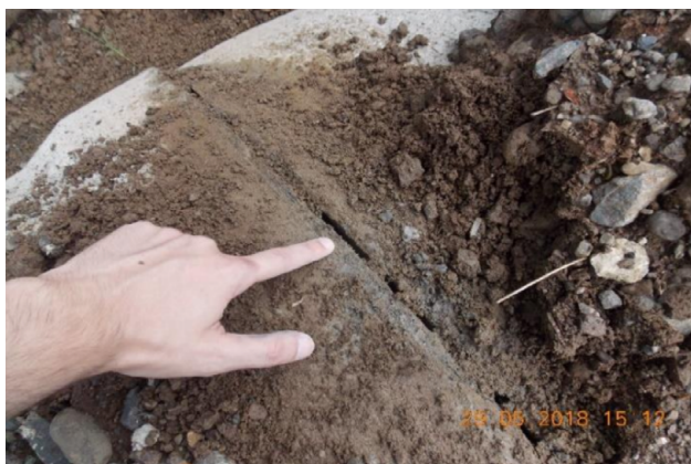
Figura 20. Unión externa sin sellar entre tuberías de concreto (solaqueo deficiente)
