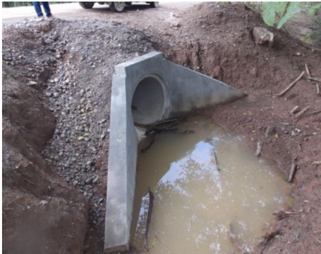
Figura 24. Cabezal de salida CA-2 sin delantal de protección donde se genera erosión Fuente: LanammeUCR, 2018
