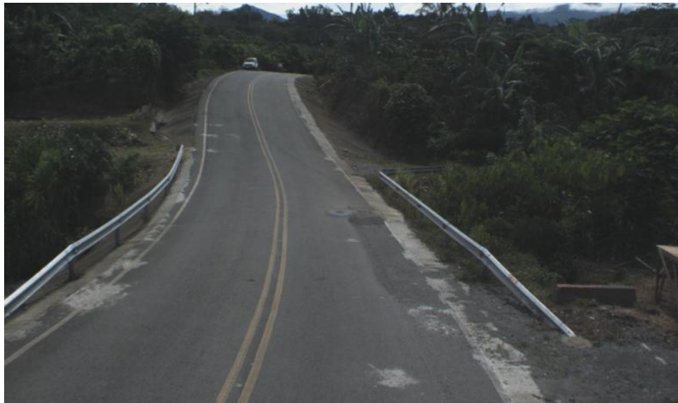
Figura 14: Guardavías cortos usados como barandas de puente, estacionamiento 24+500
