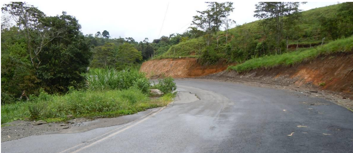
Figura 7: Vista hacia atrás del deslizamiento en el terraplén, estacionamiento 15+700. A la derecha, la “ampliación” del trazado para permitir el paso por el sitio.
