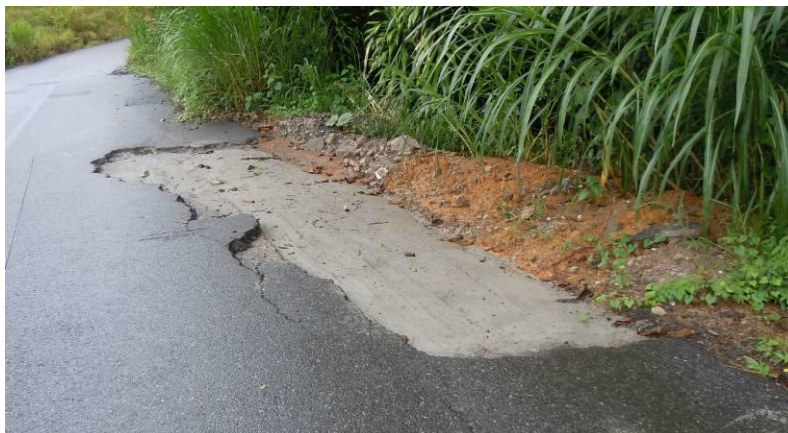
Figura 13: Fallo de la superficie pavimentada por alcantarilla, estacionamiento 12+300
