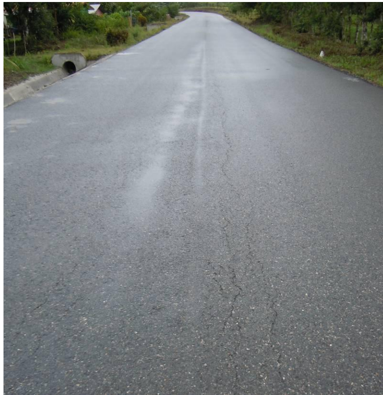
Figura 2: Grieta longitudinal, estacionamiento 11+200
