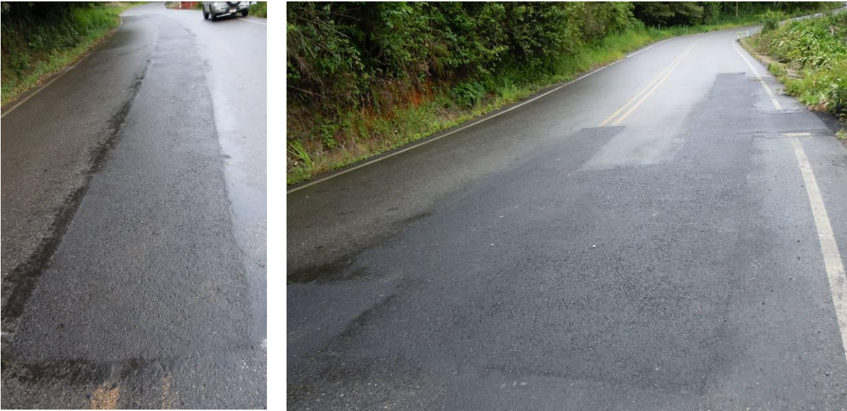
Figura 3: Bacheos en los estacionamientos 13+980 y 14+050
