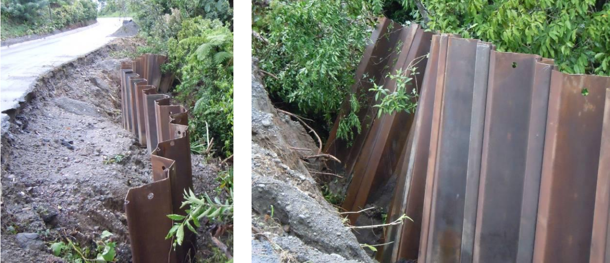
Figura 8: Falla en la tablaestaca, estacionamiento 16+500
