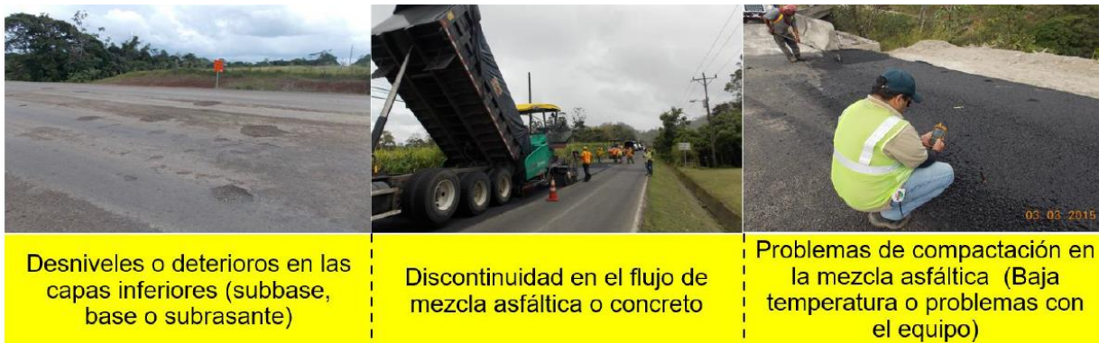
Figura 8. Ejemplos de fallas constructivas que pueden afectar la regularidad superficial de un proyecto
