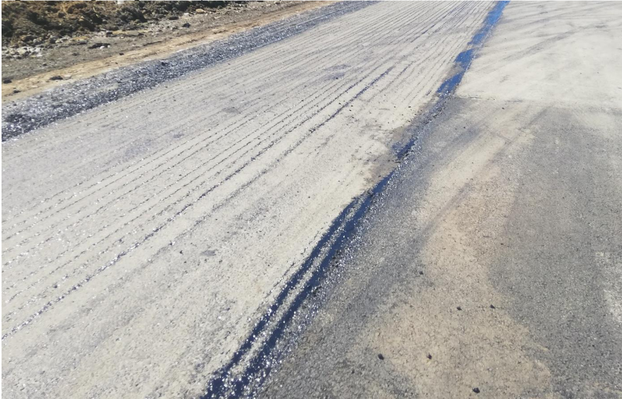
Figura 20. Riego de liga escaso (casi ausente). Estacionamiento: 36+450. Fecha: 16 de enero de 2020
