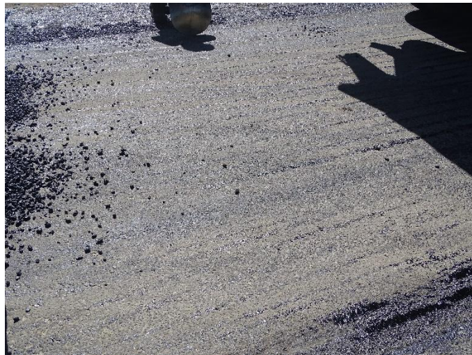
Figura 22. Cobertura del riego de liga sobre el cual se estaba colocando la mezcla a la llegada del Equipo Auditor. Estacionamiento: 36+450. Fecha: 16 de enero de 2020
