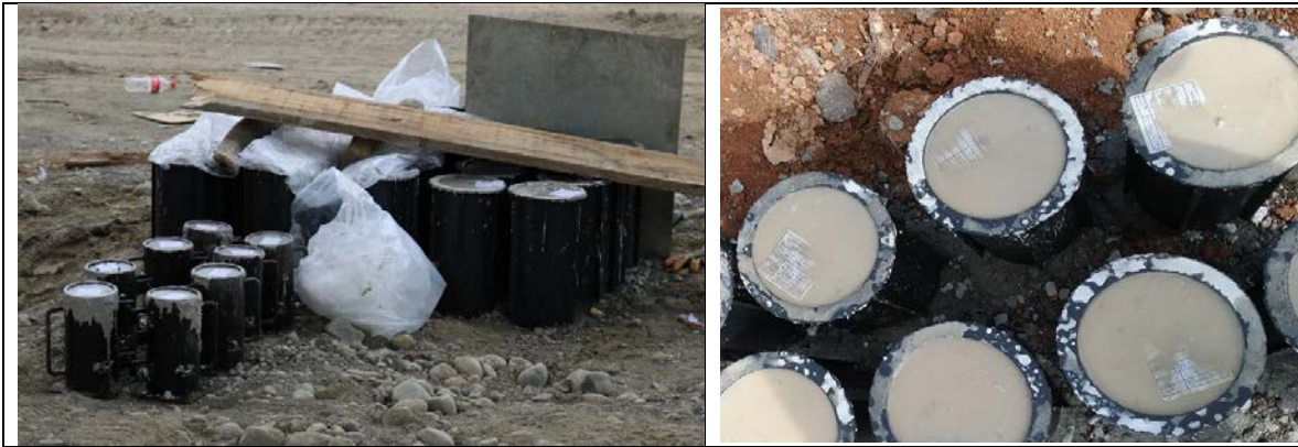
Figura 15. Especímenes de concreto sin protección en el puente sobre el río Chirripó, se evidenció segregación en los especímenes, km 125+309. Fecha de la fotografía 24-01-2019.
