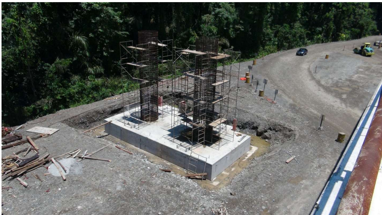
Figura 4. Colocación del encofrado de las columnas de una pila del Viaducto Este
