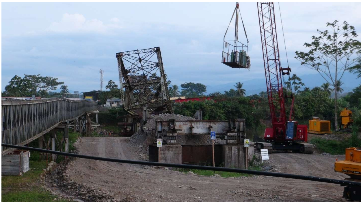
Figura 12. Vista del puente en el sentido Sur. Es evidente que el colapso del puente pudo haber causado el colapso del puente modular contiguo.
