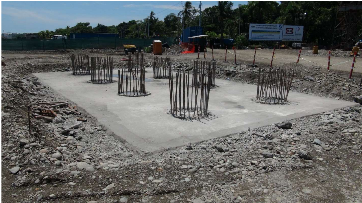
Figura 1. Vista de acero de refuerzo de los pilotes de una pila del Viaducto Este.
