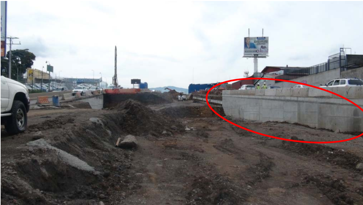
Figura 14. El acabado de la superficie de los muros de concreto no es de buena calidad.
