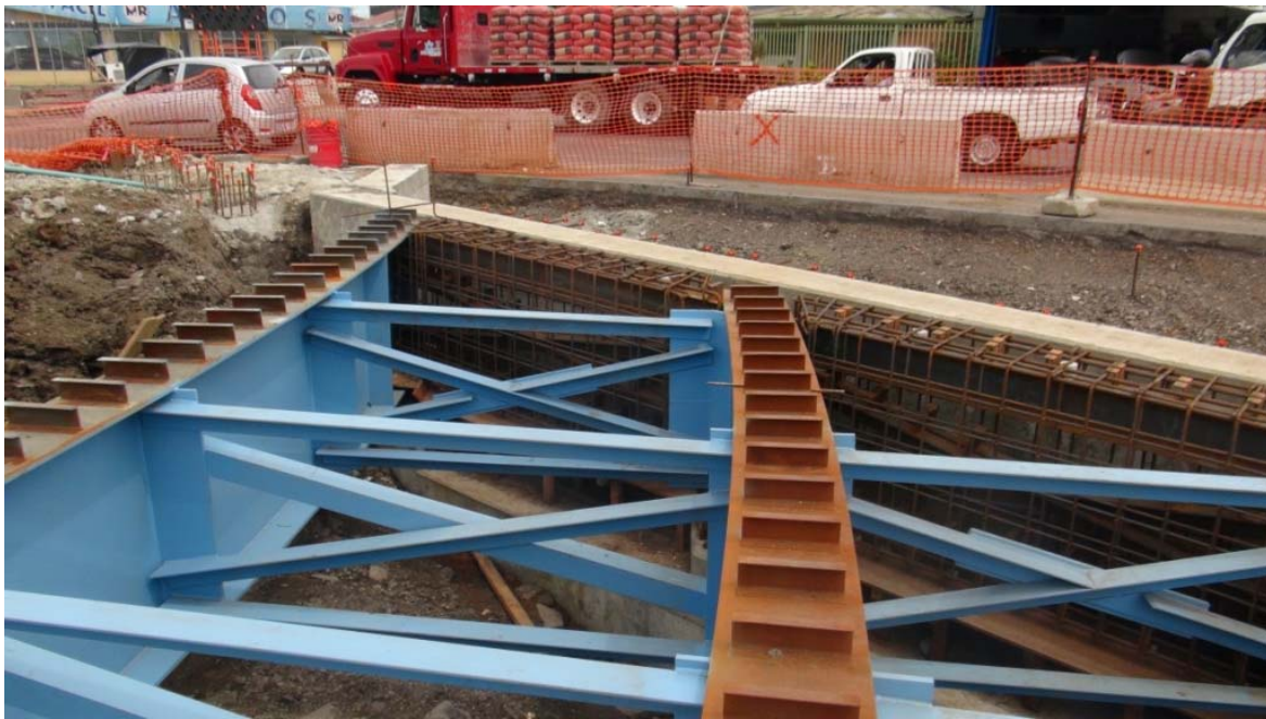
Figura 10. Marcos arriostrado intermedios y confinamiento con acero de refuerzo del marco arriostrado del puente Oeste ubicado en el extremo norte.
