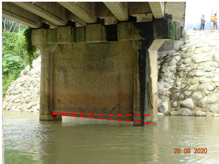
Figura 1.2. Vista de la pila n.º 2 donde se observa el asentamiento de la columna aguas-abajo.
