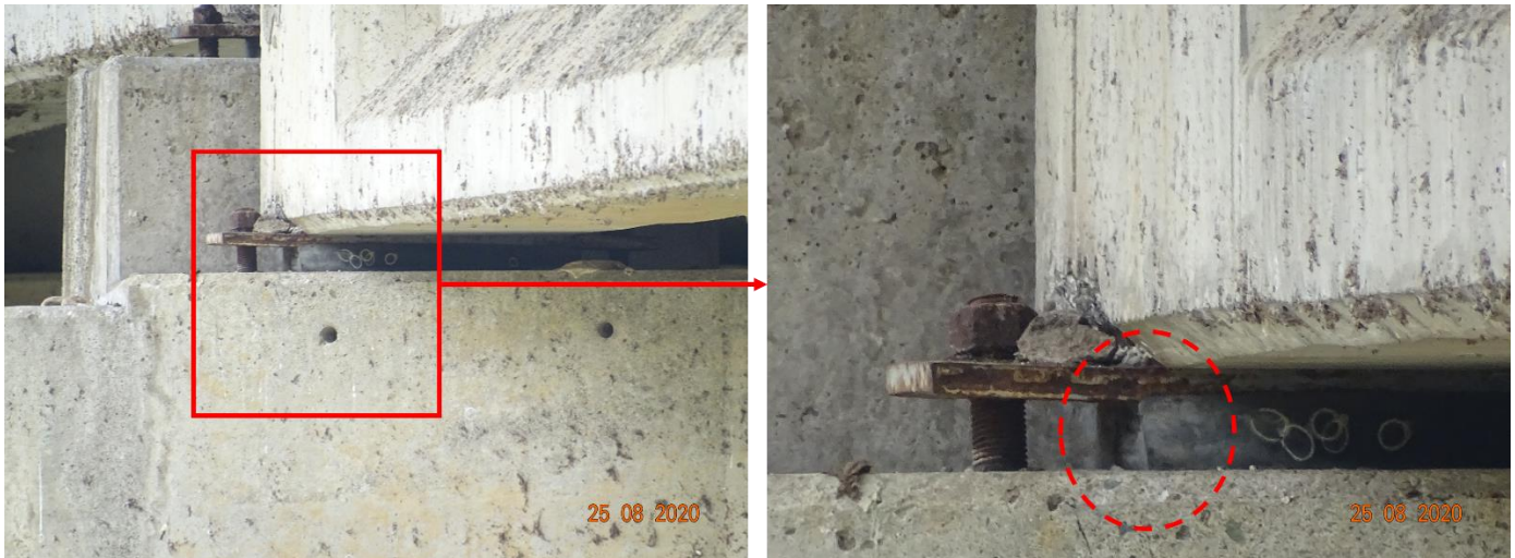
Figura 2.4. Deformación en los apoyos de la superestructura n°. 2 sobre la pila n°. 1.
