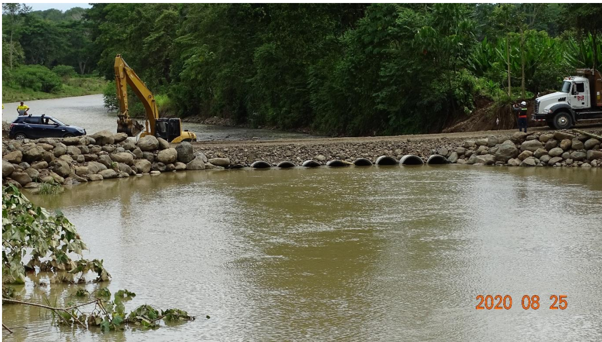
Figura 2.1. Vado para el paso temporal de vehículos observado durante la inspección.
