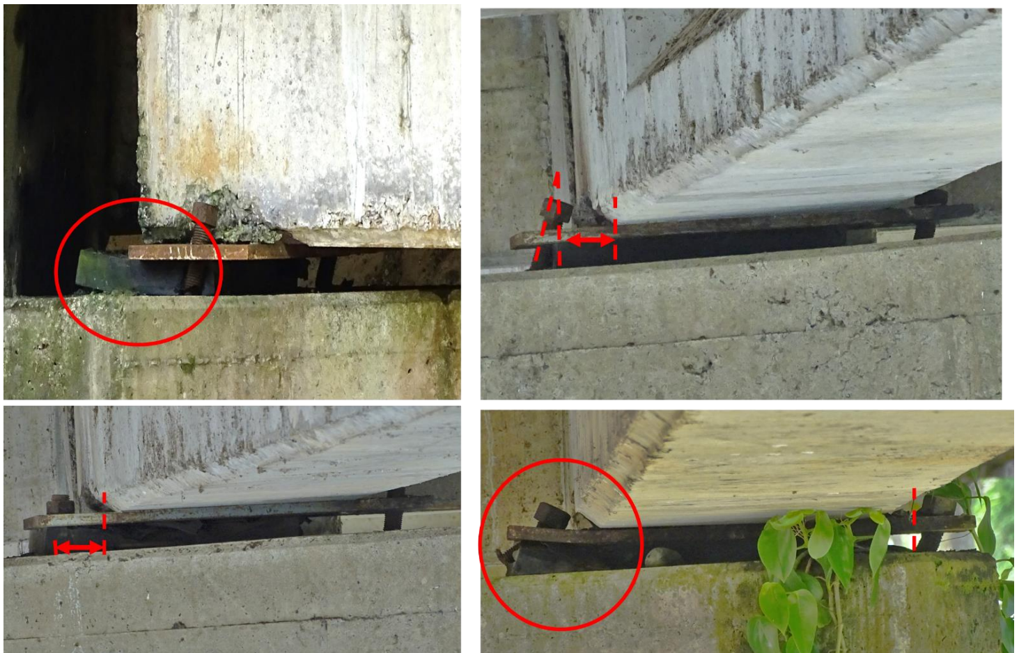
Figura 2.1. Deformación y rotura de pernos observada en apoyos de la superestructura n°. 3 sobre la pila n°. 2
