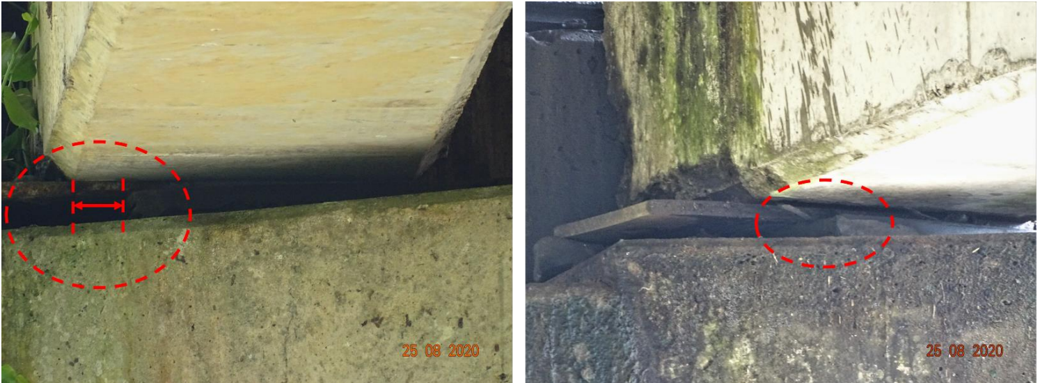
Figura 2.2. Deformación observada en apoyos de la superestructura n°. 2 sobre la pila n°. 2
