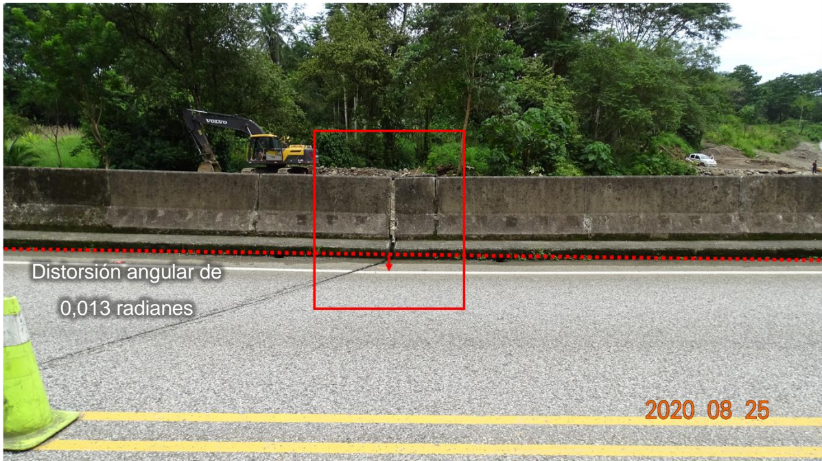
Figura 1.1. Asentamiento de la superficie de rodamiento del puente en la junta de expansión entre las superestructuras n.º 2 y n.º 3 (sobre la pila n.º 2).
