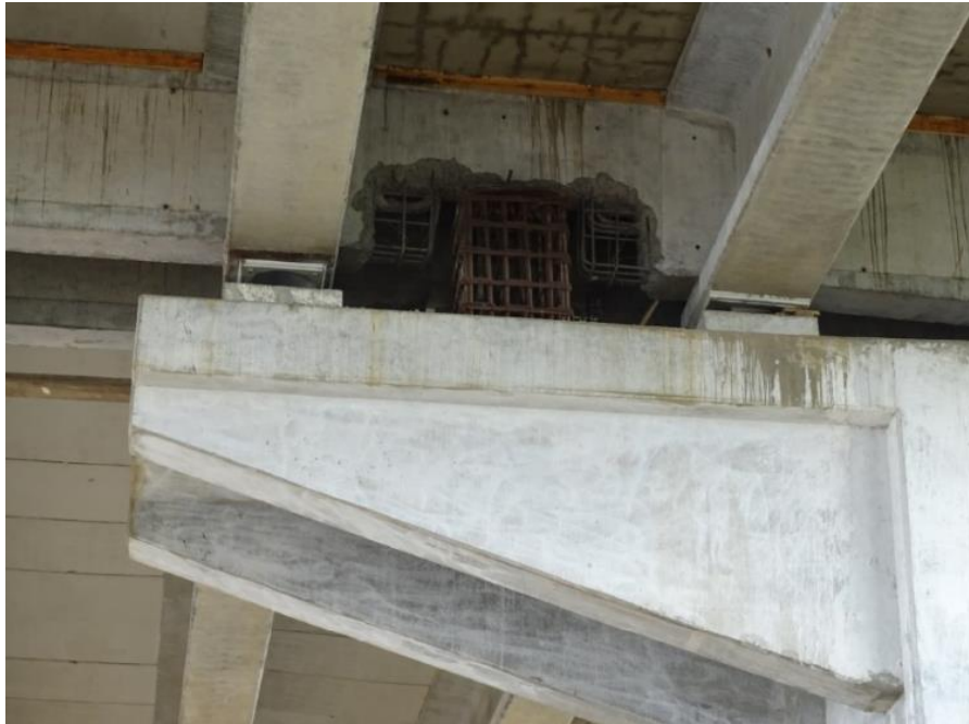
Fotografía 23: Condición de acero expuesto del tope sísmico de la pila 9 del viaducto. Unidad Funcional 3. Fecha: 18 de mayo de 2020. Fuente: LanammeUCR.
