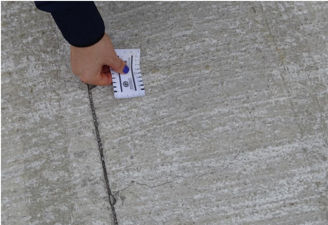
Fotografía 6: Agrietamiento de concreto de uniones de losa prefabricada. Junta de Tablero 23. Viaducto Unidad Funcional 3. Fecha: 5 de mayo de 2020. Fuente: LanammeUCR.
