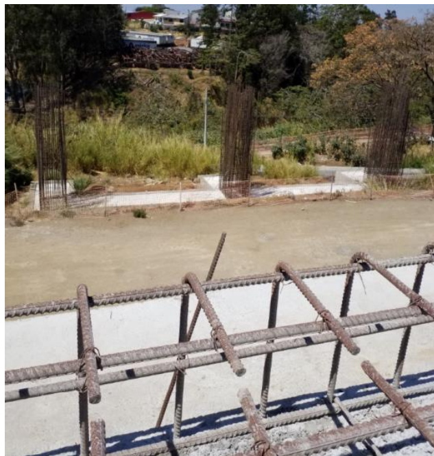
Fotografía 16: Acero expuesto del puente sobre Quebrada Rivera en la Unidad Funcional 2A, específicamente en el bastión Este y columnas de pila. Fecha: 21 de febrero de 2019. Fuente: LanammeUCR.
