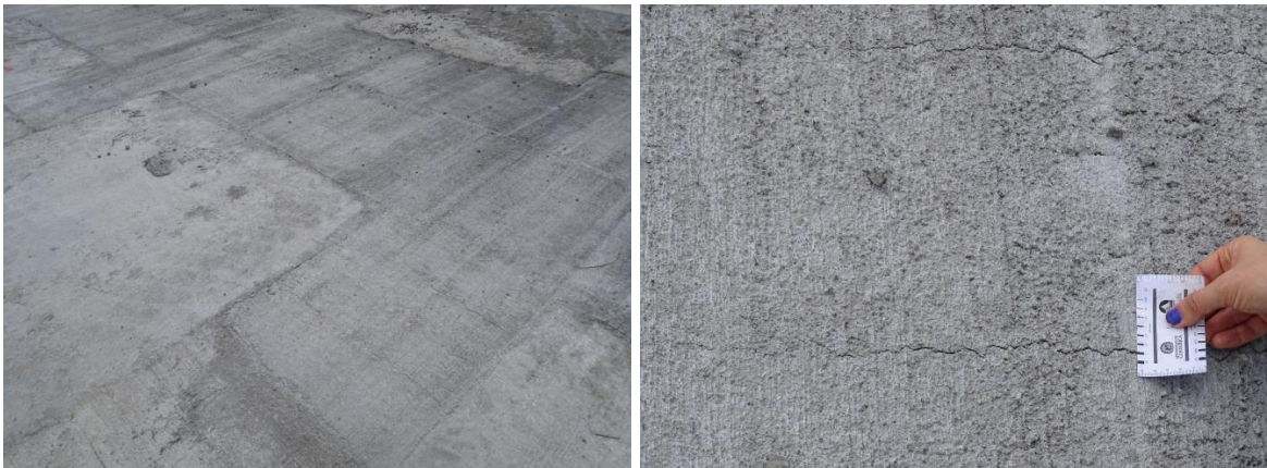
Fotografía 5: Agrietamiento de concreto en uniones de losa prefabricada hasta de 2mm. Junta de Tableros 3 y 4. Viaducto Unidad Funcional 3. Fecha: 5 de mayo de 2020. Fuente: LanammeUCR.
