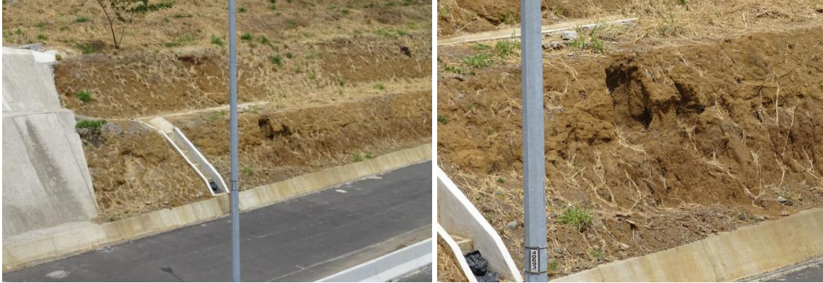
Fotografía 34: Erosión en talud Este al lado de la Radial a Heredia. Fecha: 15 de abril de 2020. Fuente: LanammeUCR
