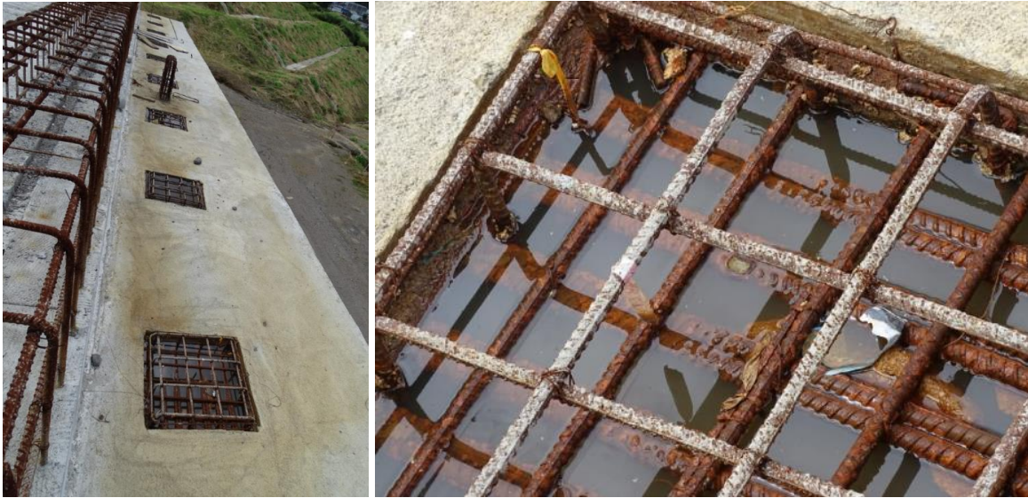
Fotografía 17: Acero sumergido en agua acumulada en el bastión Este del puente sobre Quebrada Rivera en la Unidad Funcional 2A. Fecha: 3 de diciembre de 2019. Fuente: LanammeUCR.
