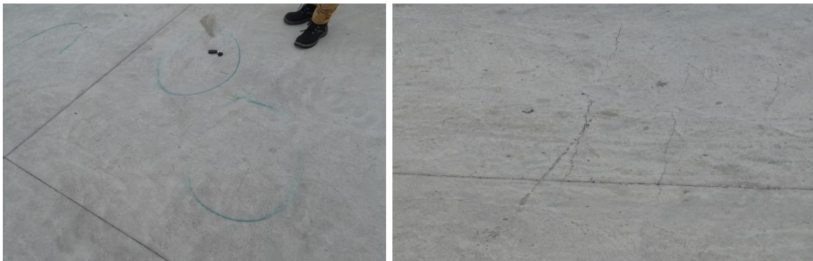
Fotografía 10: Agrietamiento en losa colada en sitio correspondiente al tablero No.8 del Viaducto Unidad Funcional 3. Fecha: 18 de mayo de 2020. Fuente: LanammeUCR.
