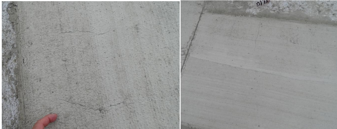
Fotografía 2: Agrietamiento de concreto de uniones de losa prefabricada. Tablero 42. Viaducto Unidad Funcional 4. Fecha 15 de abril de 2020. Fuente: LanammeUCR.
