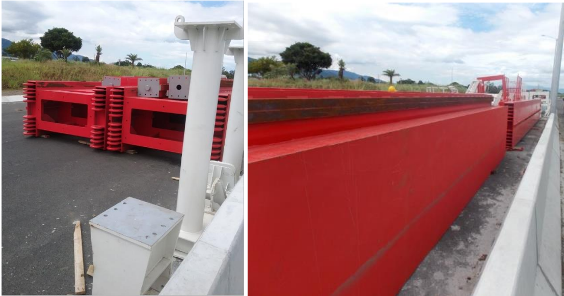
Fotografía 24: Almacenamiento de lanzadora de vigas. Estacionamiento aproximado: 1+350. Fecha: 15 de noviembre de 2018. Fuente: LanammeUCR.
