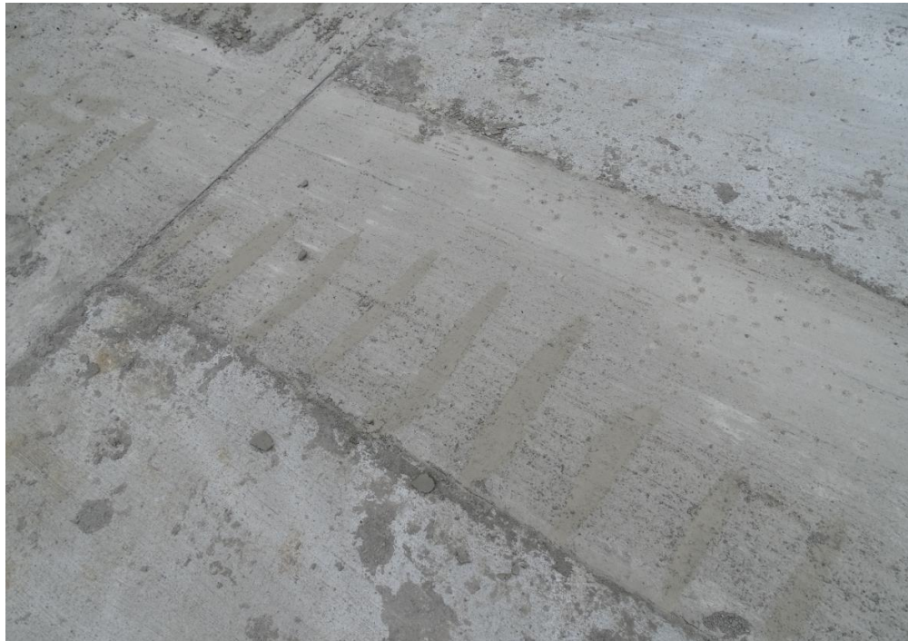
Fotografía 3: Aparente reparación de agrietamiento del concreto de las uniones de losa prefabricada. Tablero 42. Viaducto Unidad Funcional 4. Fecha 15 de abril de 2020. Fuente: LanammeUCR, LM-IC-D-368-2020.
