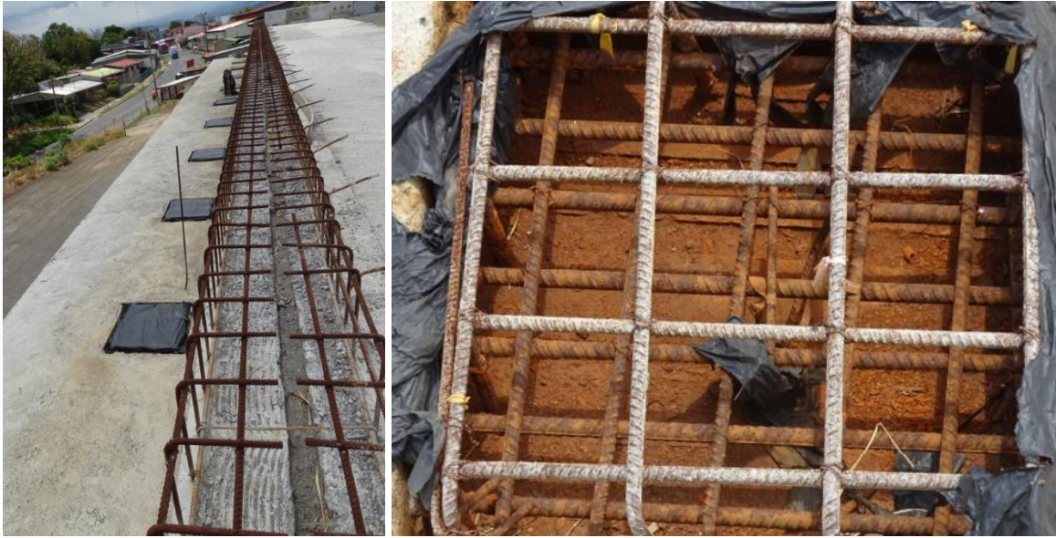
Fotografía 20: Condición de bastión Este del Puente de la Quebrada Rivera aproximadamente 14 meses después de construido. Unidad Funcional 2A. Fecha: 15 de abril de 2020. Fuente: LanammeUCR.
