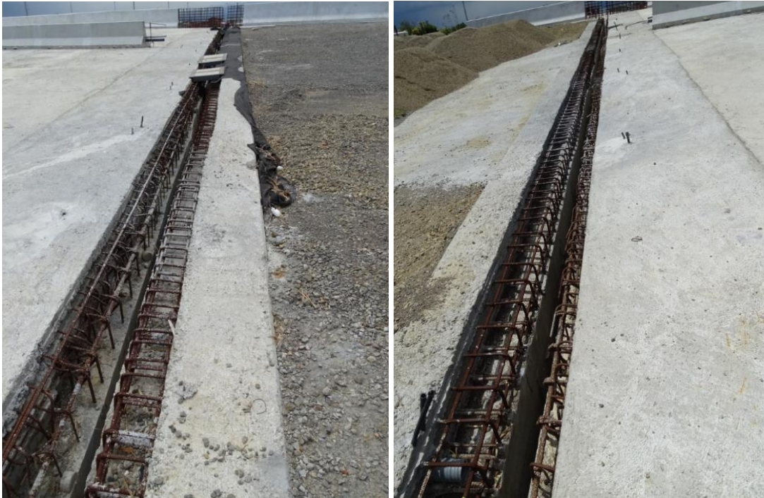
Fotografía 22: Condición igual de las juntas en los bastiones y parte de las barreras de contención lateral del puente sobre la Radial a Heredia hasta abril de 2020. Unidad Funcional 2B. Fecha: 15 de abril de 2020. Fuente: LanammeUCR.
