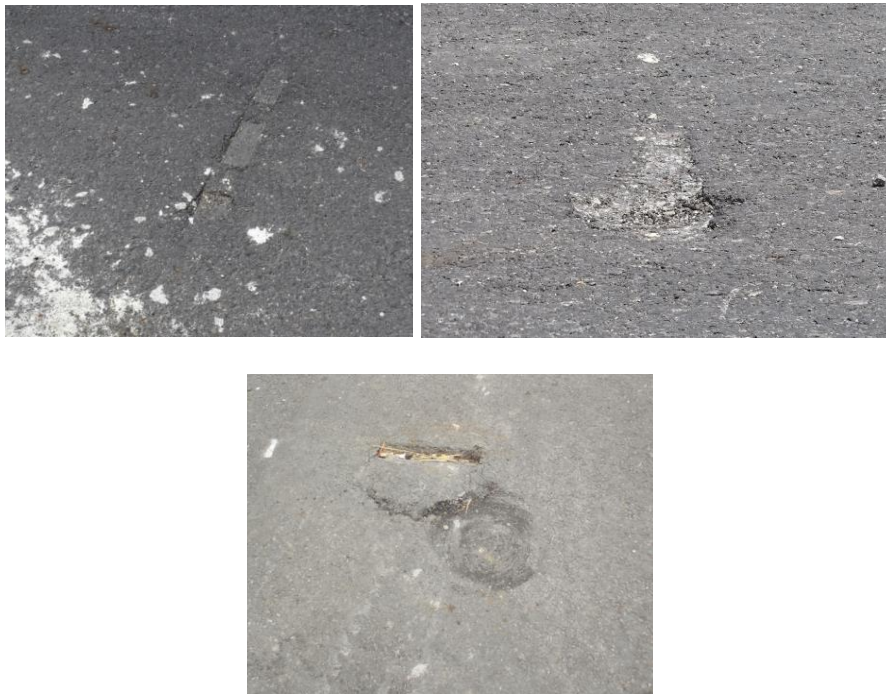
Fotografía 30: Deterioros superficiales de la capa asfáltica colocada en el tramo principal de la Unidad Funcional 2B. Estacionamiento aproximado: 1+400 a 1+550. Fecha: 15 de abril de 2020 y 25 de abril de 2019. Fuente: LanammeUCR.
