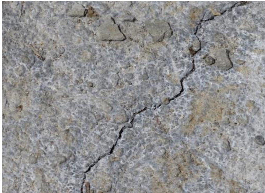
Fotografía 4: Agrietamiento de concreto de uniones de losa prefabricada. Tablero 14. Viaducto Unidad Funcional 3. Fecha: 2 de octubre de 2019. Fuente: LanammeUCR, LM-IC-D-368-2020.
