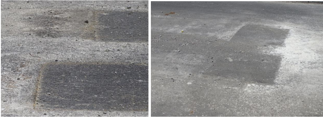
Fotografía 29: Marcas formadas en la capa asfáltica por apoyos sobre los que se colocaron vigas. Unidad Funcional 2B. Estacionamiento aproximado: 1+450. Fecha: 15 de abril de 2020. Fuente: LanammeUCR.
