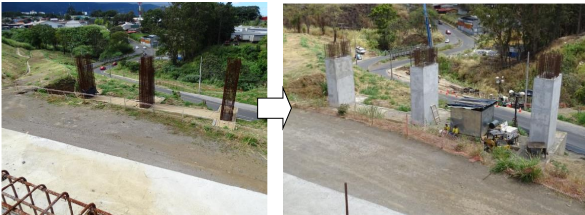
Fotografía 21: Condición de columnas de pila del Puente de la Quebrada Rivera. Se nota que se colocó parte del concreto de los elementos, desde febrero de 2020. Unidad Funcional 2A. Fecha: 15 de abril de 2020. Fuente: LanammeUCR.
