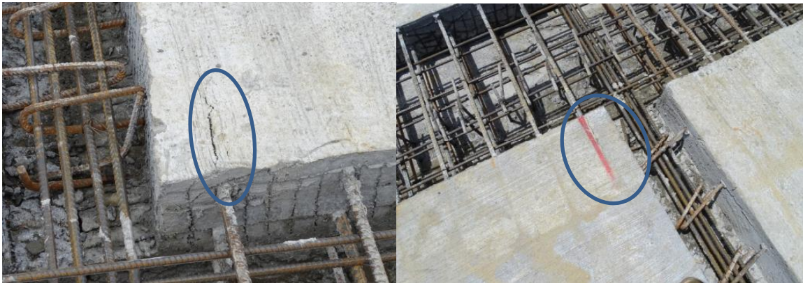
Fotografía 12: Agrietamiento en bordes de losas prefabricadas. Tablero 15, Viaducto Unidad Funcional 3. Fecha 4 de octubre de 2019. Fuente: LanammeUCR. Nota informe LM-IC-D-839-19.
