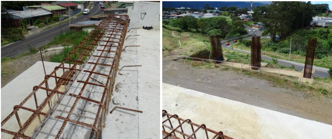
Fotografía 18: Las estructuras del puente sobre Quebrada Rivera continuaban hasta diciembre de 2019 en las mismas condiciones de exposición de 10 meses atrás. Unidad Funcional 2A. Fecha: 3 de diciembre de 2019. Fuente: LanammeUCR.
