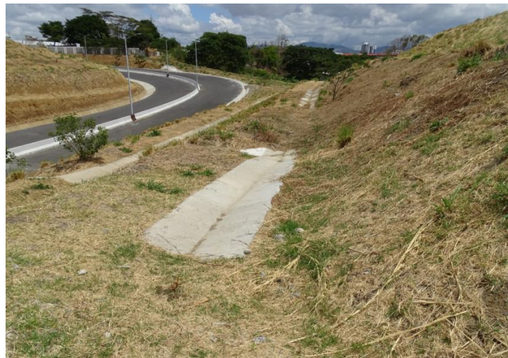
Fotografía 33: Erosión en talud del relleno construido al lado de la Radial a Heredia. Se observa obstrucción en contracunetas. Fecha: 15 de abril de 2020. Fuente: LanammeUCR
