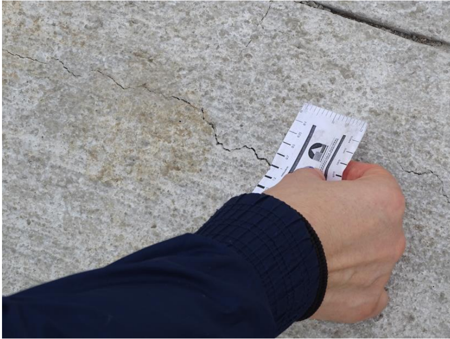
Fotografía 8: Agrietamiento del concreto de uniones de la losa prefabricada. Junta de Tablero 28. Viaducto Unidad Funcional 3. Fecha: 5 de mayo de 2020. Fuente: LanammeUCR.
