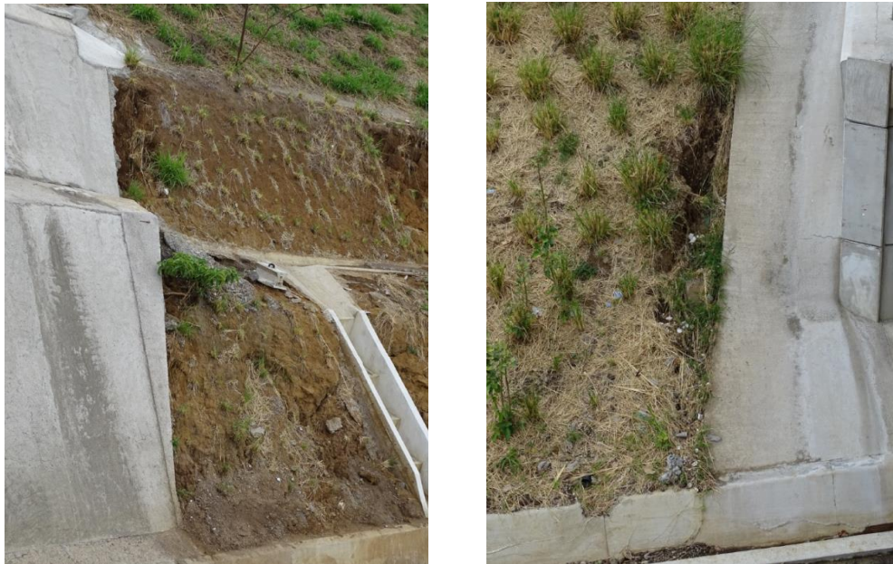
Fotografía 35: Erosión en talud al lado de los bastiones este y oeste de Puente sobre radial Heredia. Fecha 28 de abril 2020.
