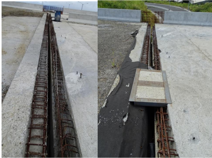
Fotografía 19: Acero continúa expuesto en las juntas en los bastiones del puente sobre la Radial a Heredia hasta diciembre de 2019. Se observa parte del acero también expuesto de la barrera de contención lateral. Unidad Funcional 2B. Fecha: 3 de diciembre de 2019. Fuente: LanammeUCR.
