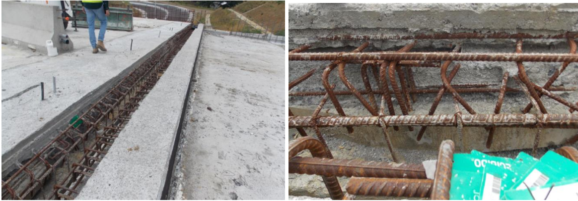
Fotografía 15: Acero expuesto del puente sobre la Radial a Heredia. Unidad Funcional 2B. Fecha: 25 de abril de 2019. Fuente: LanammeUCR
