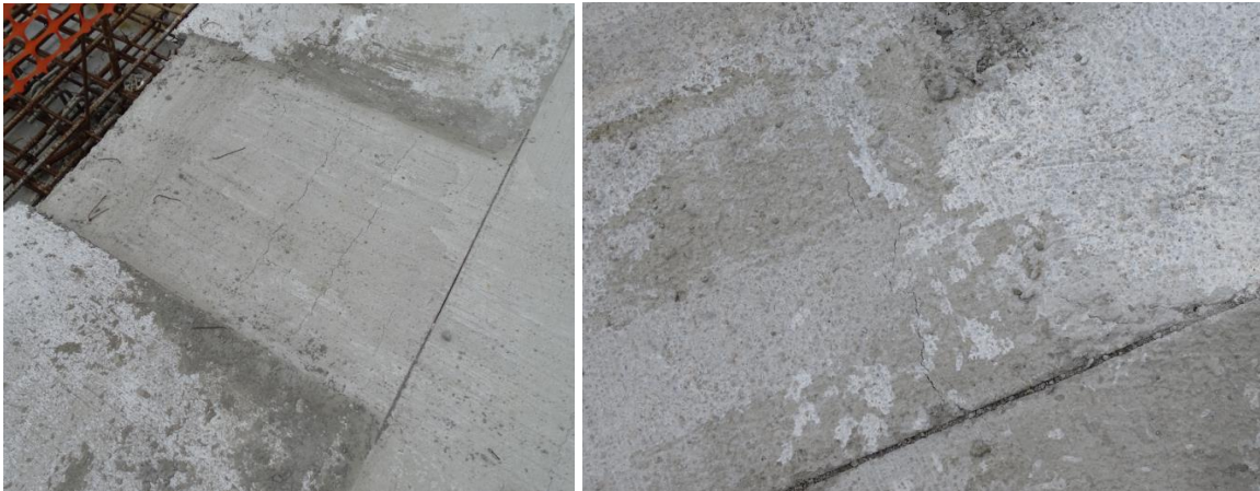
Fotografía 1: Agrietamiento del concreto de uniones en losa prefabricada. Tablero 43. Viaducto Unidad Funcional 4. Fecha 15 de abril de 2020. Fuente: LanammeUCR, LM-IC-D-368-2020.
