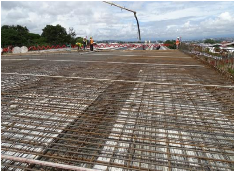
Fotografía 13: La colocación del concreto del Tablero 9 se canceló por parte de la Supervisión a las 10am. Tablero 9, Viaducto Unidad Funcional 3. Fecha 2 de octubre de 2019. Fuente: LanammeUCR.
