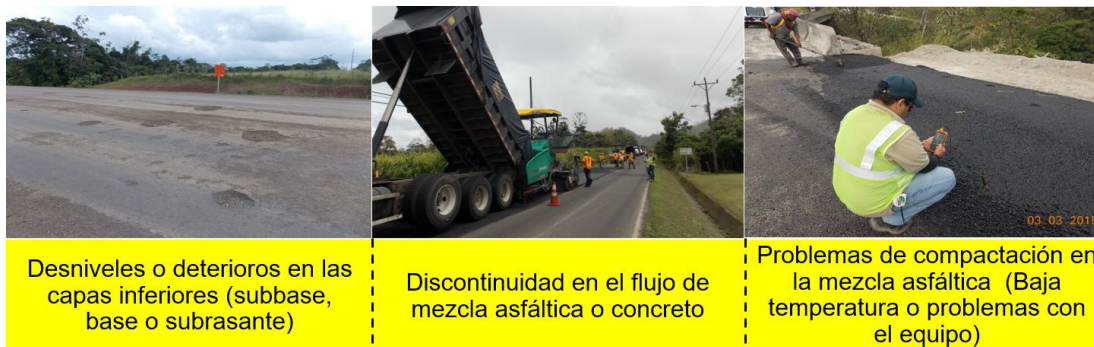
Figura 4. Ejemplos de fallas constructivas que pueden afectar la regularidad superficial de un proyecto.
