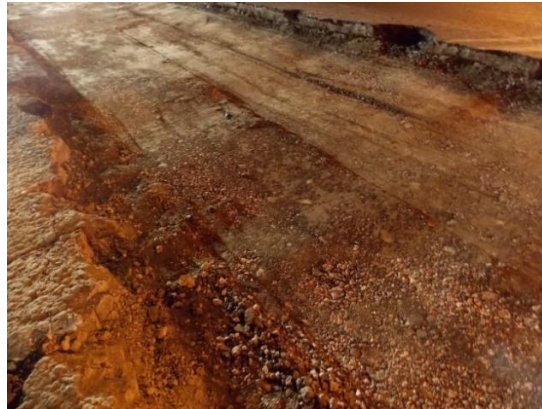
Figura 8. El material de subbase existente se observa segregado, suelto y no se conforma. Estacionamiento 0+700 del paso a desnivel. Fecha: 13 de marzo 2019. Fuente LanammeUCR
