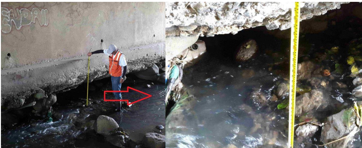
Figura 2.13. Socavación grado 5 en bastión del puente sobre el río Toyogres, RN 10, calificado de acuerdo con el criterio propuesto en el cuadro 2.7 y con 5 en el SAEP (Fotografía del SAEP, MOPT, 2019).
