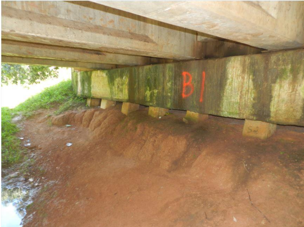
Figura 2.12. Socavación grado 3 en el bastión del puente sobre el río Hernández, RN 35, calificado de acuerdo con el criterio propuesto en el cuadro 2.7, pero calificado con 5 en el SAEP (Fotografía del SAEP, MOPT, 2019).
