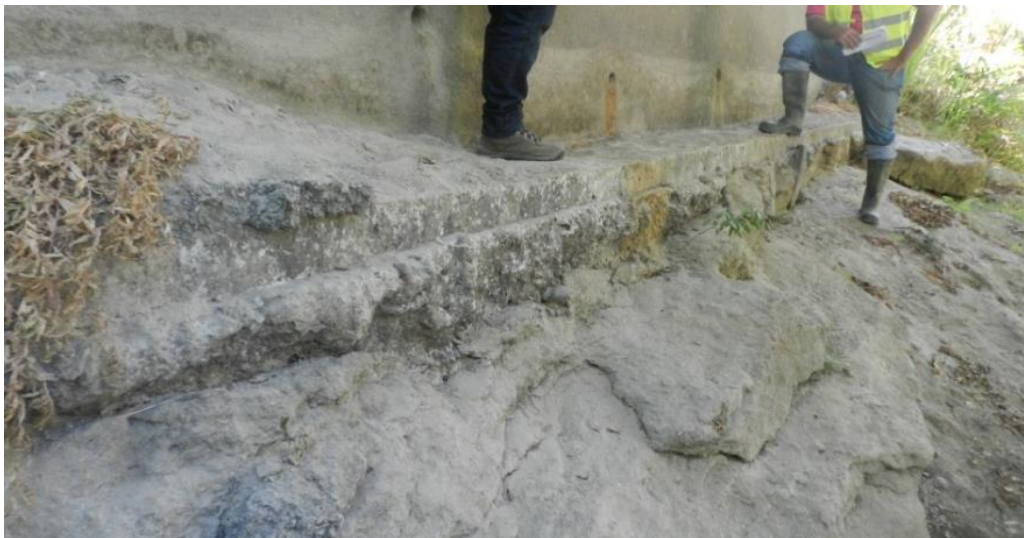
Figura 2.11. Socavación grado 3 en el bastión del puente sobre el río Liberia No. 2, RN 21, calificado de acuerdo con el criterio propuesto en el cuadro 2.7, pero calificado con 5 en el SAEP (Fotografía de MOPT, 2019).
