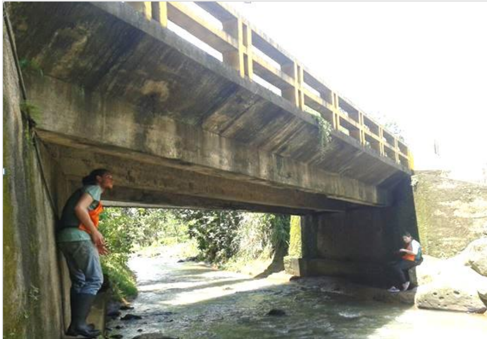
Figura 2.9. Evidencia fotográfica del puente sobre la quebrada Máquina en la Ruta Nacional No.35, el cual fue calificado con un valor de 5 por socavación; sin embargo, es un puente cimentado sobre roca y lo que se observa es el delantal del bastión.
