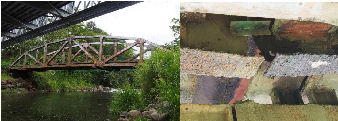
Figura A5.2. Izquierda: Vista lateral del puente sobre el río Arenal en la Ruta Nacional No. 4. Derecha: Condición de fractura (calificación 5) de una de las vigas inferiores de los marcos transversales del puente tipo cercha de media altura (Fotografías del SAEP, MOPT, 2019).
