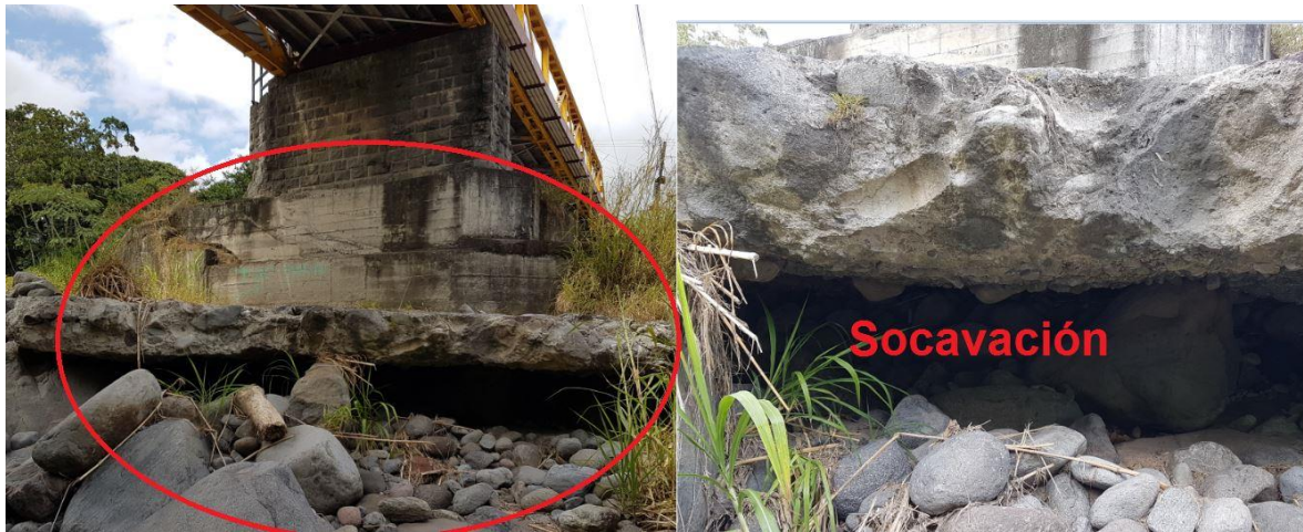
Figura 2.16. Socavación grado 5 en pila del puente sobre el río Turrialba, RN 230, calificado de acuerdo con el criterio propuesto en el cuadro 2.7 y con 5 en el SAEP (Fotografía del SAEP MOPT, 2019)
