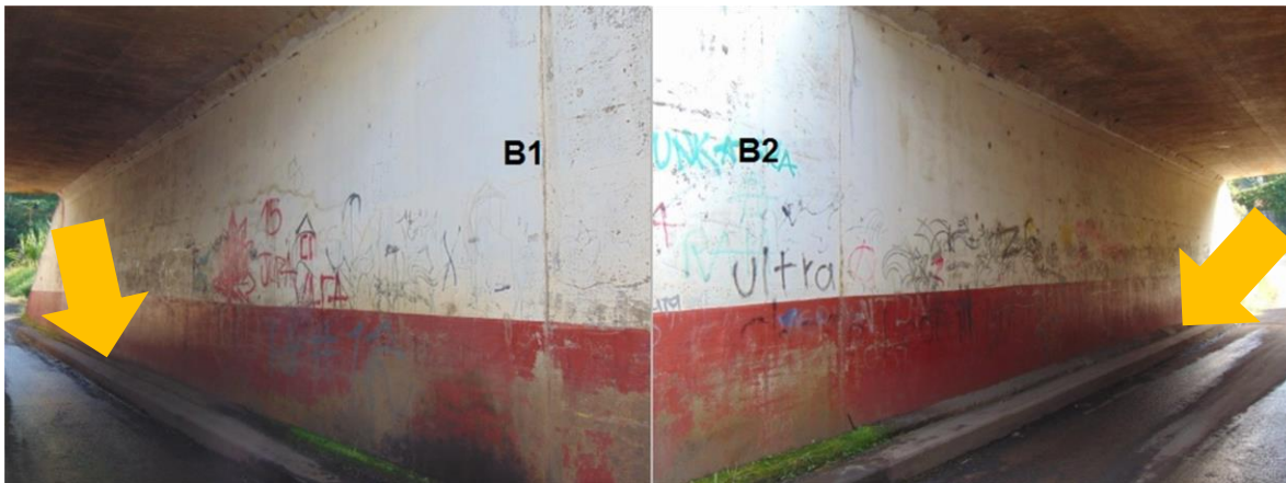
Figura 2.8. Paso superior sobre camino vecinal RN 01 (km 45+606) calificado con socavación grado 5. Nótese el bordillo que aparentemente fue tomado por una placa de fundación (modificado de una fotografía del SAEP, MOPT, 2019).
