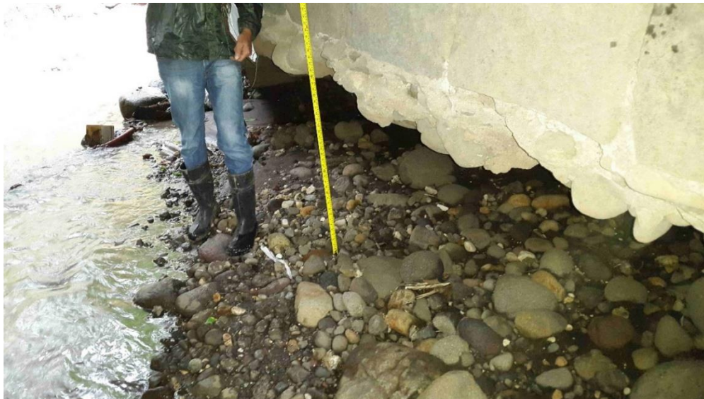
Figura 2.14. Socavación grado 5 en bastión del puente sobre el río Barquero, RN 10, calificado de acuerdo con el criterio propuesto en el cuadro 2.7 y con 5 en el SAEP (Fotografía del SAEP, MOPT, 2019).
