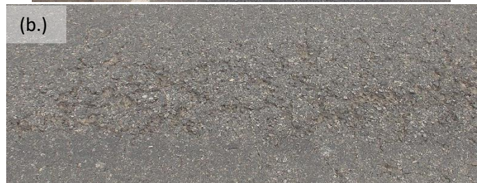
Figura 2.1. Desgaste de la superficie de rodamiento del puente: (a.) se muestra la extensión del daño y (b.) la severidad que es media.
