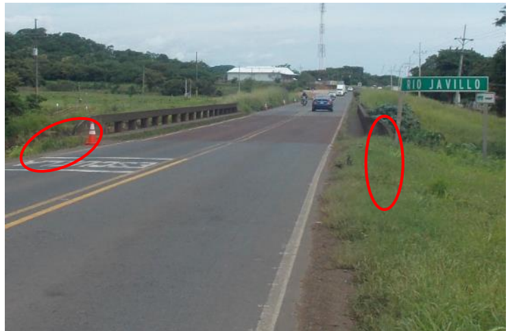
Figura 1.2(a). Ausencia de sistema de contención en los accesos, vista desde acceso 2.
