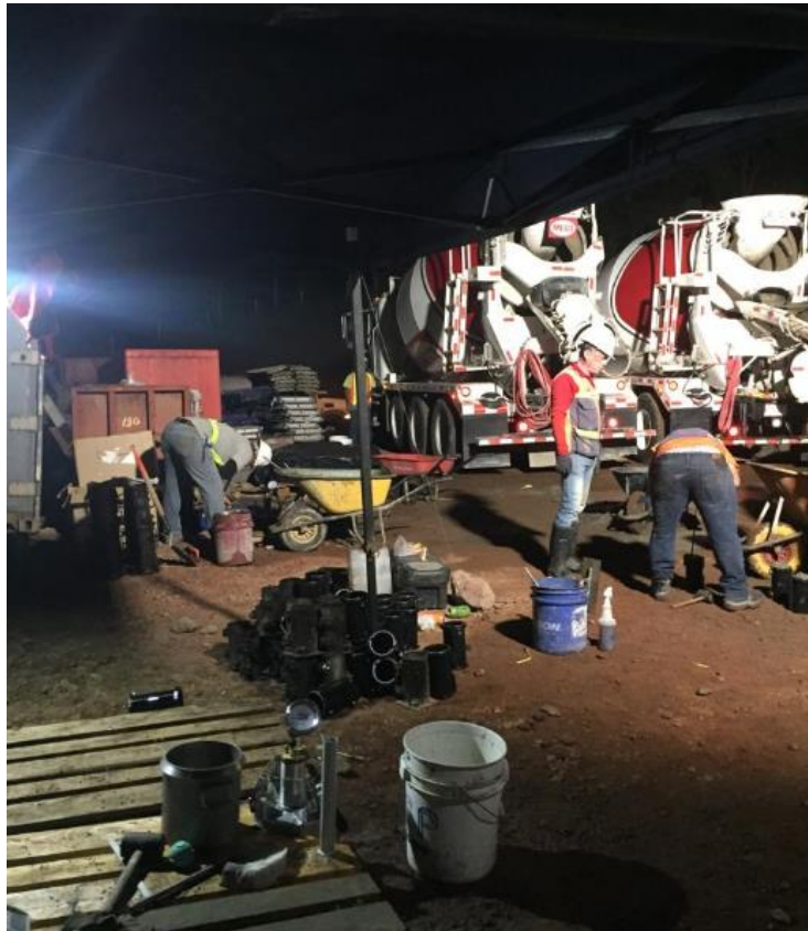
Fotografía 1. Moldeo de cilindros por parte de los laboratorios de autocontrol y verificación de calidad en la primera porción de la amasada. Fecha de la fotografía: 20 de junio de 2019 Fuente: LanammeUCR
