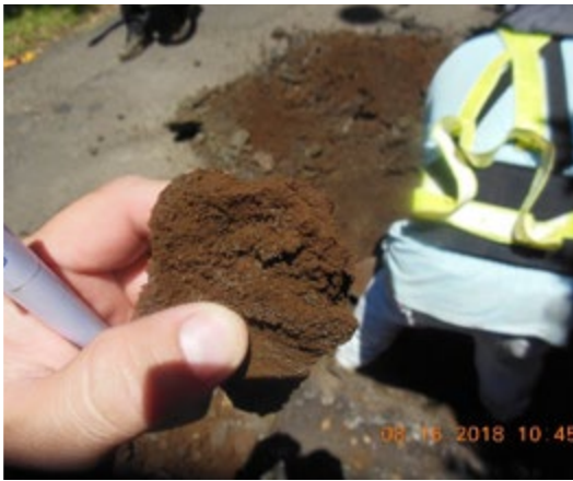
Figura 1: Evaluación de la estructura actual del pavimento para diseñar la intervención requerida en la red vial cantonal
