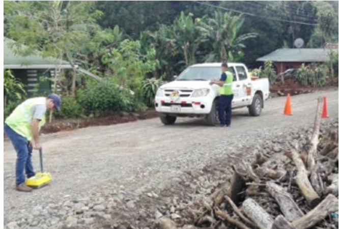
Figura 7: Evaluación de la compactación en sitio mediante el uso del densímetro nuclear en proyectos de la red vial cantonal
