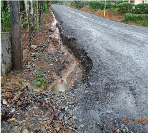
Fotografía 15. Deterioros en bordes, problemas de socavación. Ubicación: Ruta Nacional 334, km 5+350. Sección de control 11050, Angostura (cementerio) - Repunta (RN2). Fecha: 28 de octubre de 2019. Fuente: LanammeUCR
