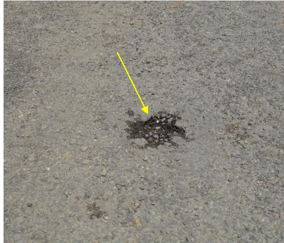
Fotografía 8. Deterioros puntuales de la capa de ruedo, desprendimientos.
