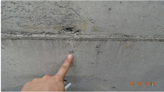
Fotografía 10. Desprendimiento de agregado y varilla utilizada como separador en capa superficial de concreto.
