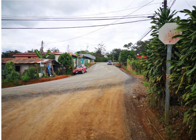
Fotografía 23. Señal de alto en mal estado.
