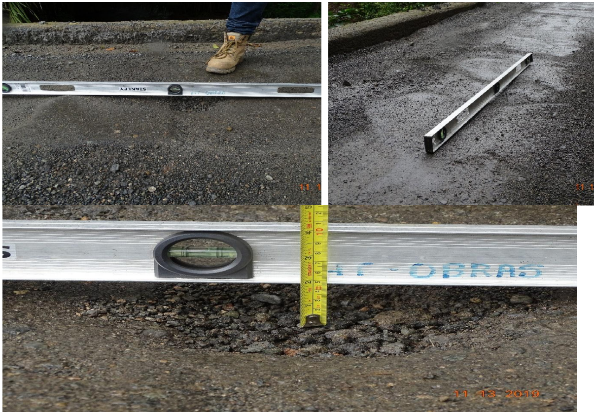
Fotografía 26. Condición de deterioro puente sobre Río Peje, huecos de hasta 5 cm. Ubicación: Ruta Nacional 334, km 7+900. Sección de control 11050, Angostura (cementerio) - Repunta (RN2). Fecha: 13 de noviembre de 2019. Fuente: LanammeUCR
