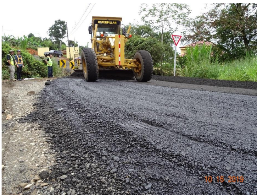
Fotografía 5. Motoniveladora realizando el mezclado del material de perfilado con emulsión asfáltica. Ubicación: Ruta Nacional 334, km 6+400. Sección de control 11043, Ceniza (Cruce Bajo Esperanza, plaza) – Angostura (cementerio). Fecha: 15 de octubre de 2019. Fuente: LanammeUCR.
