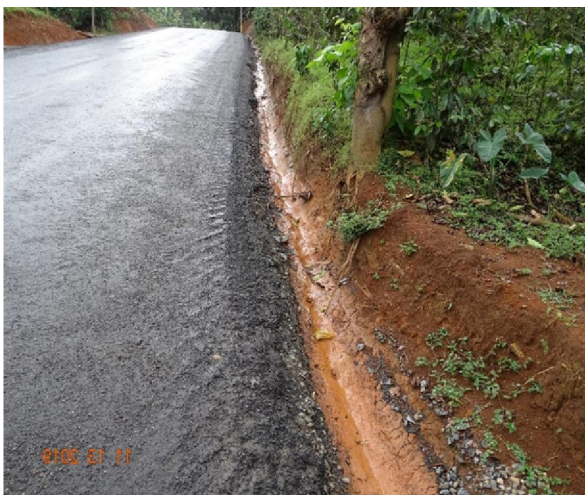
Fotografía 17. Ausencia de cunetas revestidas. Ubicación: Ruta Nacional 334, km 5+200. Sección de control 11050,
