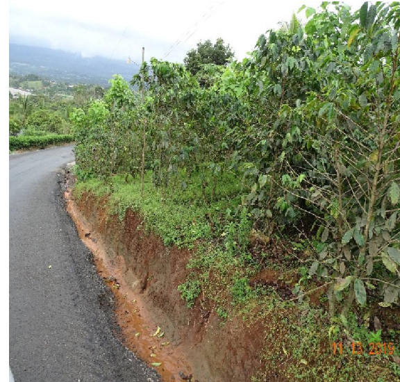
Fotografía 16. Margen derecho sin canal revestido. Ubicación: Ruta Nacional 334, km 5+050. Sección de control 11050, Angostura (cementerio) - Repunta (RN2). Fecha: 13 de noviembre de 2019. Fuente: LanammeUCR
