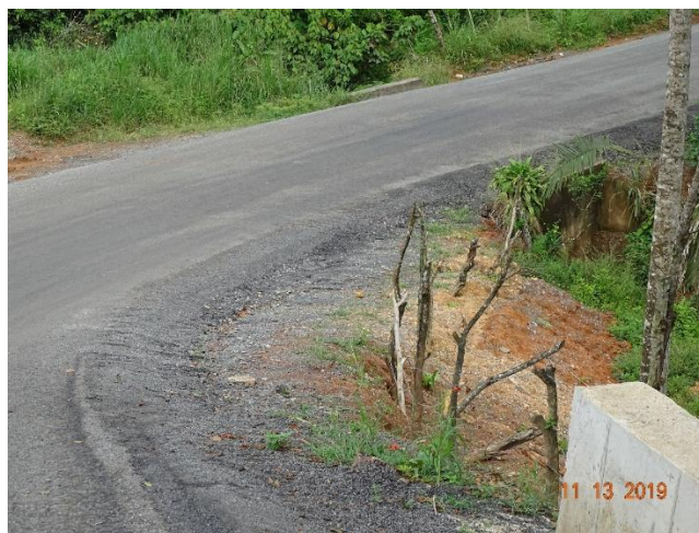
Fotografía 20. Ausencia de cunetas revestidas en margen derecho de la vía.
