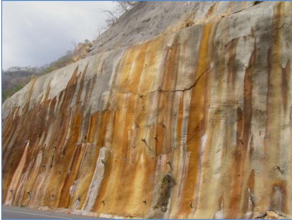
Fotografía No.1 Condición actual talud PK 38+500, lado derecho sentido SJ-Caldera.
