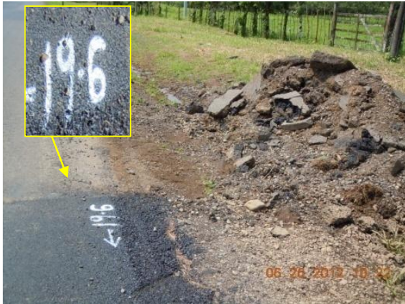
Fotografía 38. Escombros apilados en el derecho de vía. Se observa fecha de construcción de 7 días atrás.
