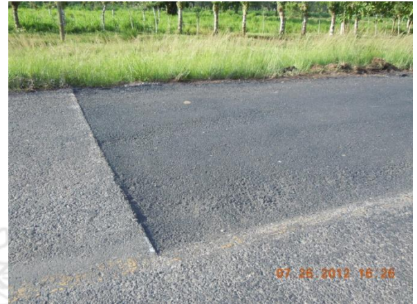
Fotografía 25. Bacheo inconcluso, se puede apreciar el desnivel con el resto de la calzada.
