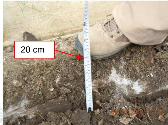
Fotografía 2. Espesor a rellenar de 20 cm. Se observa ausencia de material granular.
