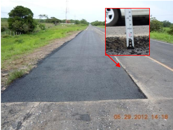
Fotografía 20. Bacheo inconcluso, espesor faltante de 3 cm.
