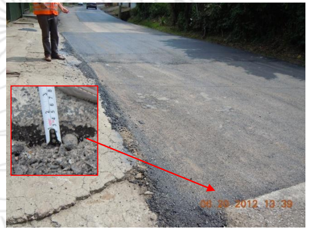
Fotografía 19: Espesores faltantes de 3 cm.
