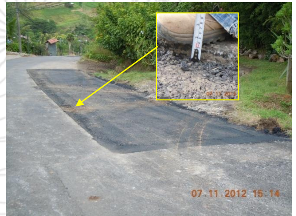
Fotografía 15. Bacheo con faltante de mezcla asfáltica.
