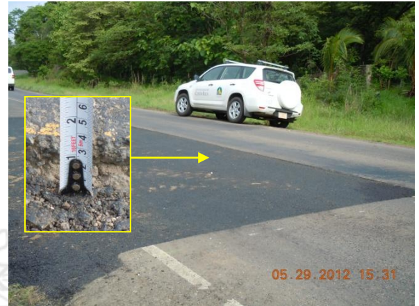
Fotografía 21. Bacheo inconcluso, espesor faltante se rellenó el siguiente día.
