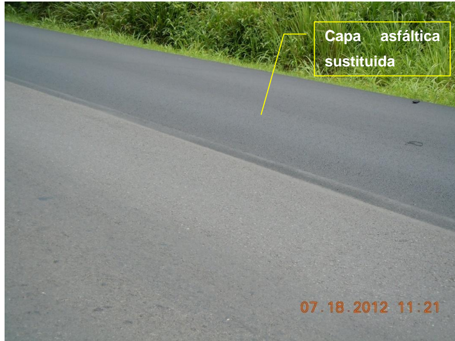
Fotografía 7. Carril donde se sustituyó la capa asfáltica por problemas de exudación. Ubicación: Aprox. Km 0+600 desde intersección Con Ruta Nacional 4 hacia Guápiles. Fecha: 18 de julio 2012. Fuente: LanammeUCR.
