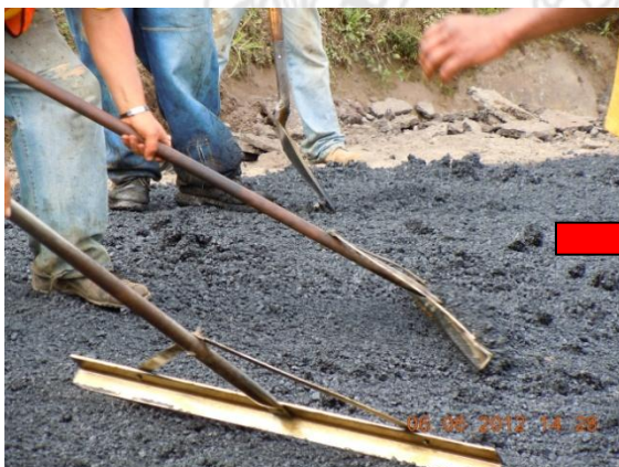
Fotografía 32. Presencia de grumos en la mezcla. Ubicación: Ruta Nacional 230, 800 m de Pacayas hacia Capellades. Fecha: 6 de junio de 2012.
