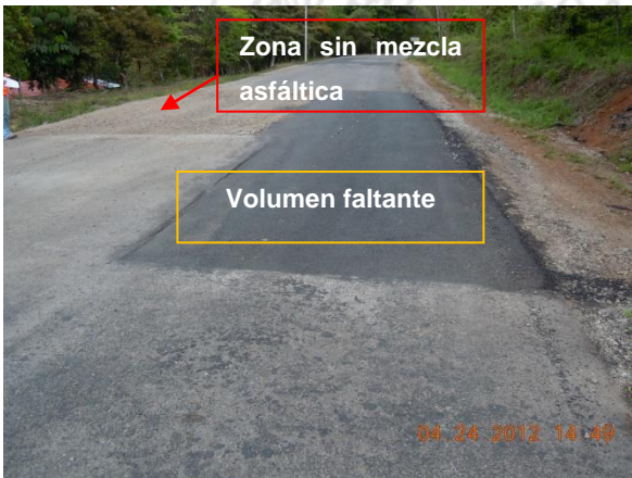
Fotografía 22. Zona de bacheos inconclusos.
