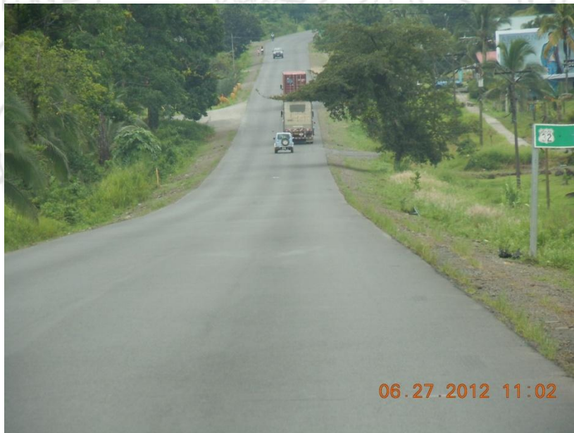
Fotografía 5: Exudación en ambos sentidos de la vía. Ubicación: Ruta Nacional 32, aprox. Km 2+500 desde intersección con Ruta 4 hacia Limón. Fecha: 27 de junio de 2012.
