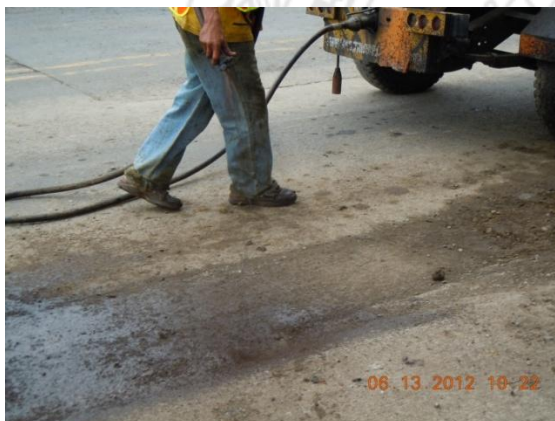
Fotografía 3. Se observó aspersión de riego de liga asfáltica sobre superficie contaminada.
