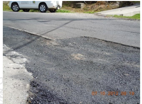
Fotografía 17. Corte en el pavimento sin rellenar. Ubicación: Zona 1-7 Cartago, sobre la Ruta Nacional 218, Aprox. 0+400 Km del Bar la Y Griega, Sentido Llano Grande – Taras. Fecha: 10 de julio de 2012.
