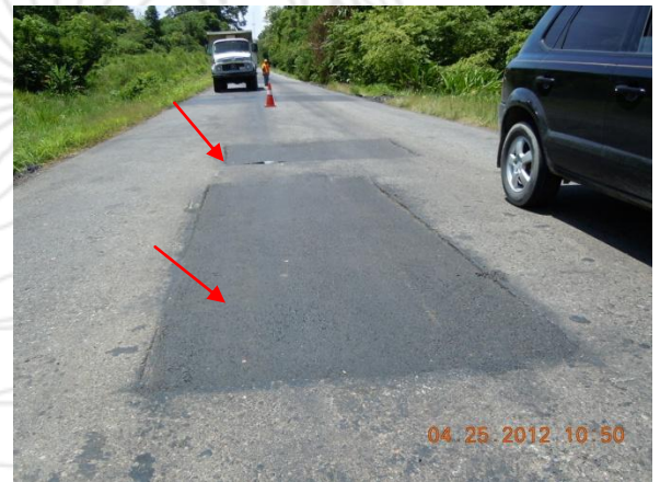
Fotografía 23. Bacheos con espesores faltantes por rellenar.
