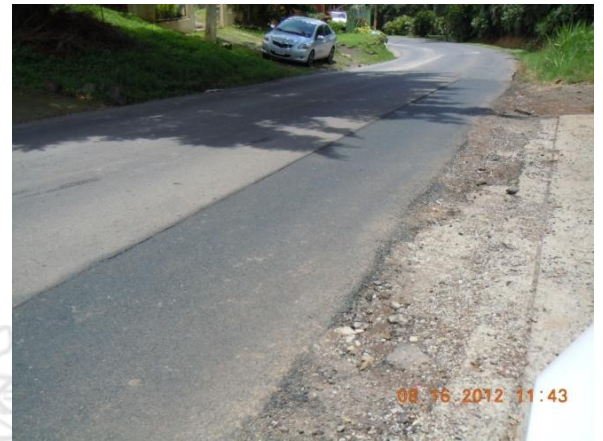
Fotografía 13. Bacheo con volumen faltante de mezcla.
