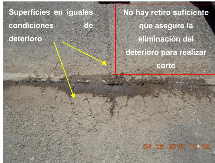
Fotografía 11. Criterio de selección inadecuado, no hay extensión desde el deterioro hacia pavimento “sano”, se aprecian grietas a ambos lados del corte con sierra. Ubicación: Zona 4-3 Zona Sur, Ruta Nacional 2, aprox. Km 13+000 desde Palmar Norte hacia Paso Canoas. Fecha: 25 de abril de 2012.
