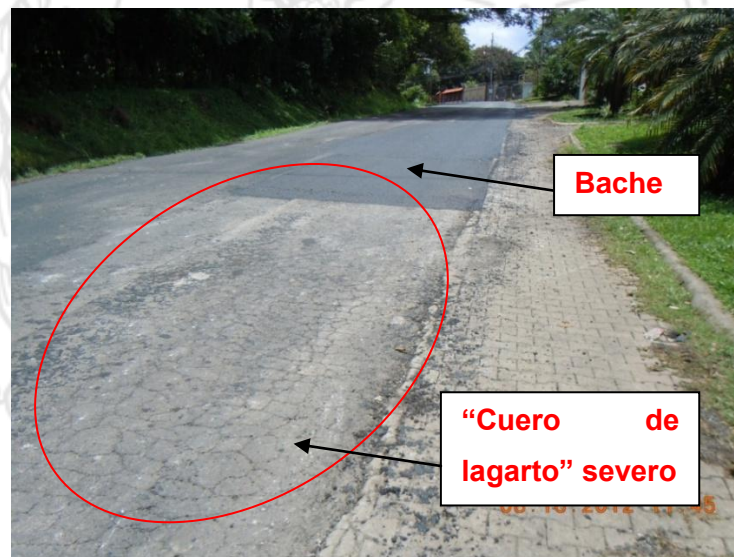
Fotografía 46. “Cuero de lagarto” junto a bacheo, Ruta Nacional 136. Ubicación: Zona 1-4 Alajuela, Ruta Nacional 136, aprox. km 2+200 desde intersección con R.N. 3 hacia Turrucare. Fuente: LanammeUCR.
