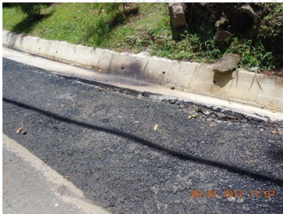
Fotografía 26. Volumen de mezcla asfáltica faltante.
