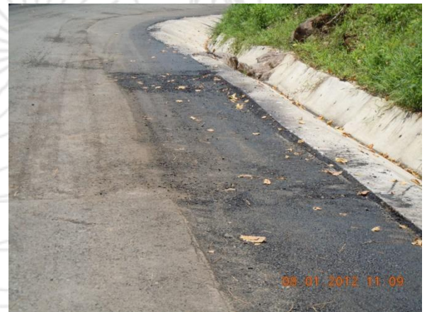
Fotografía 27. Volumen de mezcla asfáltica faltante.
