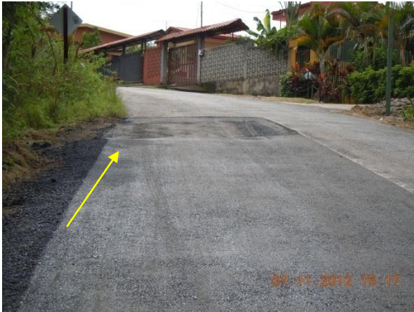
Fotografía 16. Bache con faltante de mezcla asfáltica.
