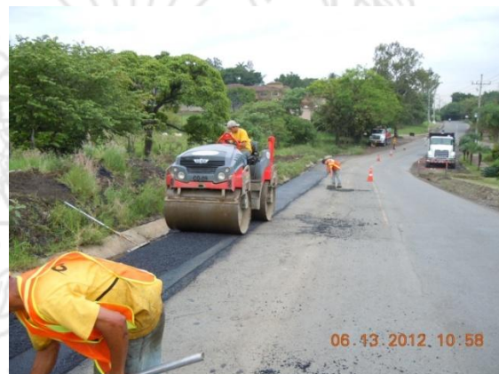
Fotografía 4. Obsérvese la compactación con rodillo sobre la franja realizada. En algunos sitios el compactador se monta sobre el borde de la calzada antigua y el borde de la cuneta. Se observa ausencia de material granular.
