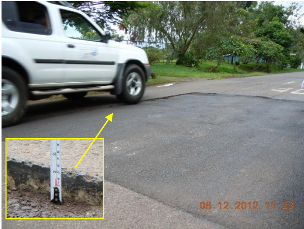
Fotografía 12. Bacheo inconcluso, se observa irregularidades en la superficie de ruedo.
