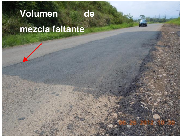
Fotografía 24. Bacheo con volumen de mezcla faltante y acabado irregular.
