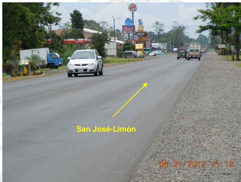
Fotografía 6. Exudación en el pavimento.
