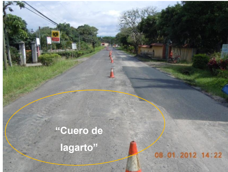
Fotografía 45. “Cuero de lagarto” junto bacheos en Ruta Nacional 136. Ubicación: Ruta Nacional 136, Aprox. 2 Km desde la Intersección con Ruta 3. Fuente: LanammeUCR.
