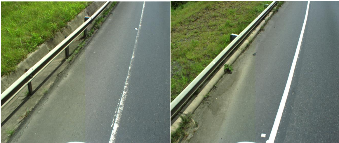
Figura 13. Sistema de contención semirrígido anclado en concreto y con bordillo, inmediatez a la estación 36+100
