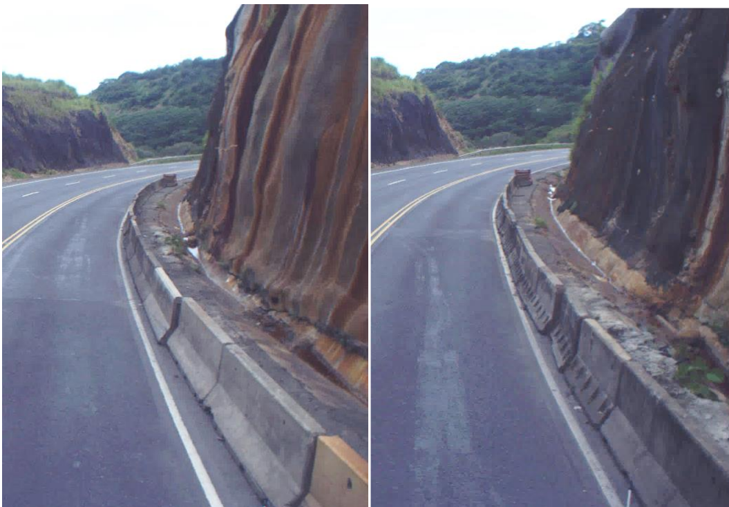
Figura 6. Barrera de concreto dañadas y sin anclajes, inmediación a la estación 38+500 Nota: Generado a partir de levantamiento GEO-3D. UGERVN, 2018.
