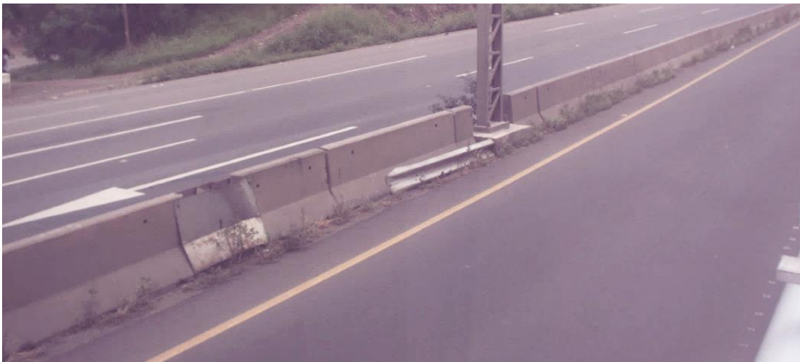
Figura 17. Mediana de concreto con discontinuidades aledaño a conexión con Ruta Nacional 755, inmediación a la estación 71+700
