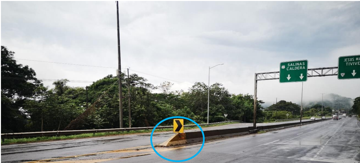
Figura 16. Mediana de concreto aledaño a conexión con Ruta Nacional 755, inmediación a la estación 71+650
