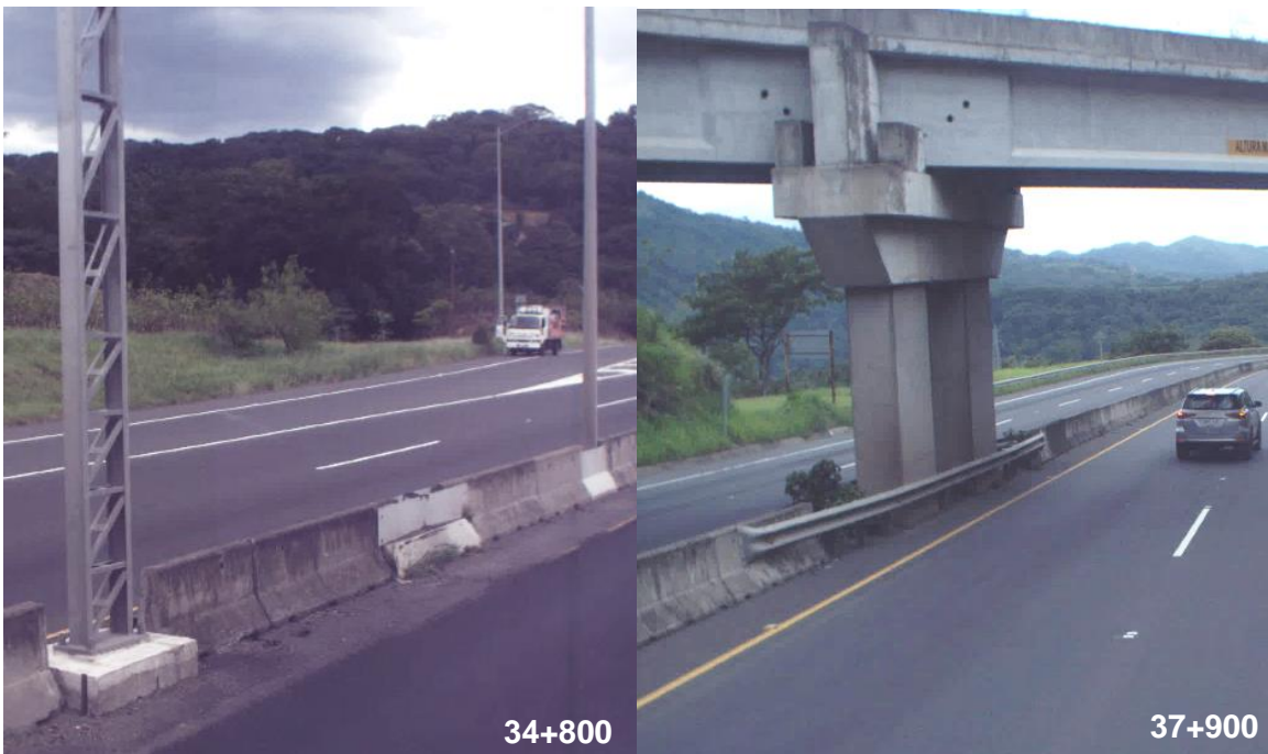
Figura 11. Discontinuidades en barreras medianas Nota: Generado a partir de levantamiento GEO-3D. UGERVN, 2018.
