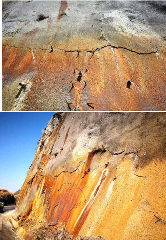
Figura 62: Agrietamiento PK38+600. Se observan las grietas que cortan el concreto en varios sentidos debido al Drenaje Ácido de Rocas.
