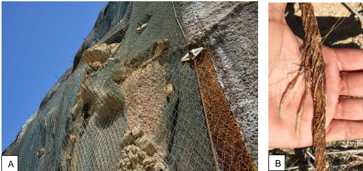
Figura 61: Talud intervenido, PK 38+600. A) Suelo acumulado en la malla metálica. B) Deterioro observado en los cables metálicos de refuerzo y anclajes.
