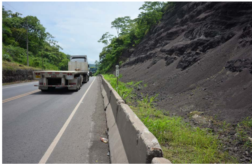
Figura 67: PK 73 +000 Se observa material caído y que satura la cuneta al pie del talud
