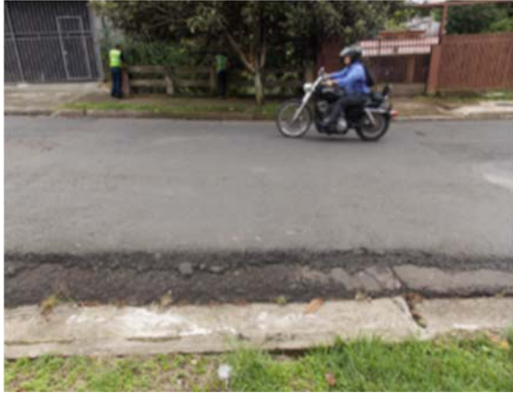
Sobrecapas de asfalto generan peso adicional en el puente.
