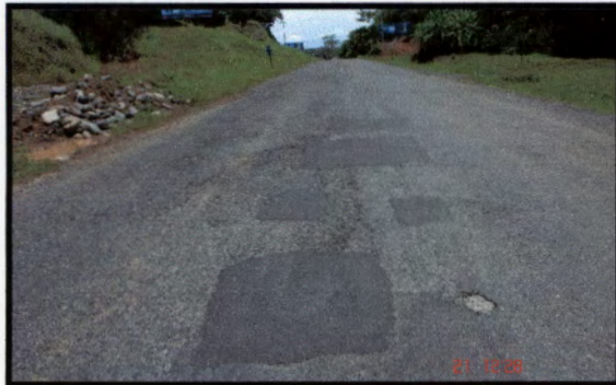
Ilustración 3 Desprendimientos característicos de la sección observada, ruta 34, Esterillos – Lomas
