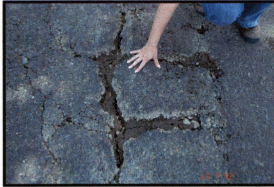
Ilustración 6 Ancho de grietas de severidad alta
