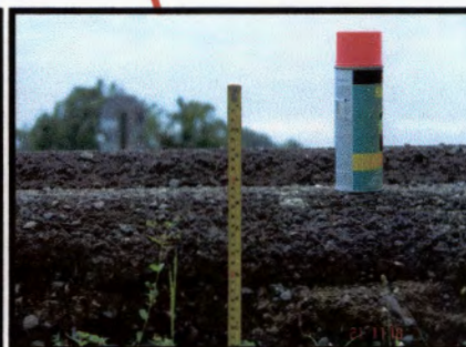
Espesores del pavimento observados en el sitio
