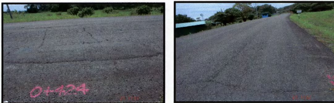
Ilustración 5 Patrón de agrietamiento presente a lo largo de toda la sección
