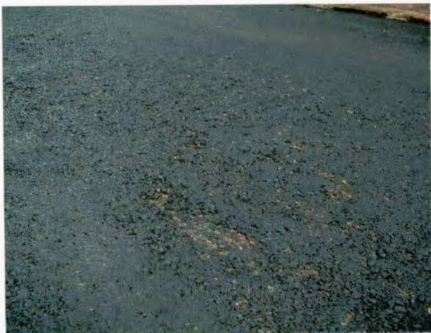
Fotografía 3: Problema de uniformidad en la mezcla.
