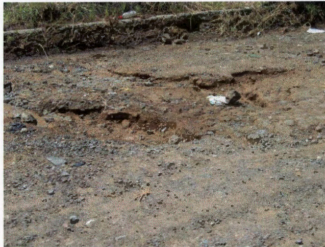
Figura 7. Calle Solar. Formación de huecos.
