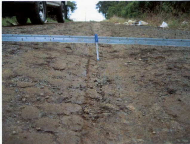
Figura 5. Calle Precario. "Canales" longitudinales.
