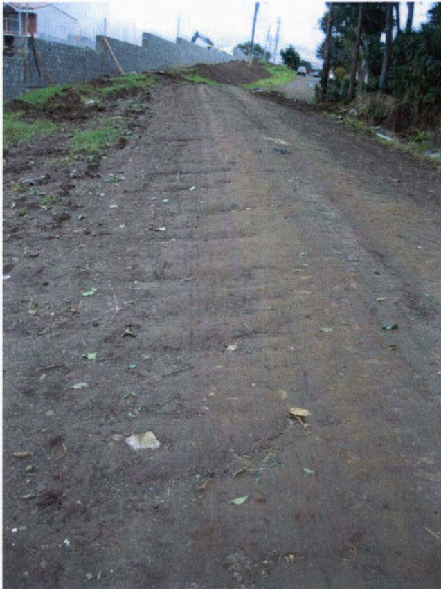
Figura 5. Calle Precario. Corrugaciones en la superficie.
