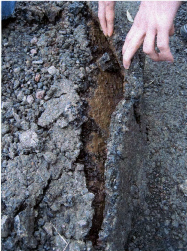
Figura 12. Calle Ancha Mercedes Norte. Mala adherencia de la capa asfáltica.
