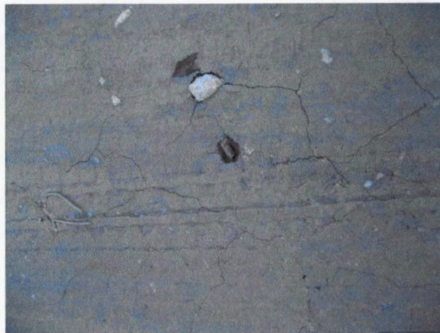
Figura 8. Calle Solar. Fisuras superficiales.
