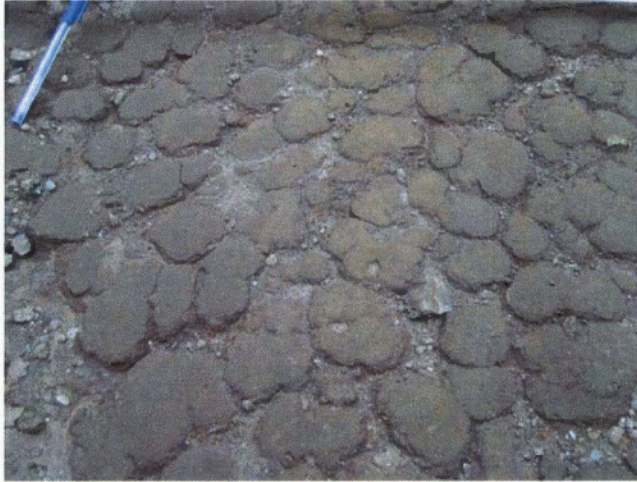
Figura 4. Calle Precario. Erosión de finos.
