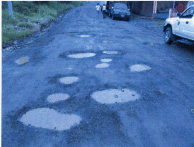
Figura 11. Calle Cloaca. Formación de baches.
