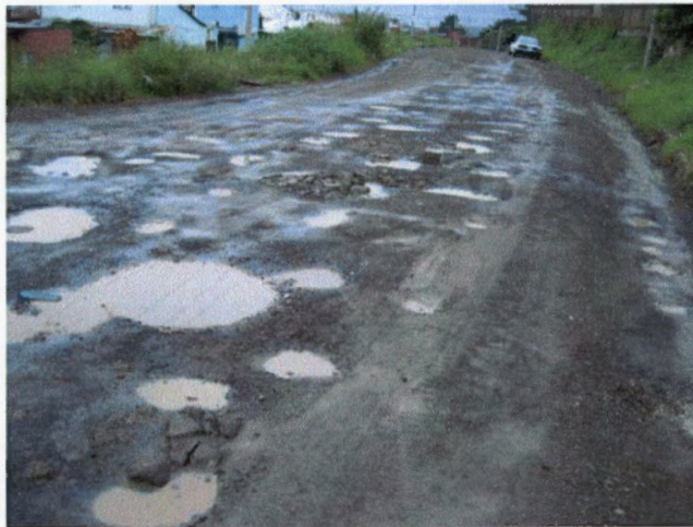
Figura 10. Calle Cloaca. Formación de baches.
