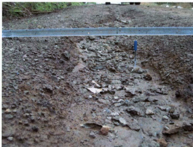
Figura 3. Calle Precario. Formación de canales (erosión).
