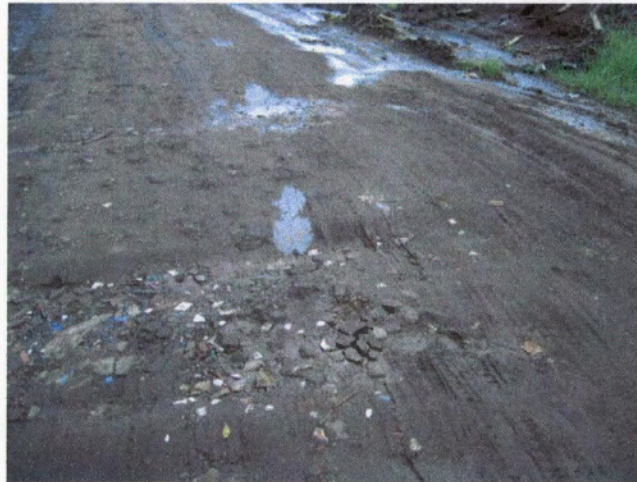
Figura 2. Calle Precario. Deformaciones en la superficie.
