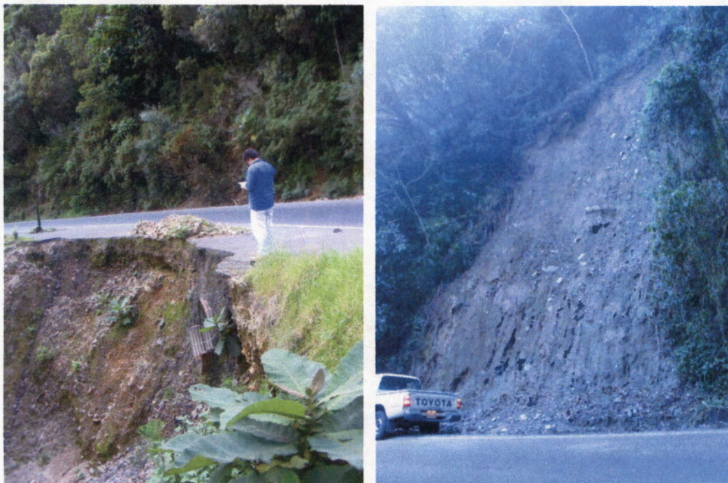
Figura 12: Zona de inestabilidad entre La Georgina y San Isidro de Pérez Zeledón. A la izquierda, falla del terraplén (estacionamiento 80+200); a la derecha, talud inestable con aproximadamente 15 metros de altura, el cual presenta deslizamiento reciente de materiales hacia la carretera (estacionamiento 85+720) (noviembre 2003).
