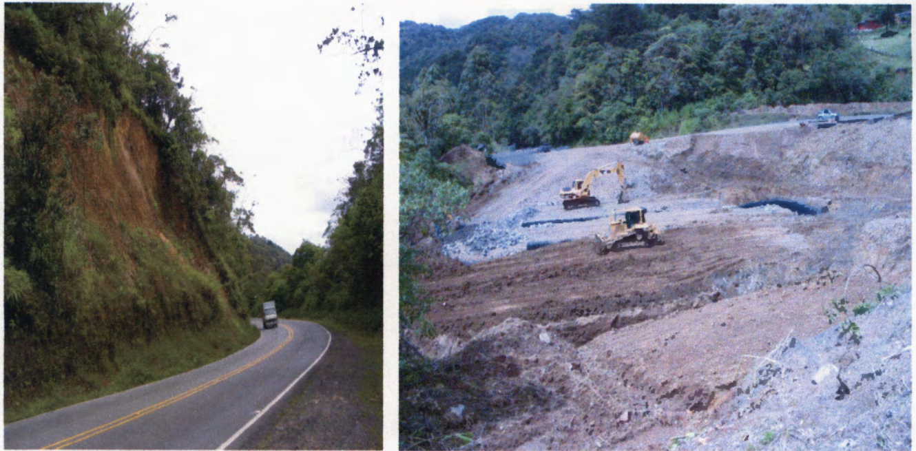
Figura 11: Zona de inestabilidad entre San Isidro de Cartago y El Empalme. En la imagen de la izquierda, talud inestable de más de 10 metros de altura (estacionamiento 12+860); a la derecha, trabajos de reconstrucción del terraplén debido a mal manejo de aguas (estacionamiento 15+400) (noviembre 2003).
