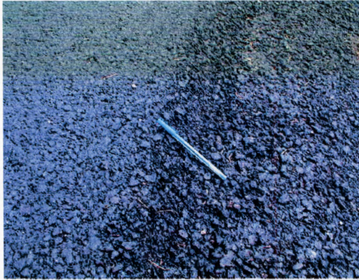
Fotografía F3: Detalle de diferencias de textura superficial.
