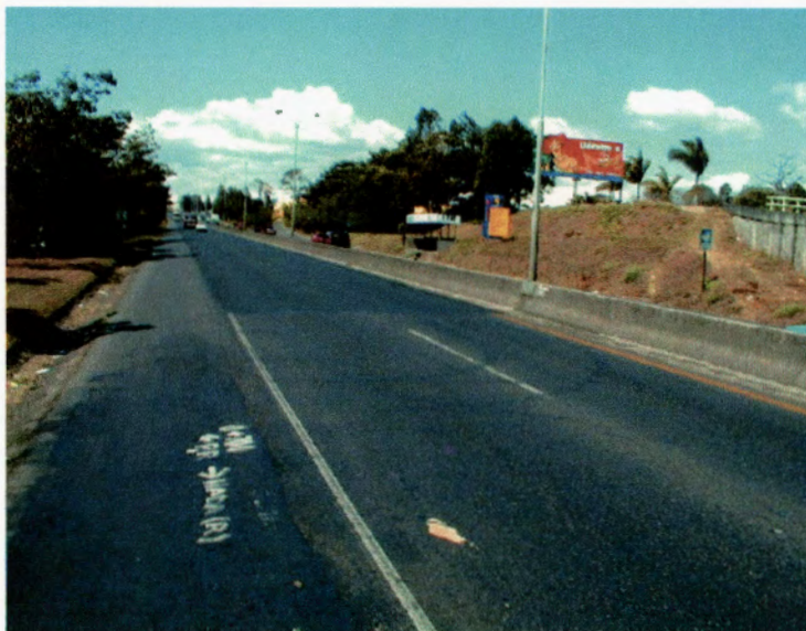
Fotografía F2: Vista general del recarpeteo en las cercanías al Hotel Meliá Cariari.
