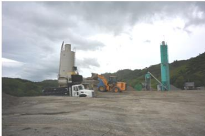
Figura 7. Plantel donde se mezcla el material extraído del km con cemento para su posterior colocación como base estabilizada.
