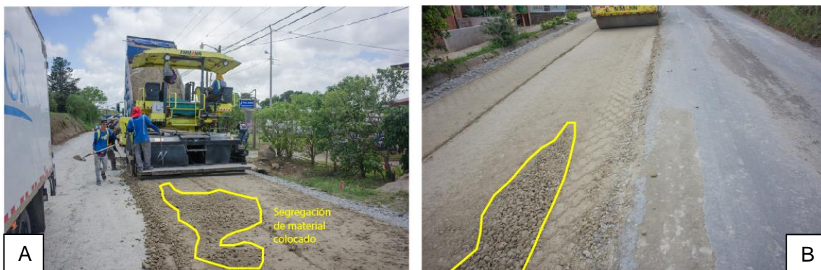
Figura 3. Estacionamiento km 22+495, viernes 8 de junio 2018. A) Se observa segregación de material por tamaño producida durante la colocación con maquinaria tipo pavimentadora. B) Posterior a la colocación del material y el paso de la aplanadora, se siguen observando diferencias en la granulometría del material acumulado.
