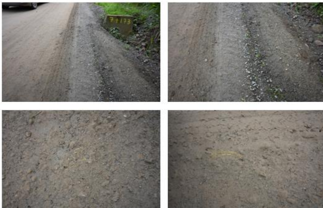
Figura 4. En el estacionamiento km 7 +173 se pudo observar como el material de sub base colocado presenta contaminación con material orgánico, como restos de plantas y suelo.
