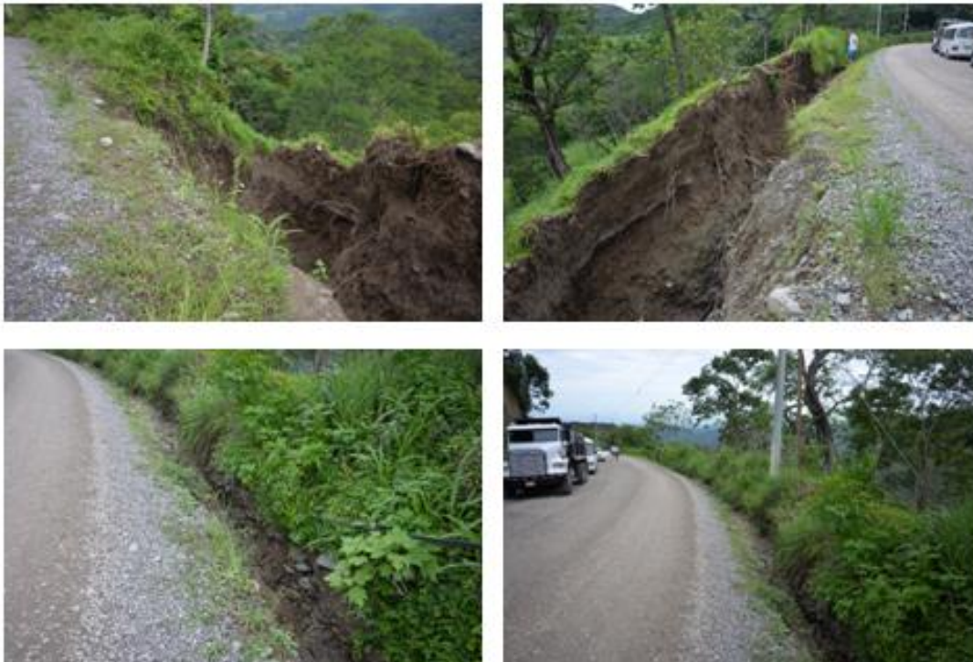
Figura 6. Se observa como la erosión hídrica ha generado profundización de las cunetas en tierra.
