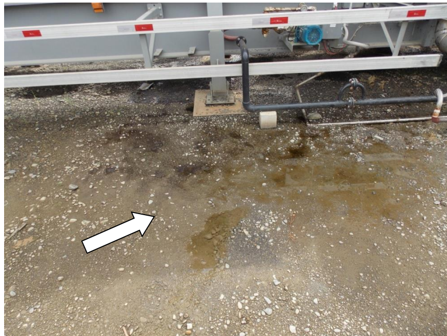
Fotografía 21. Derrame de combustible cerca de tanques de material combustible sin barrera perimetral Fecha de la fotografía 6-12-2017. Fuente: LanammeUCR
