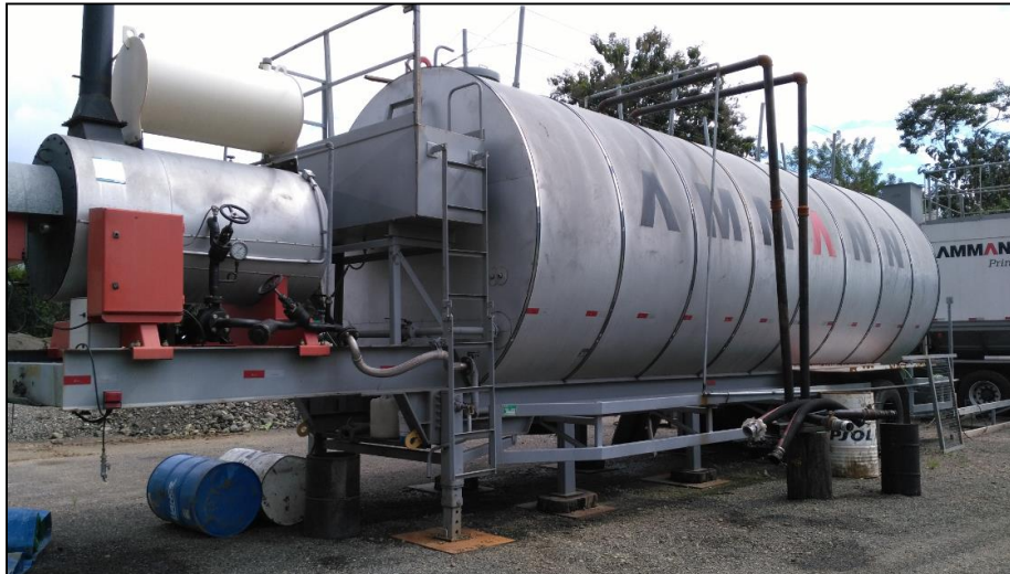
Fotografía 20. Tanques de material combustible sin barrera perimetral Fecha de la fotografía 6-12-2017. Fuente: LanammeUCR
