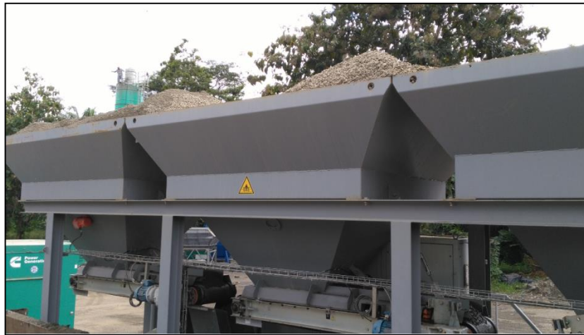
Fotografía 16. Tolvas de agregado en frío. Fecha de la fotografía 6-12-2017. Fuente: LanammeUCR
