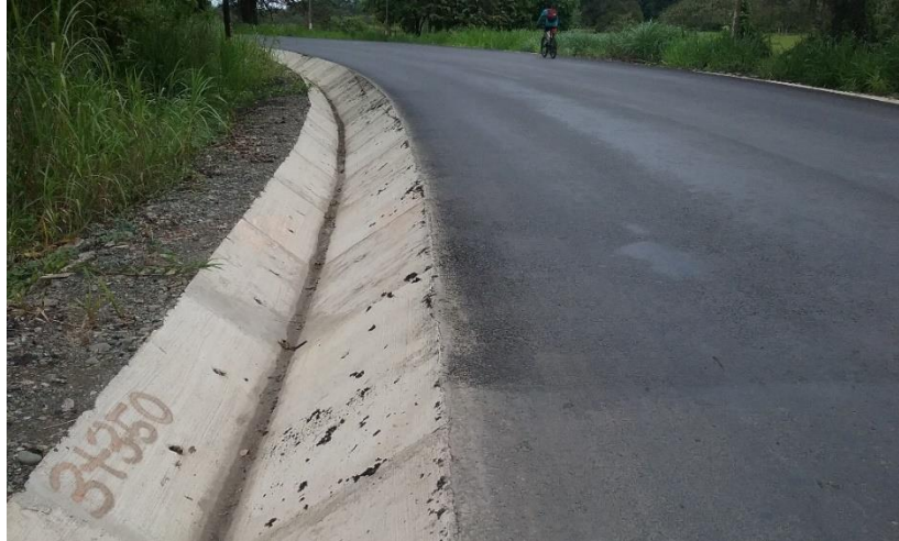
Fotografía 2. Exudación de asfalto en junta transversal. Estación 3+350. Fecha de la fotografía 25-04-2018. Fuente: LanammeUCR.
