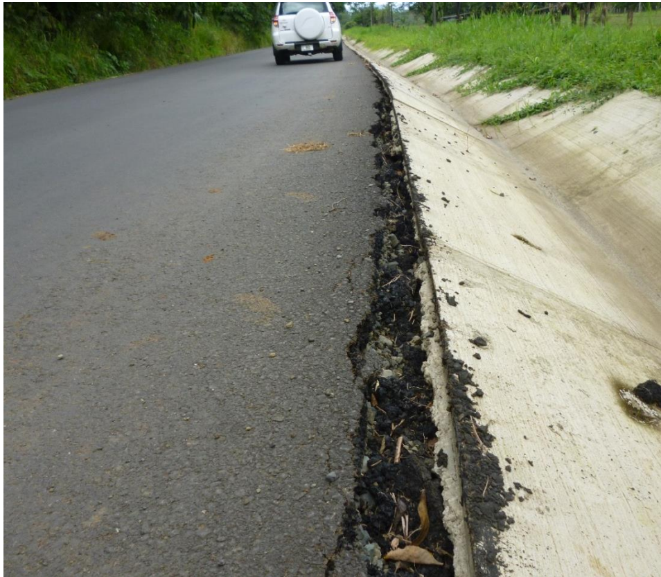
Fotografía 6. Deterioro en el borde la calzada. Estación 4+350.
