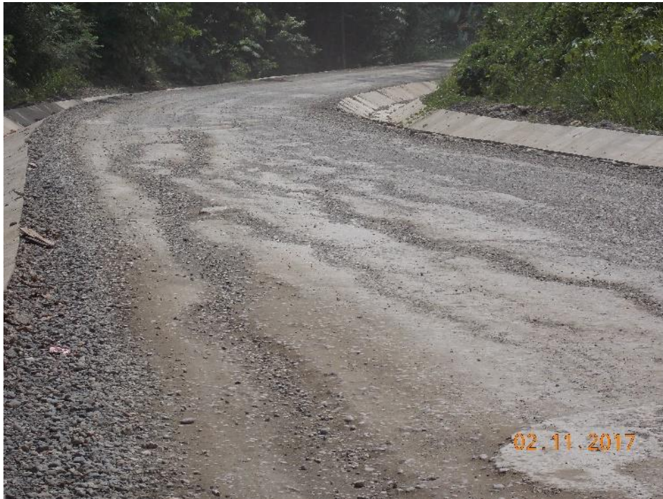
Fotografía 11. Deterioros en la base granular. Estación 4+000. Fecha de la fotografía: 02-11-2017. Fuente: LanammeUCR.
