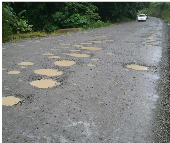
Fotografía 9. Deterioros en la base en la estación 1+850.
