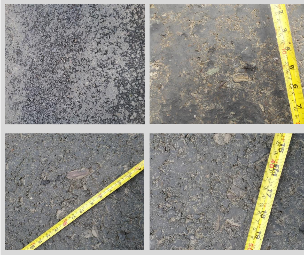
Fotografía 3. Desnudamiento de agregado en el tramo ente 2+200 y 2+400.
