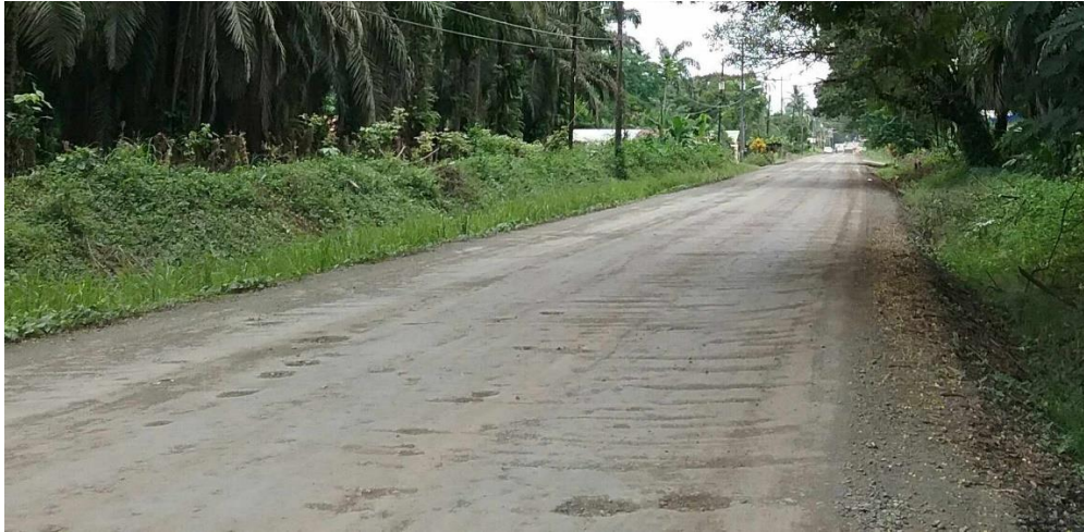
Fotografía 10. Tramo imprimado con deterioros superficiales. Estación 5+700. Fecha de la fotografía 20-07-2017. Fuente: LanammeUCR.
