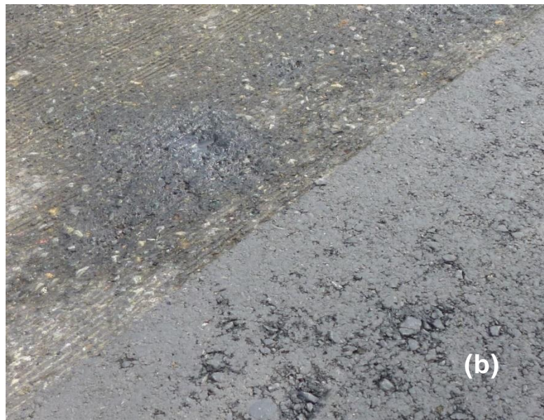
Fotografía 5. Deterioro superficial por correcciones de regularidad. Estación 2+190. Fecha: 27-08-2018. Fuente: LanammeUCR
