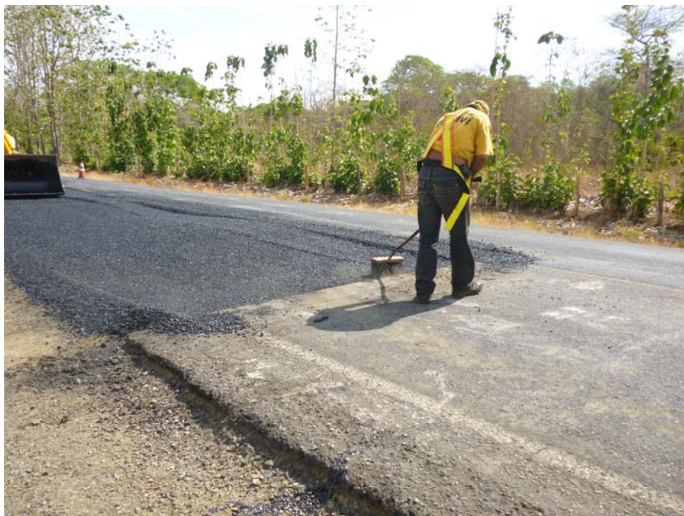
Fotografía 14: Zona 2-3 Santa Cruz, barrido del material sobrante contaminado alrededor del bache. Ubicación: Ruta Nacional No.21, sección Río Cañas - Santa Cruz. 4km de la intersección con Ruta No.160. Fecha: 30 de enero del 2013. Fuente: Unidad de Auditoría Técnica, LanammeUCR.
