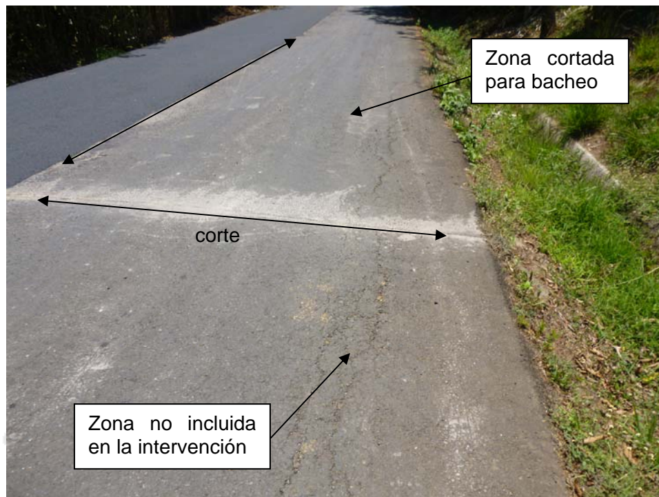
Fotografía 6. Zona delimitada para intervenir por medio de bacheo. Ubicación: Zona 1-6 de Zona San Ramón, Ruta Nacional 742, Tramo: San Ramón - Piedades Sur. Aproximadamente 4,5km del inicio de la ruta en San Ramón. Fecha: 24 de abril de 2013.
