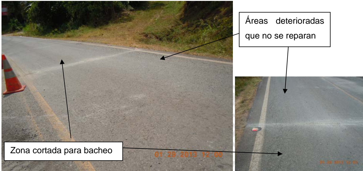
Fotografía 1. Se puede observar la zona cortada para bachear, y el resto del área de la superficie en una condición similar y que no será considerada para intervenir. Ubicación: Zona 4-1 de Pérez Zeledón, Ruta Nacional 2, Tramo: La Ese - San Isidro. Poblado: San Rafael. Fecha: 29 de enero de 2013.
