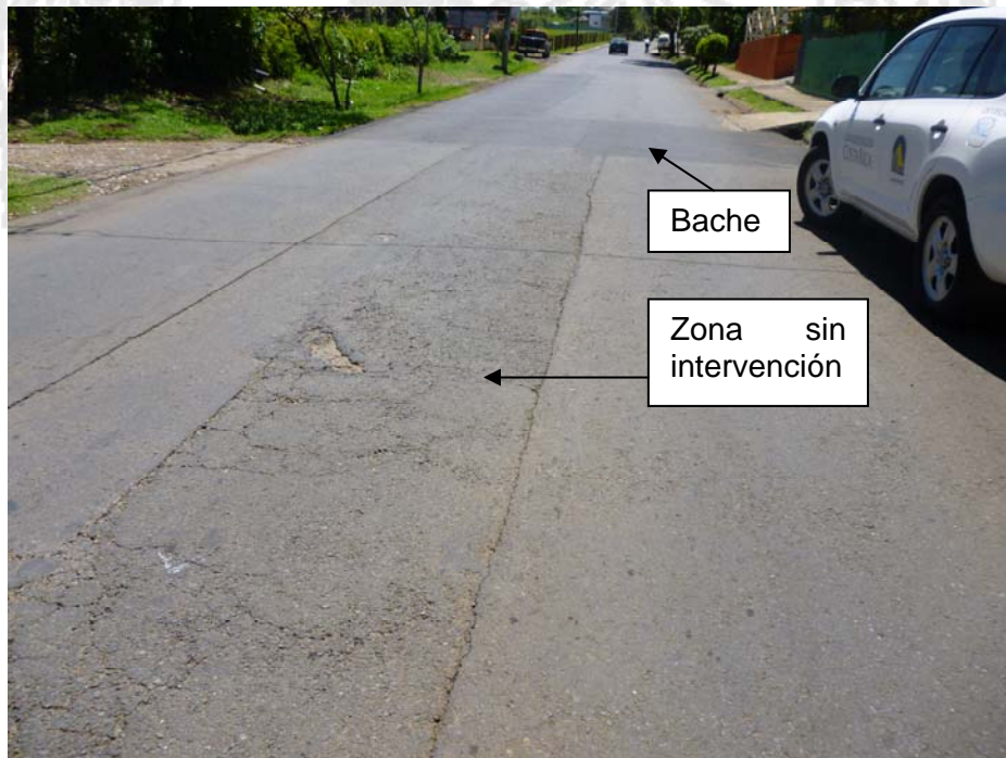
Fotografía 4. Deterioros existentes que no fueron intervenidos. Ubicación: Zona 1-9 de Zona Heredia, Ruta Nacional 129, Tramo: San Joaquín - Fátima. Aproximadamente 750m de la intersección de Fátima. Fecha: 24 de abril de 2013.
