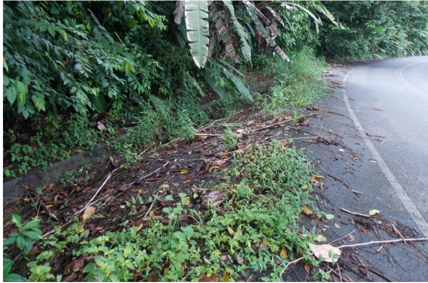
Figura 17: Estado de la cuneta, est. 44+100.
