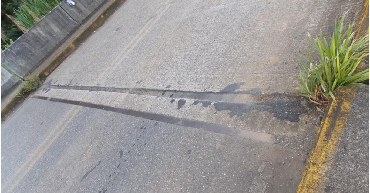
Figura 12: Estado de la junta, puente sobre el Río Barrigones.
