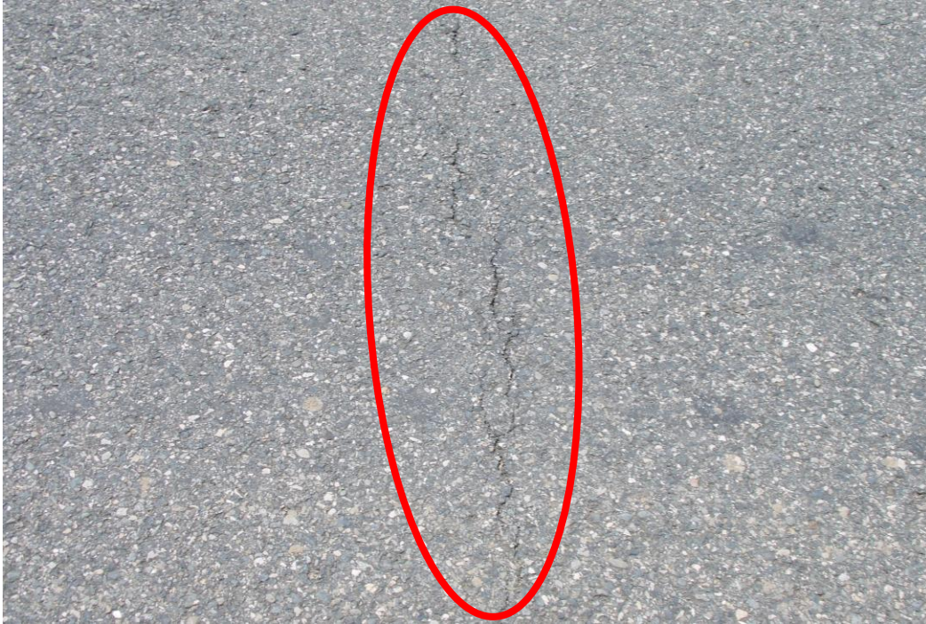
Figura 6: Agrietamiento en est. 70+690.
