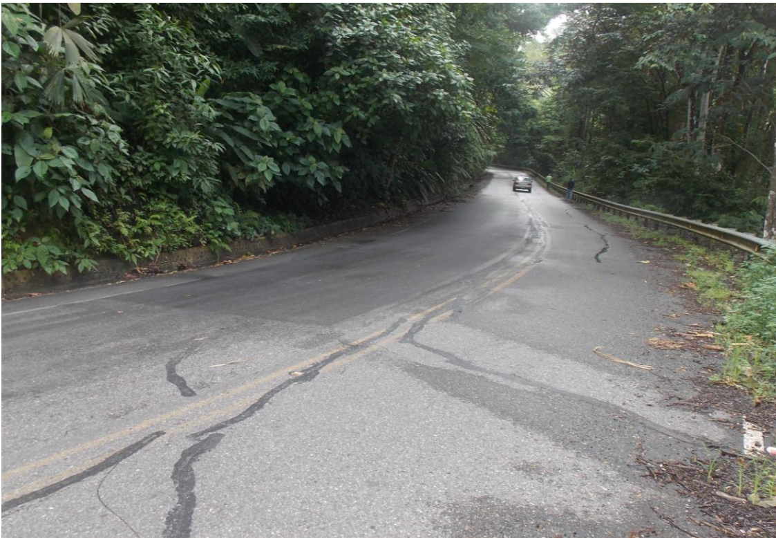
Figura 5: Agrietamientos y bache, est. 43+700 viendo hacia el norte .
