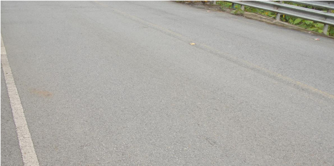
Figura 8: Estado de la señalización horizontal, est. 44+900, cerca del puente sobre el Río Rincón.
