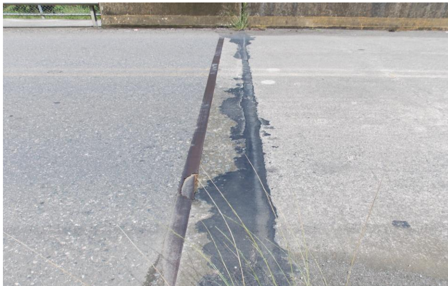
Figura 16: Estado de la junta, puente sobre la Quebrada Ignacia.
