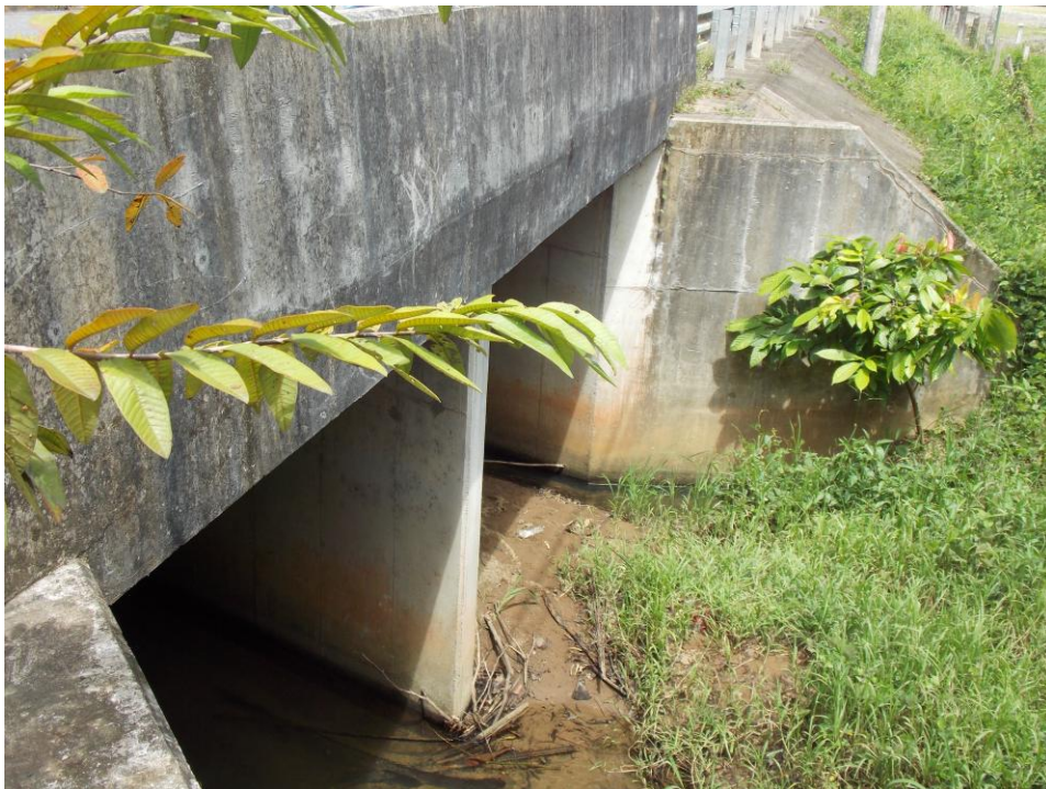
Figura A6: Vista de la salida de la alcantarilla en el est. 51+020.
