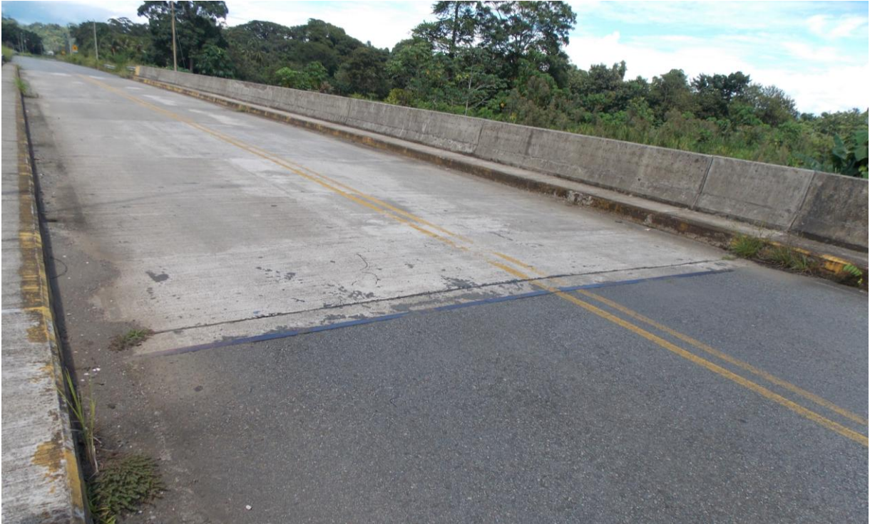
Figura 11: Vista del puente sobre el Río Conte. Nótase la acumulación de sedimentos a los lados de la calzada, así como el estado de la pintura y señalización horizontal.
