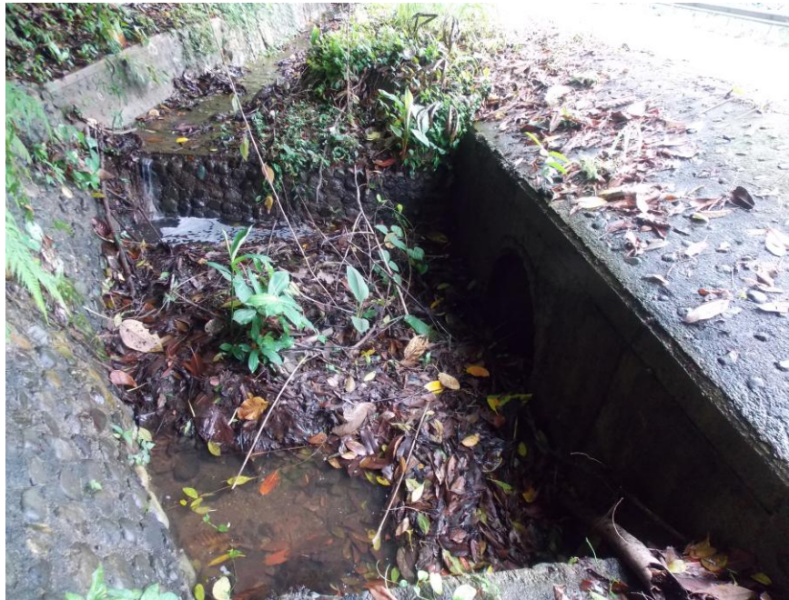
Figura 18: Estado de un cabezal de entrada, est. 44+100.
