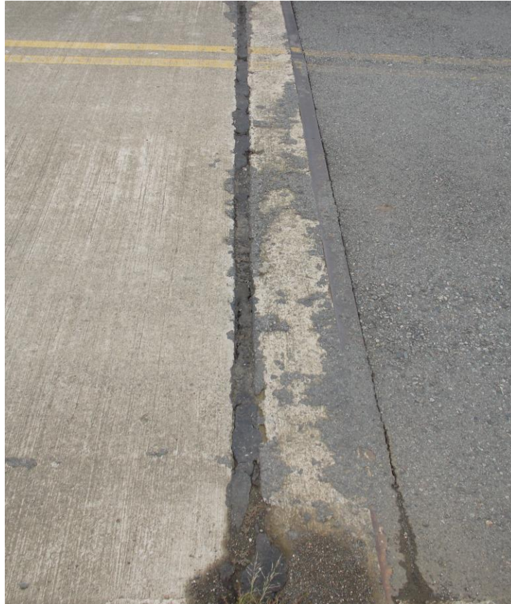
Figura 9: Estado de la junta norte, puente sobre el Río Rincón.
