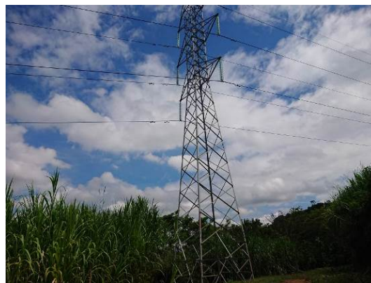
Figura 28. Torre de alta tensión dentro del Escenario 3. Fuente: LanammeUCR.
