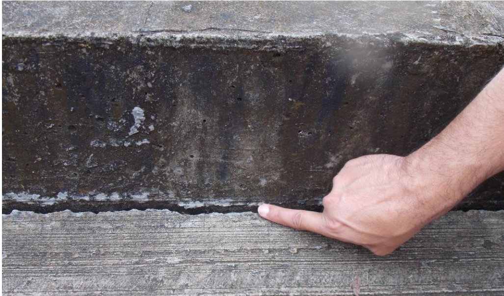
Figura 12: Separación entre la corona del muro y la cuneta, est. 24+400.
