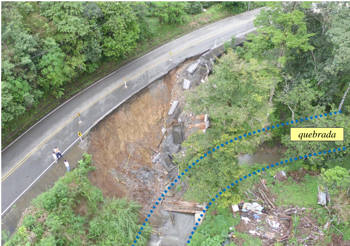
Figura 5: Vista aérea del fallo del muro de tablaestaca, est. 15+400.
