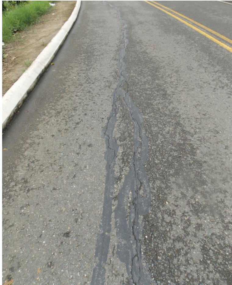
Figura 2: Fallo en el sello de grietas, est. 19+000.
