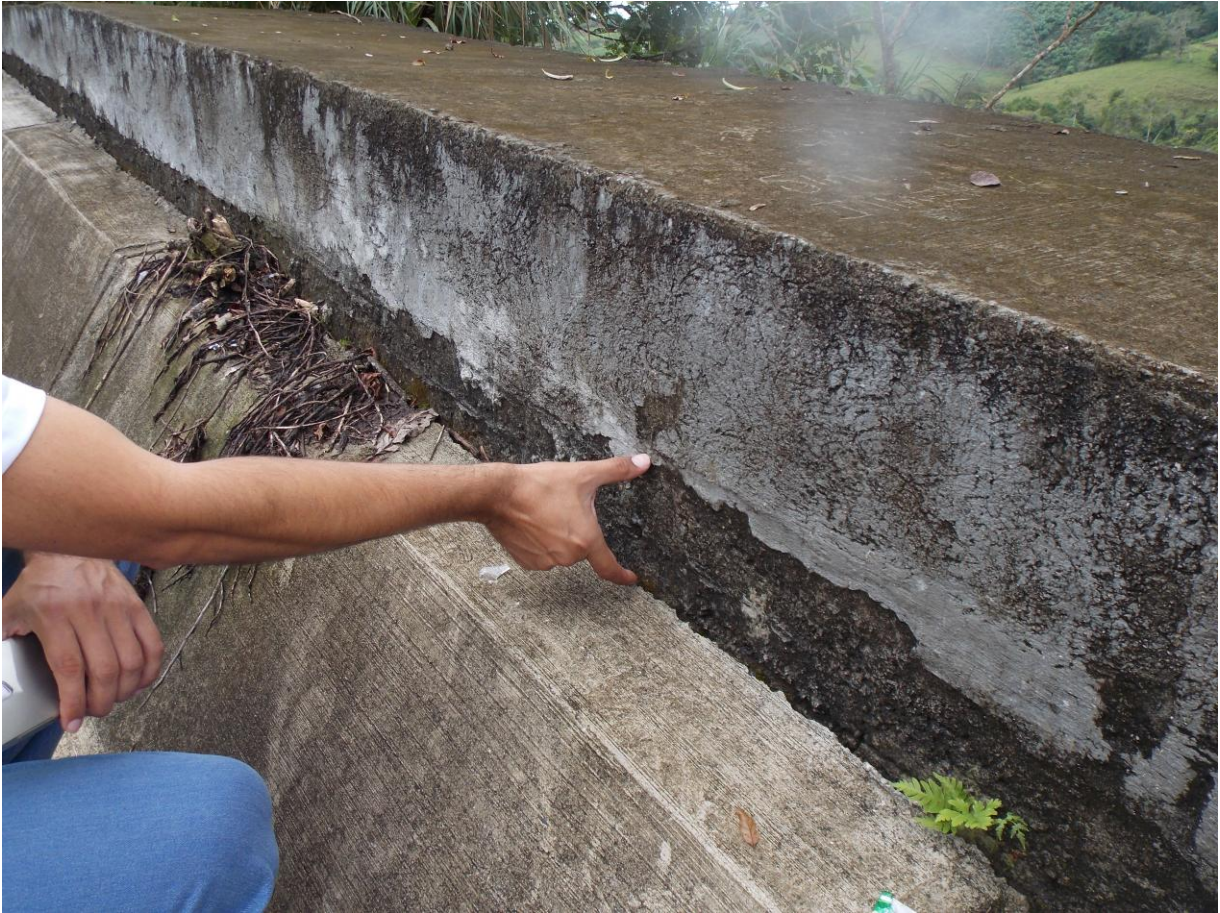
Figura 9: Asentamiento de la corona del muro con respecto a la cuneta, est. 16+900.
