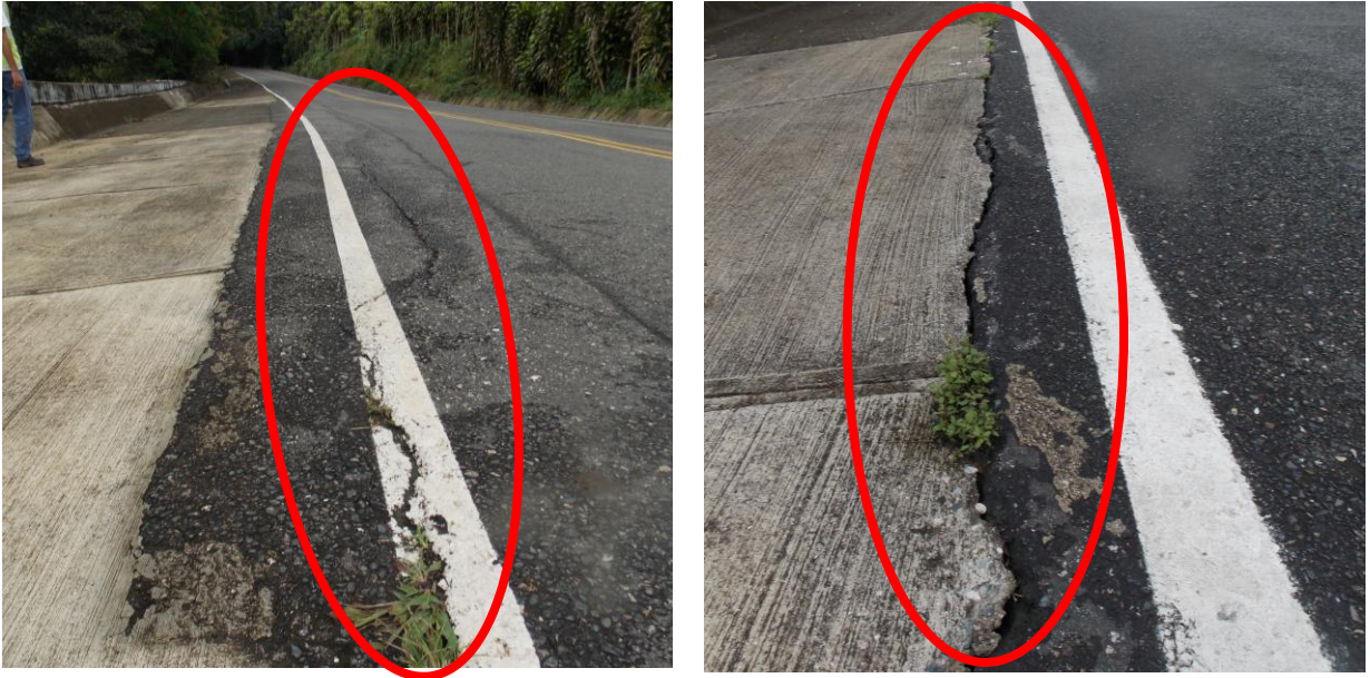
Figura 7: Grietas en la carpeta y unión con la cuneta, est. 16+900
