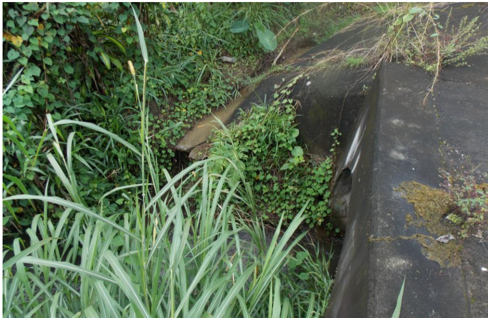
Figura 16: Estado de la salida, alcantarilla en el est. 14+000.
