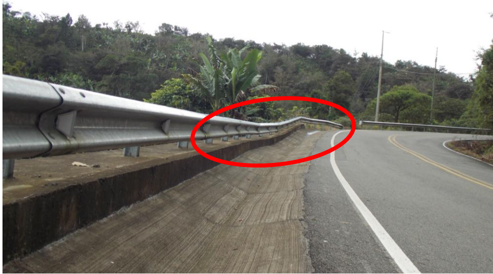
Figura 10: Deformaciones en la parte superior del muro de contención, est. 24+400.
