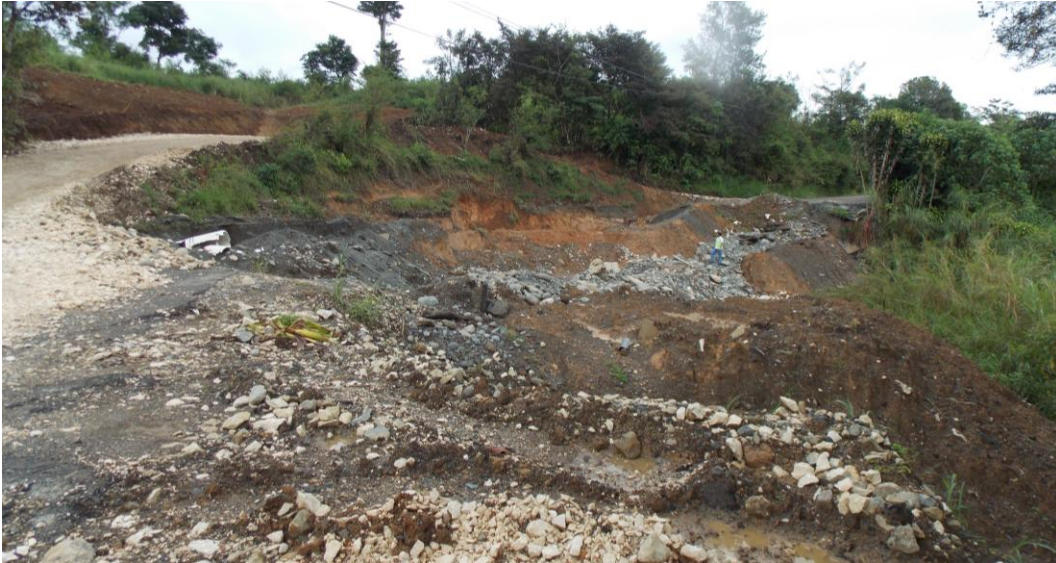
Figura 14: Estado del deslizamiento de terraplén en el est. 15+700.
