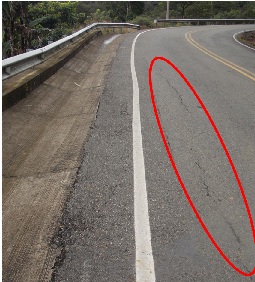
Figura 11: Agrietamientos en la carpeta junta al sitio con mayor deformación, est. 24+400.
