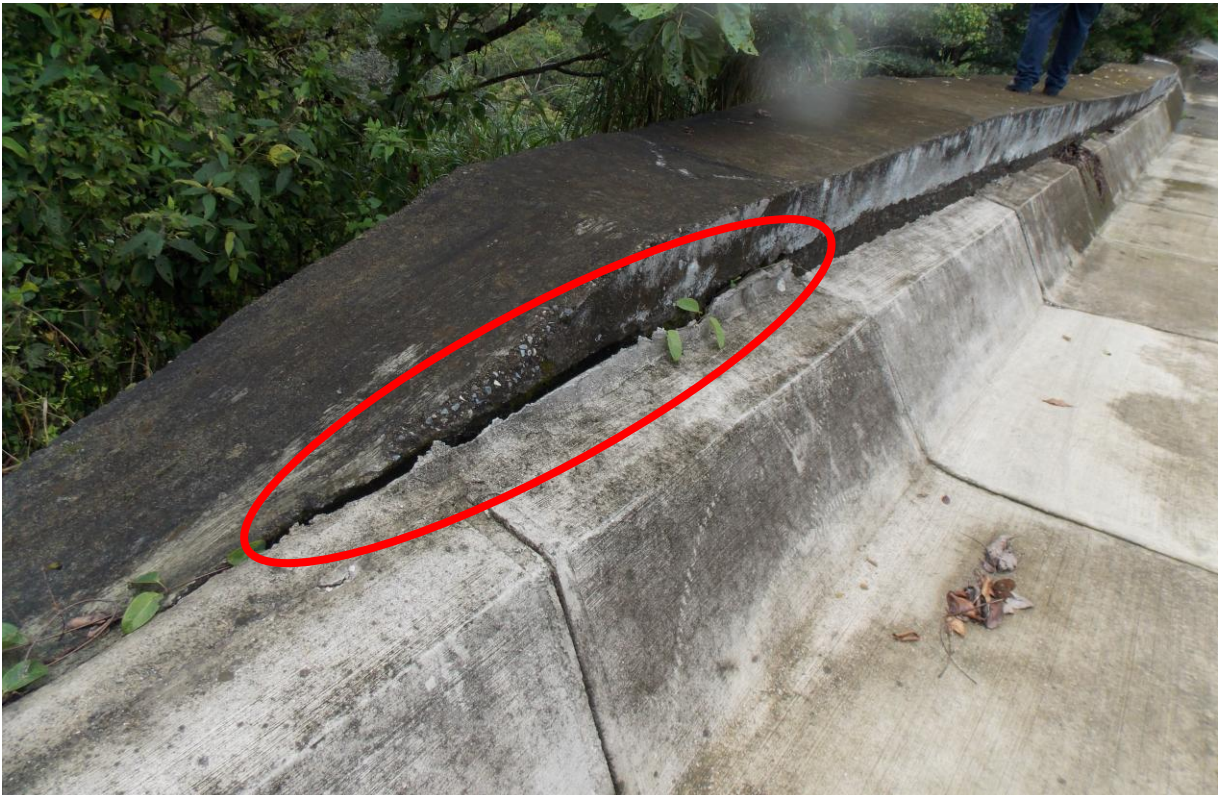
Figura 8: Separación de la corona del muro con la estructura de la cuneta, est. 16+900.
