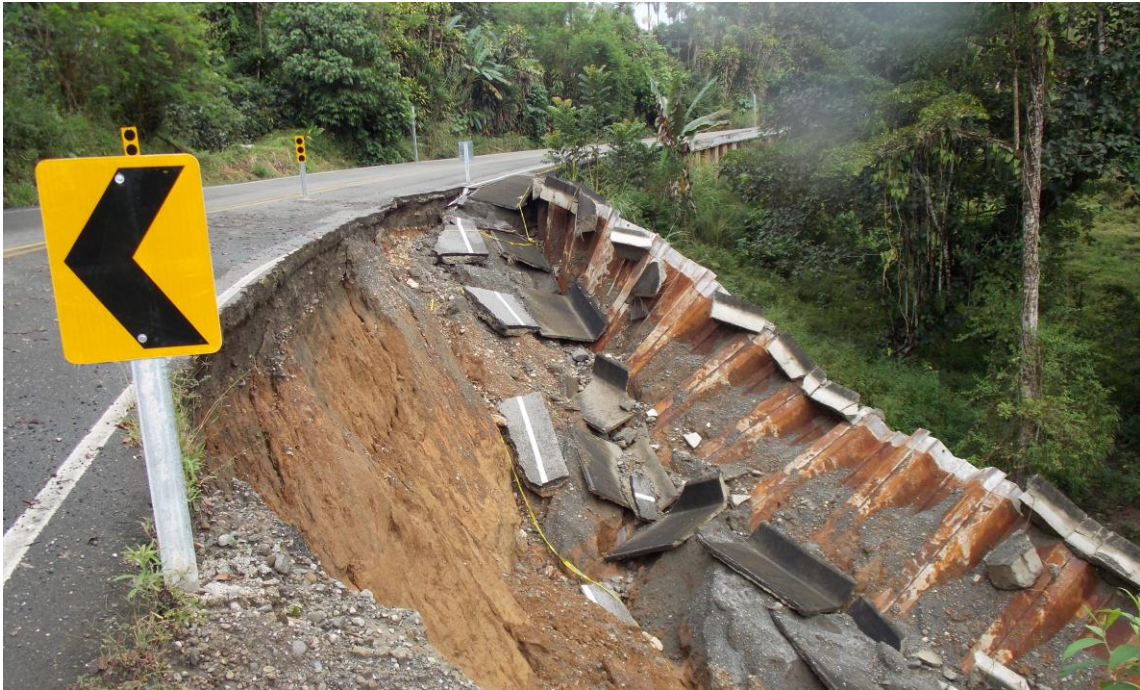
Figura 4: Fallo del muro de tablaestaca, est. 15+400.
