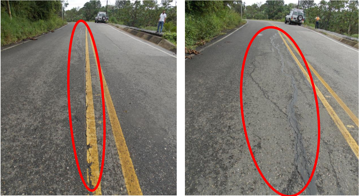
Figura 3: Agrietamiento en la carpeta en la est. 14+200. Parte de la grieta presenta un sello asfáltico que ya falló. La corona del muro de gaviones se encuentra a la derecha de la imagen, más allá de la cuneta.
