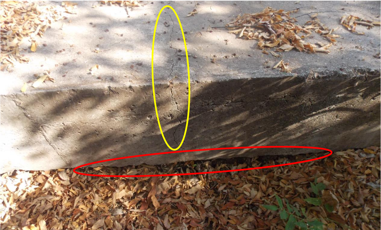
Figura 21: detalle del delantal a la salida de la alcantarilla en la est. 5+030, donde se evidencia la zona con socavación (en rojo) y la grieta en el delantal (en amarillo)
