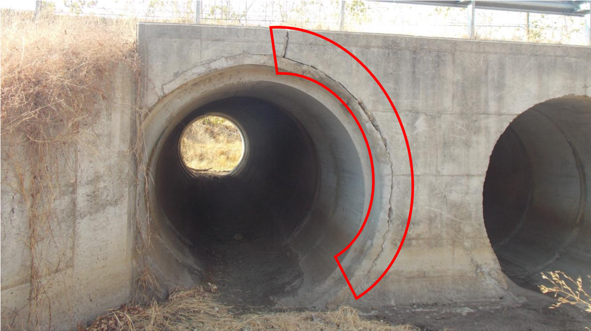
Figura 20: vista de la entrada, alcantarilla en est. 4+820. La zona roja indica la parte agrietado, y donde la tubería se encuentra parcialmente suelta del muro de concreto.
