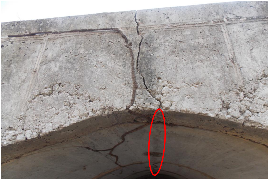
Figura 30: grieta en cabezal y tubería, alcantarilla en est. 8+220
