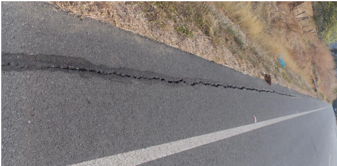
Figura 17: grieta de borde abierta, estación 3+960
