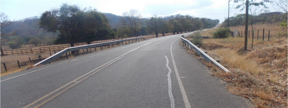
Figura 3: uso de guardavías como barandas , est. 3+520
