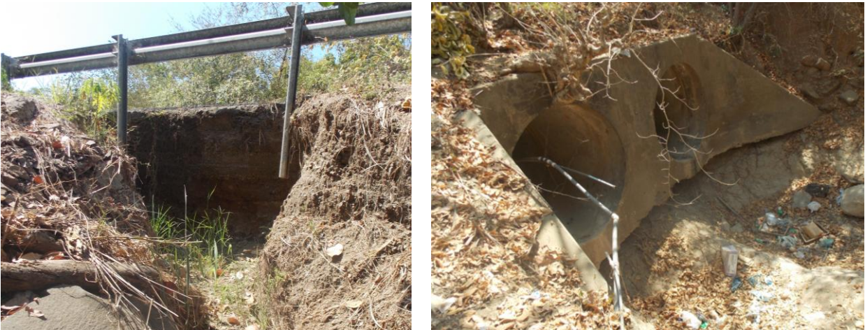
Figura 5: problemas en el guardavía, y vista de la salida, alcantarilla en est. 0+780
