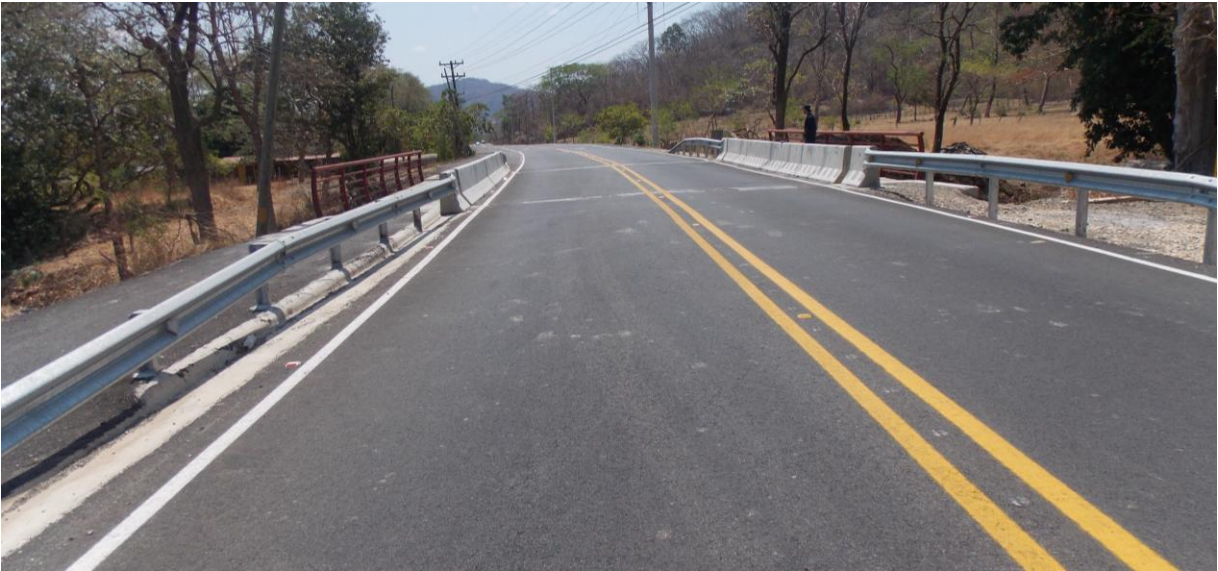
Figura 5: guardavías como complemento a barreras rígidas, puente en est. 2+760
