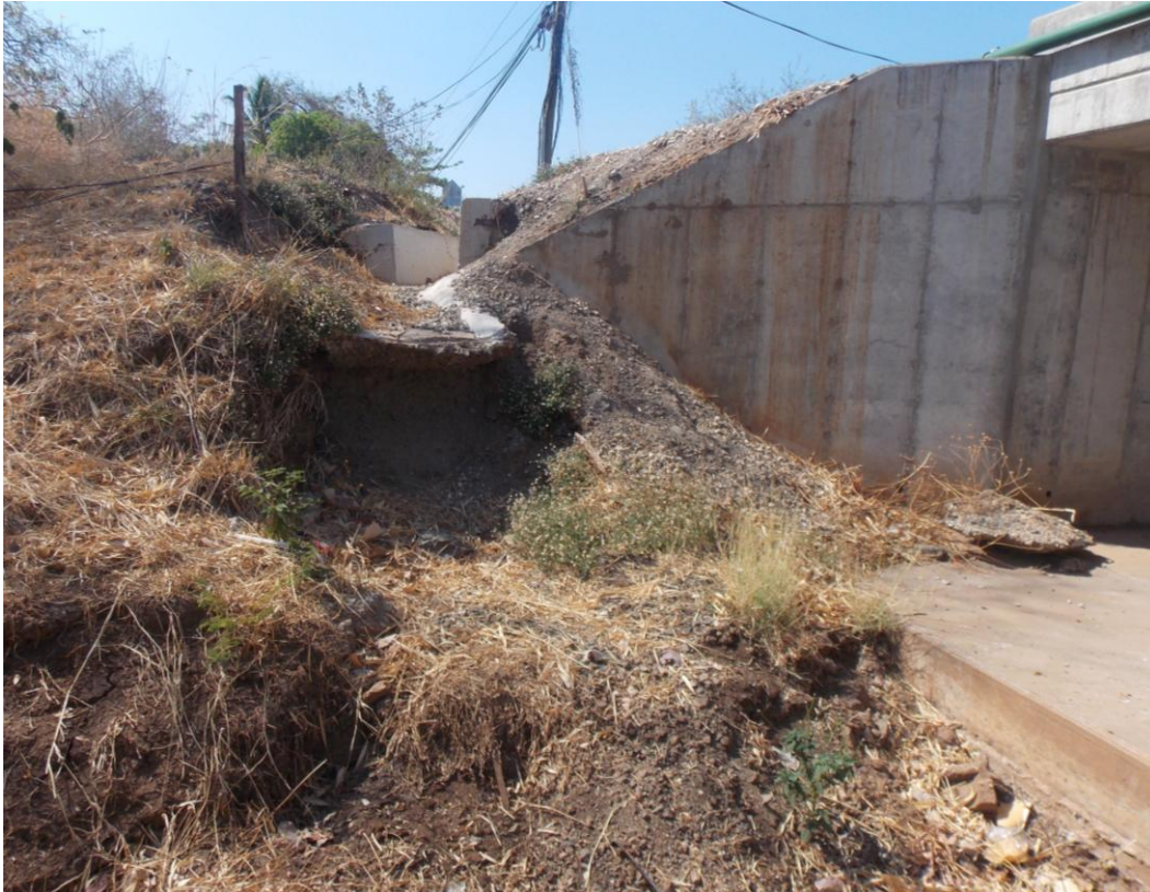
Figura 11: cuneta en voladizo, y grada en el delantal de salida, alcantarilla en la est. 13+100
