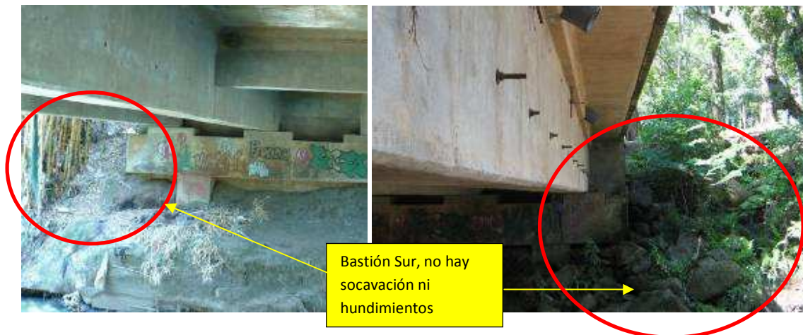
Figura 13. Bastión-Sur no cuenta con aletones
