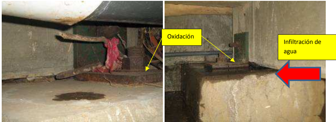
Figura 11. Oxidación y corrosión de los angulares ubicados junto a los apoyos debido al agua infiltrada por la junta de expansión.
