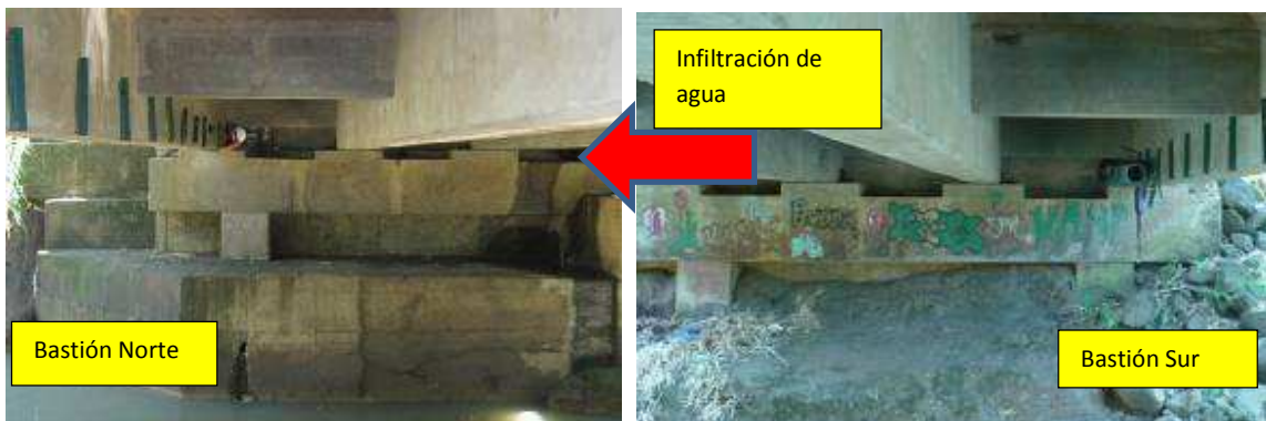
Figura 12. Infiltración de agua sobre el Bastión-Norte.
