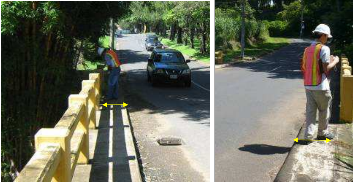
Figura 5. Aceras con anchos insuficientes para el paso peatonal.
