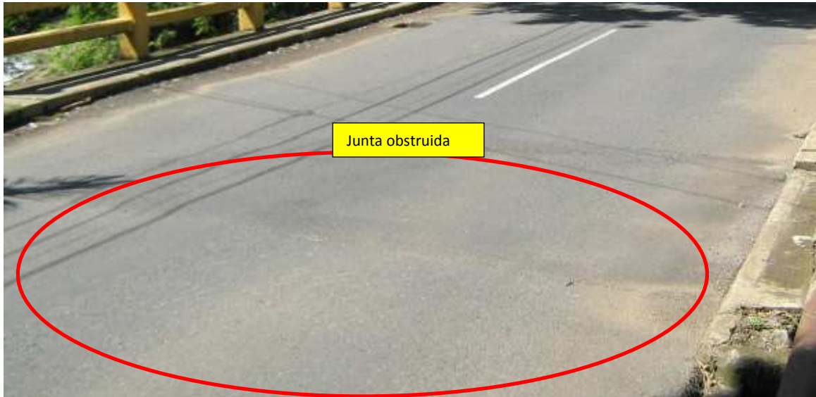
Figura 9. Junta obstruida por una sobrecapa de mezcla asfáltica.
