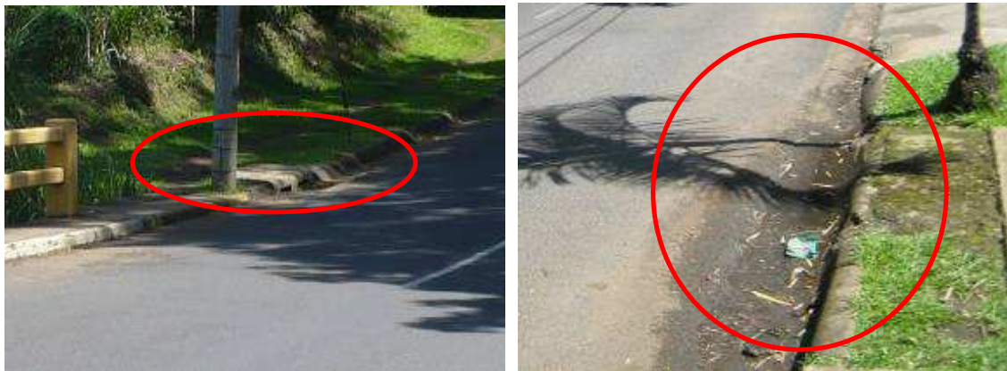
Figura 8. El sistema de drenajes de los accesos aparenta ser insuficiente.
