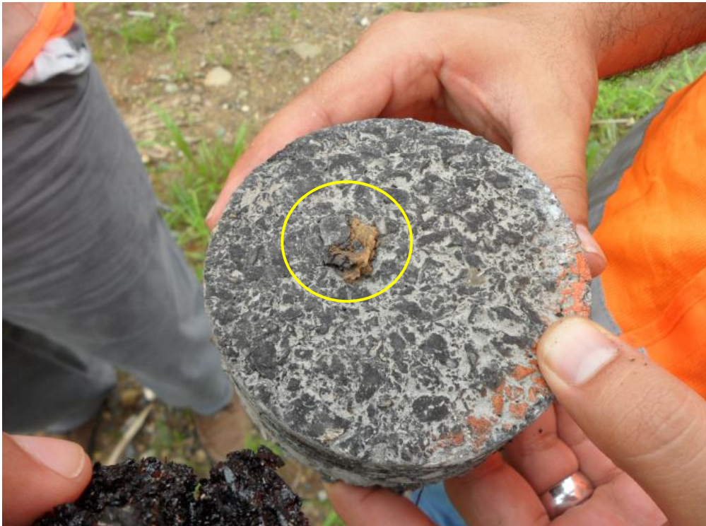
Figura 11. Núcleos encontrados en las orillas de la vía, los cuales muestran la presencia de polímeros no disueltos en tramo intervenido en Ruta Nacional N°34. Estacionamiento 5+300. Fuente: LanammeUCR, Julio 2013.
