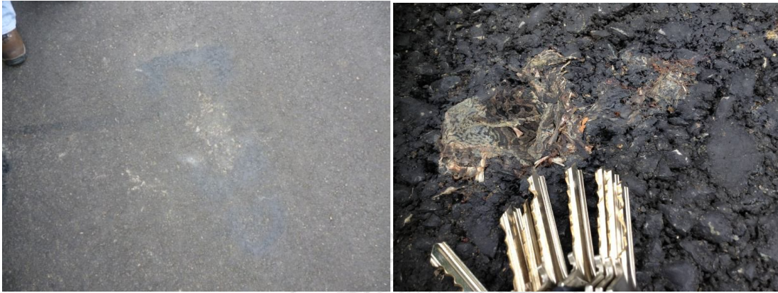
Figura 8. Acumulación de polímero en la superficie asfáltica colocada. Estacionamiento 7+000.
