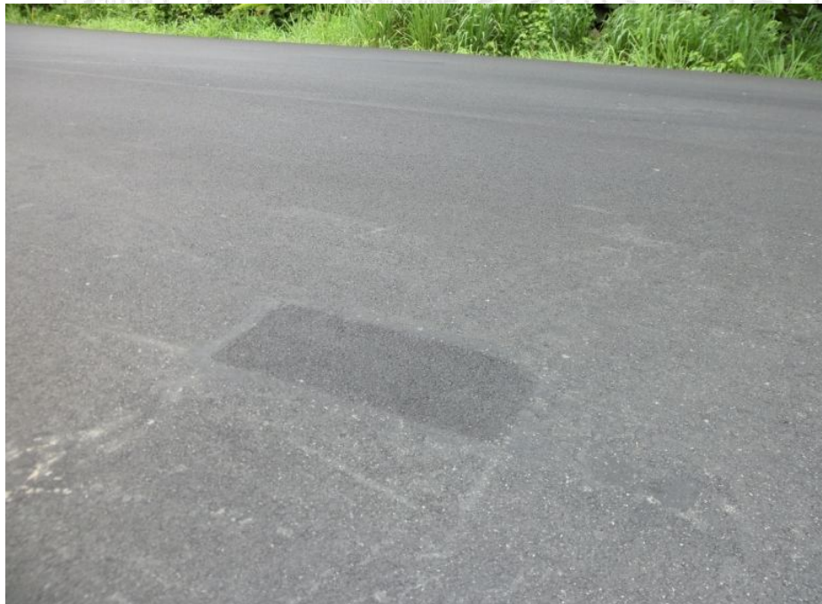
Figura 9. Reparaciones con bacheo en el tramo de la Ruta Nacional N°34, recientemente intervenido con la capa asfáltica modificada. Estacionamiento 5+300.
