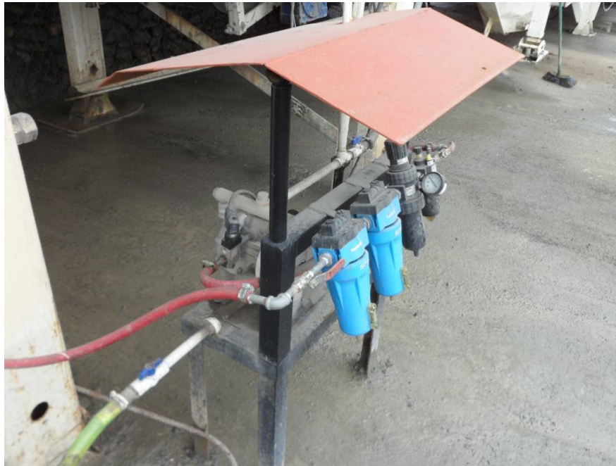
Figura 4. Sistema de bombeo del polímero utilizado en la planta de mezcla asfáltica. Fuente: LanammeUCR, Julio 2013.
