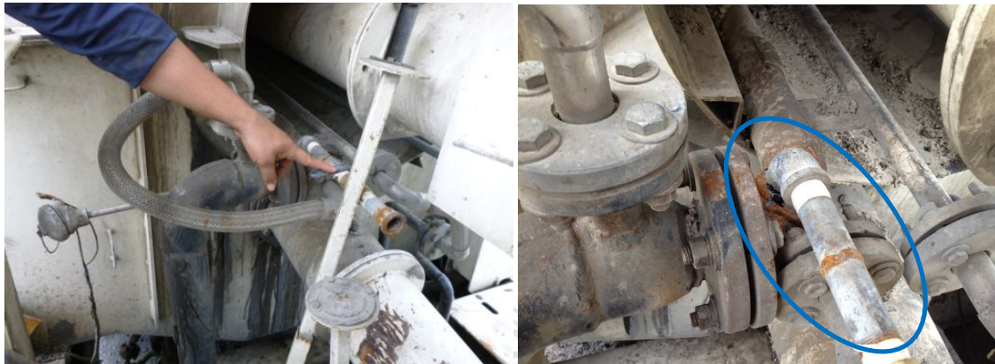
Figura 5. Punto de unión entre la tubería que transporta el polímero y la tubería que transporta el asfalto.
