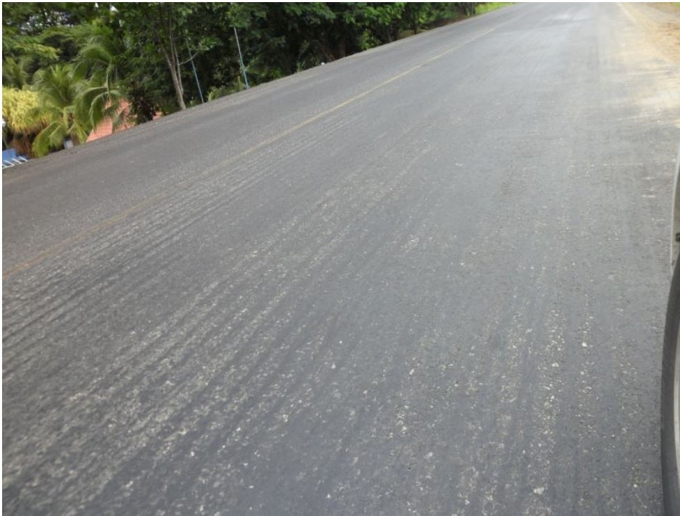
Figura 13. Trabajos inconclusos y presencia de ligante asfáltico en la superficie de ruedo casi a 10 kilómetros de la intersección de la Ruta Nacional N°34 con la No.2, en Palmar Norte. Estacionamiento 8+900. Fuente: LanammeUCR, Julio 2013.
