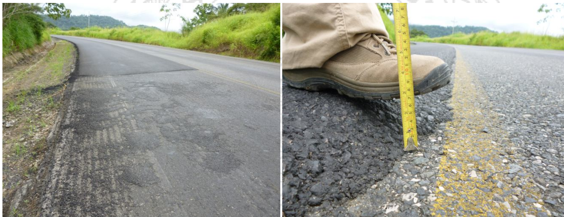
Figura 14. Final de tramo intervenido y presencia de grada entre carriles Ruta Nacional N°34 sector de Ojo de Agua. Estacionamiento 9+600. Fuente: LanammeUCR, Julio 2013.
