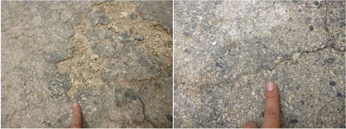
Fotografía 4. Agrietamientos leves en el sello superficial de impermeabilización.
