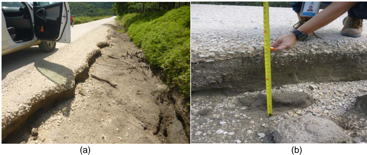
Fotografía 12. Erosión de cuneta en lado derecho del camino con profundidad de 50 cm.
