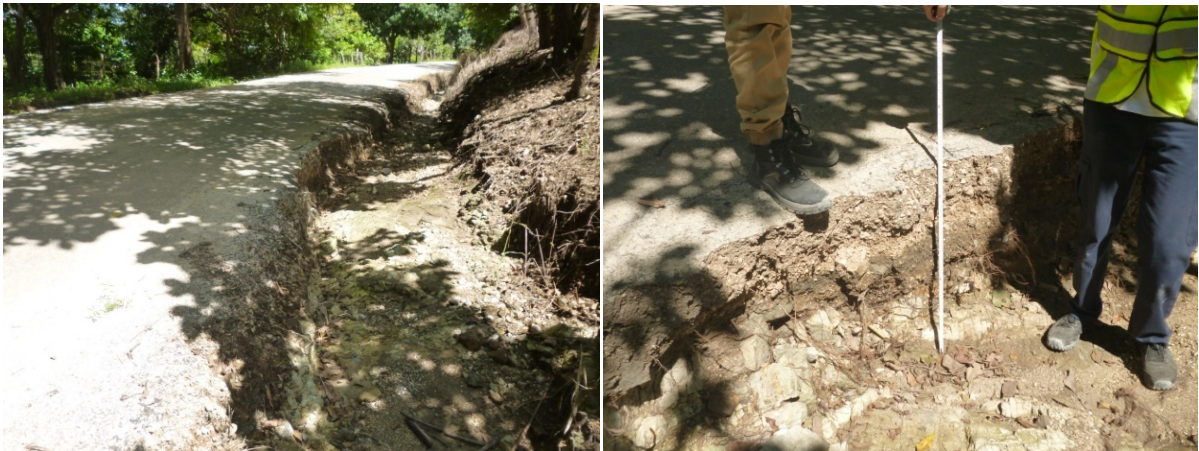
Fotografía 10. Erosión de cuneta en lado derecho del camino con profundidad de 1 m.
