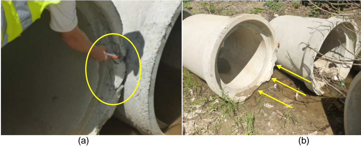
Fotografía 14. Tubería de concreto para paso de alcantarilla con quebraduras en campana y acero de refuerzo expuesto.
