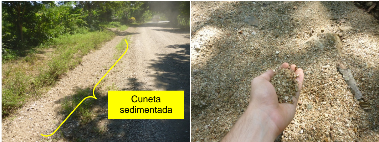
Fotografía 11. Sedimentación de cunetas debido a erosión de tramo de erosión previo en cuneta.
