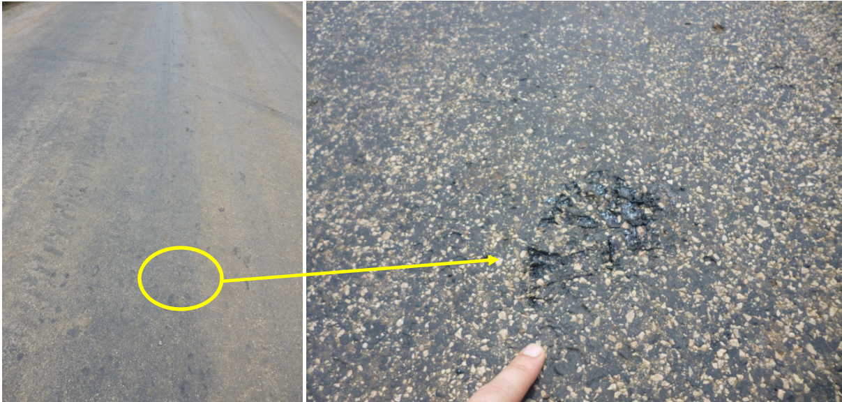
Fotografía 6. Exudación evidente en capa de material estabilizado con emulsión asfáltica. Ubicación: Ruta Nacional 150, Sección de Control 50782, Zona 2-4 Nicoya, kilómetro 12+360. Fecha: 27-10-2016. Fuente: LanammeUCR.
