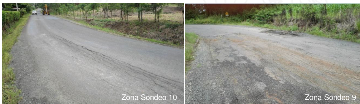
Figura 22. Otras zonas con deformaciones de la calzada en camino San Isidro.
