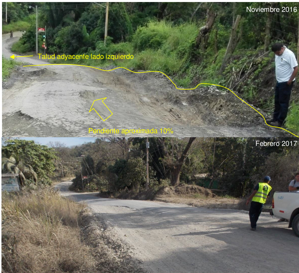
Figura 21. Tramo 150 m que presenta deformaciones del terraplén del camino San Isidro.
