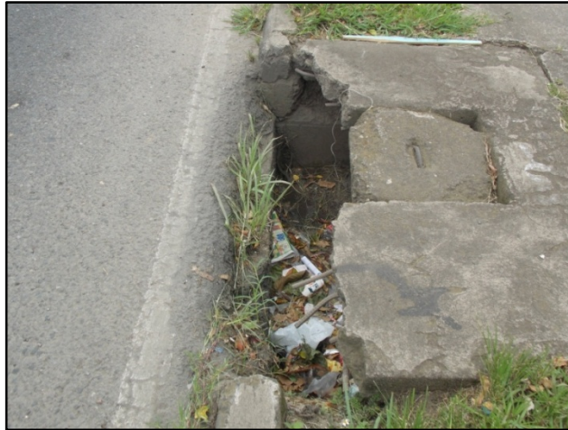
Figura No.8 Tragante 7, se observan elementos quebrados y acumulación de sedimentos y basura.
