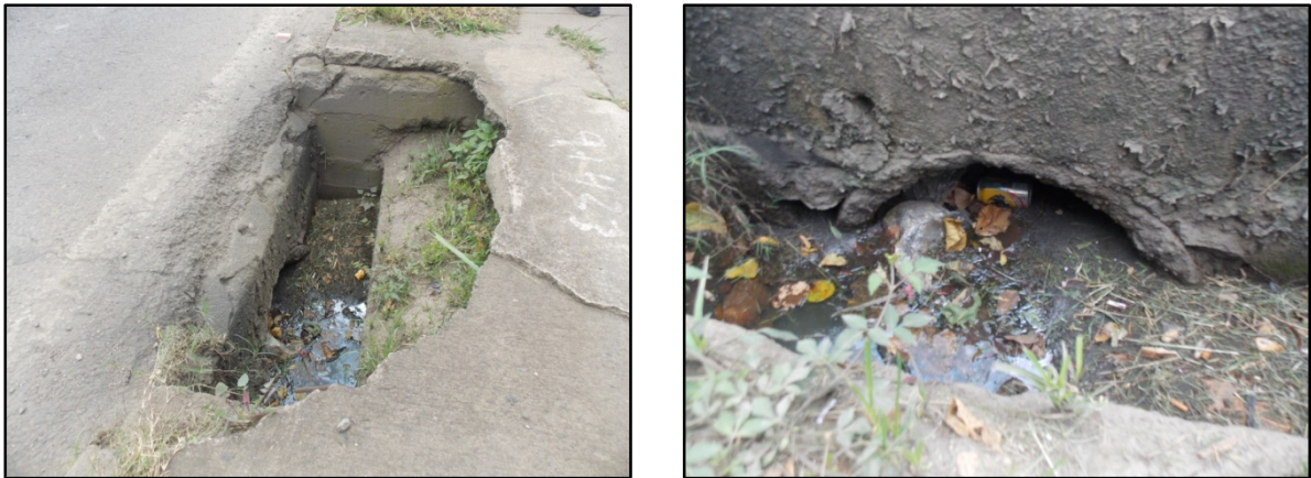
Figura No.4 Tragante No.3 con alcantarilla obstruida por basura y sedimentos.
