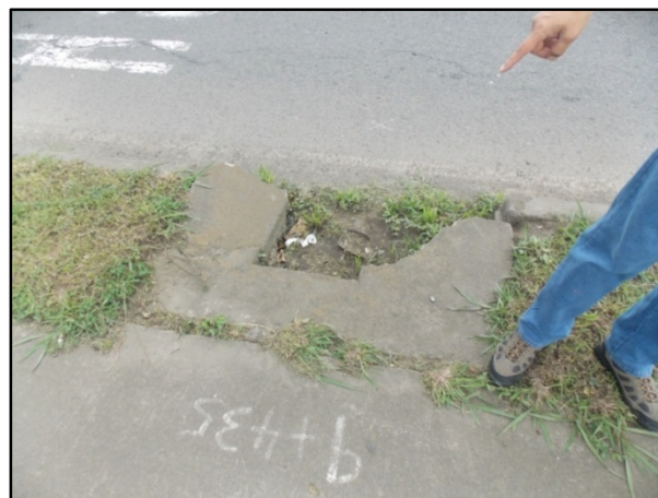
Figura No.3 Tragante de alcantarilla obstruida. Lado derecho sentido Paso Ancho – Y Griega.
