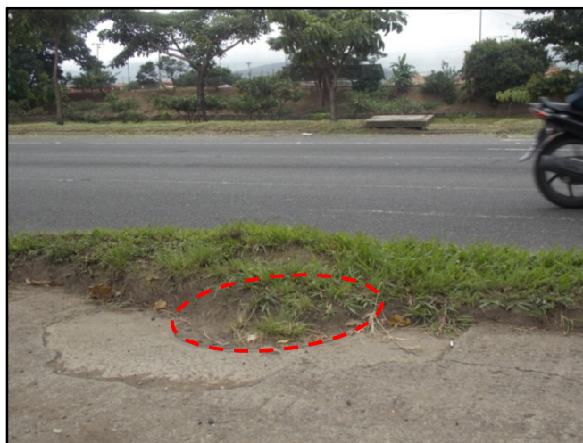
Figura No.9 Pozo de inspección lleno de sedimentos.
