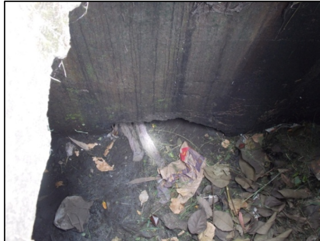
Figura No.6 Tubería de la alcantarilla obstruida en estación 9+606.
