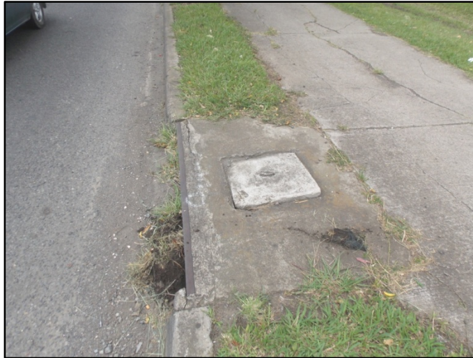
Figura No.10 Entrada a tragante 9, obstruido parcialmente por sedimentos.
