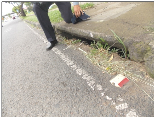
Figura No.11 Vista del Tragante 10, lado derecho en sentido Y Griega – Paso Ancho.
