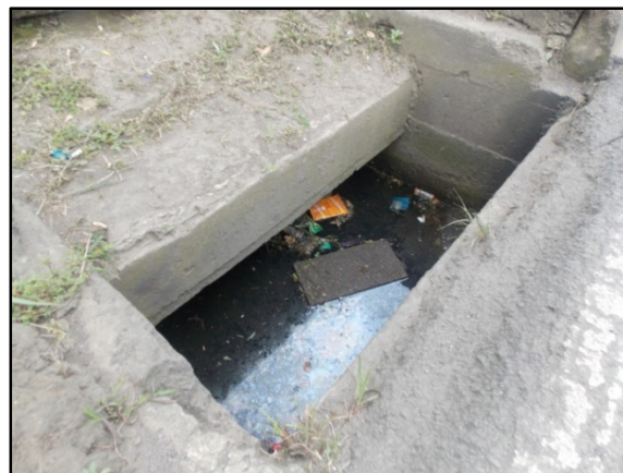
Figura No.5 Tragante 4, falta la estructura superior, alcantarilla inundada y parcialmente obstruida.
