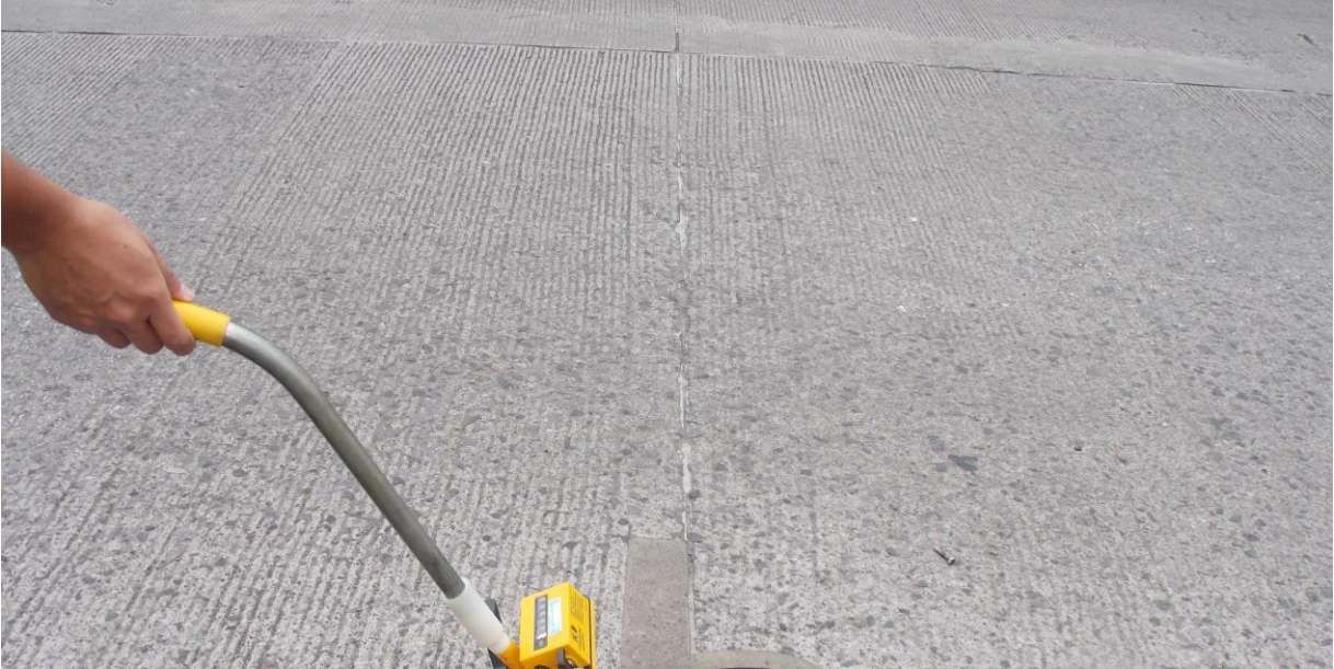
Figura A1: Estado de la junta y losas, est. 0+047,5; sentido Zapote – San Francisco
