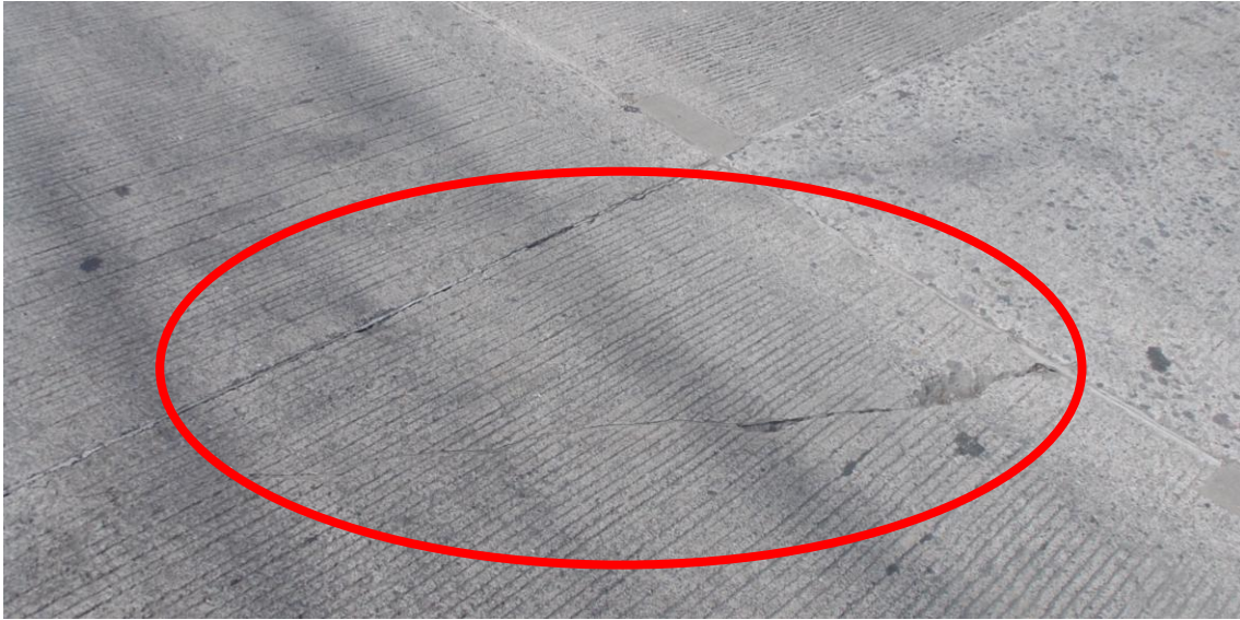
Figura 8: Grieta en el borde de la losa, estacionamiento 0+146, sentido San Francisco – La Colina
