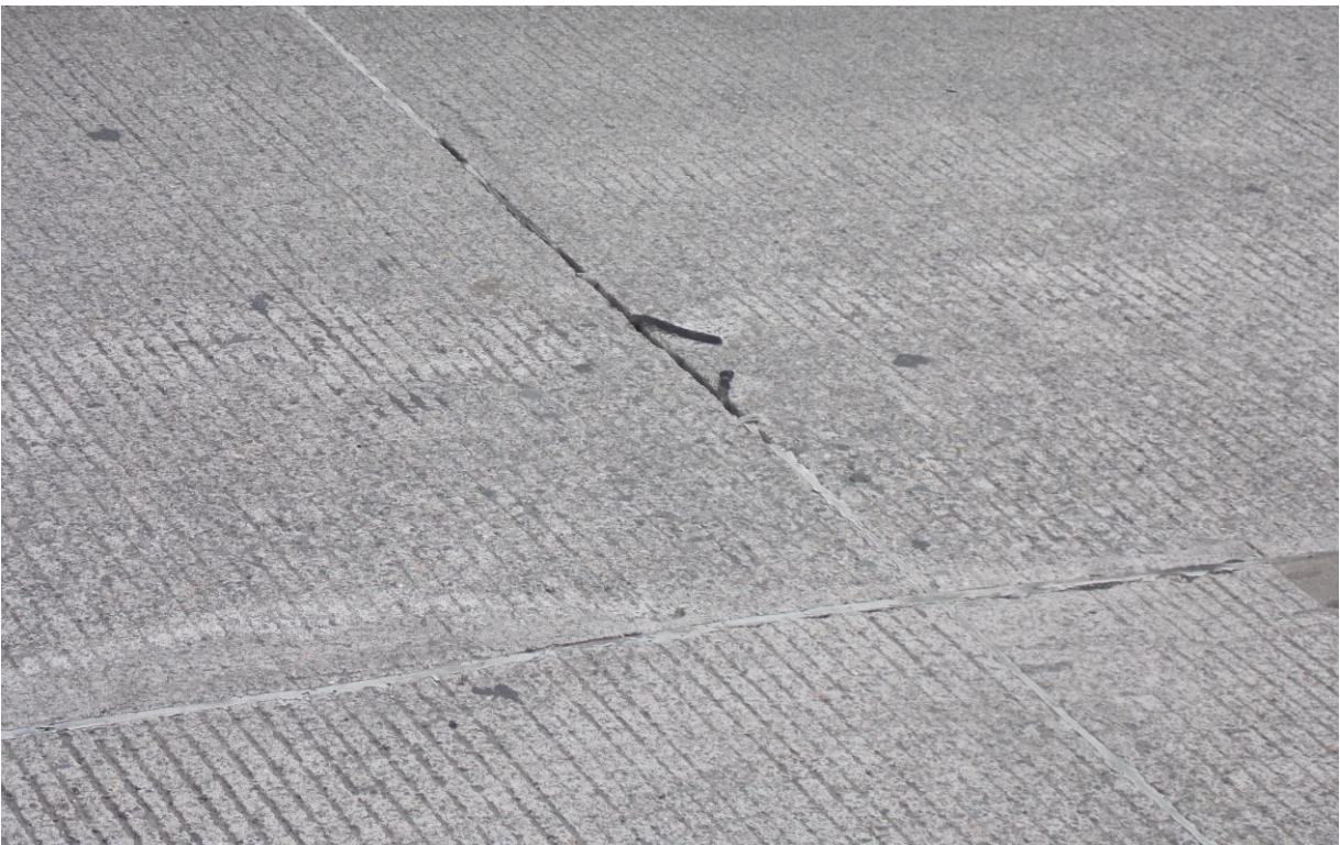
Figura A2: Estado de la junta, est. 0+291,0; sentido Zapote – San Francisco
