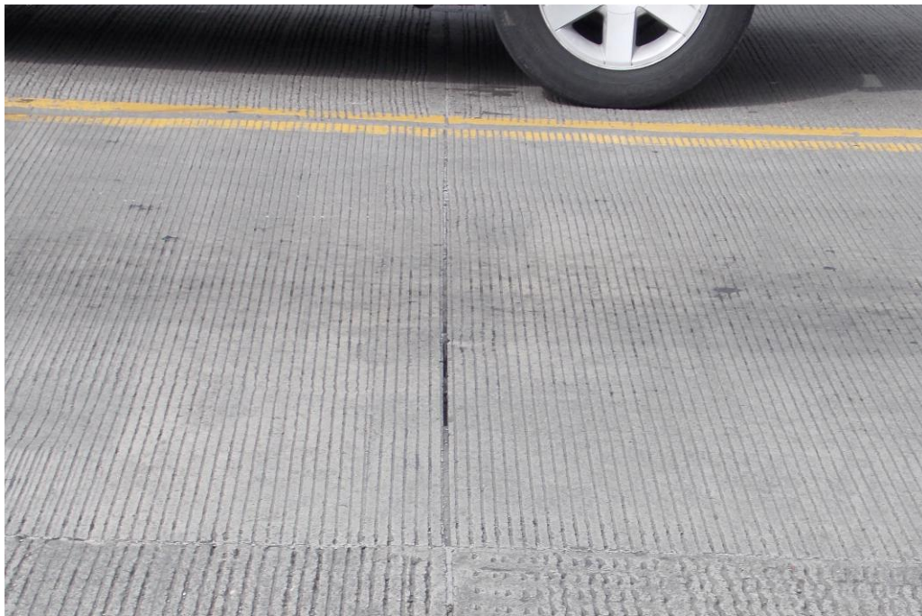
Figura A8: Estado de junta en losa interna, est. 0+097,5; sentido San Francisco – La Colina
