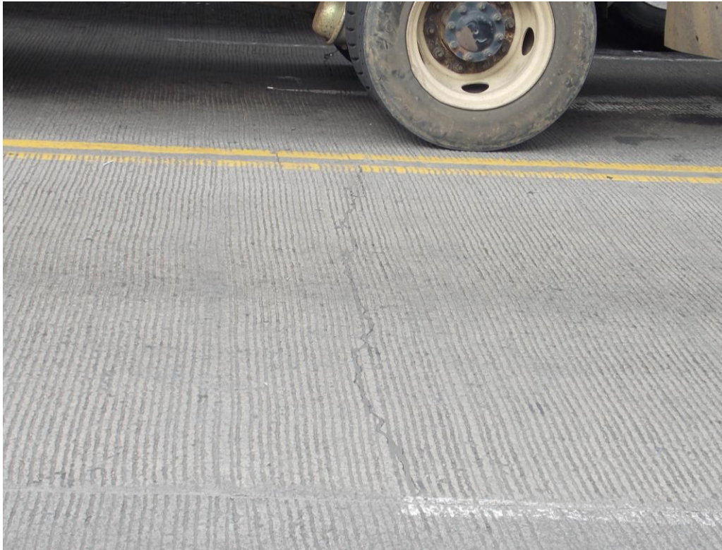
Figura A7: Grieta central en losa interna, est. 0+025,1; sentido San Francisco – La Colina
