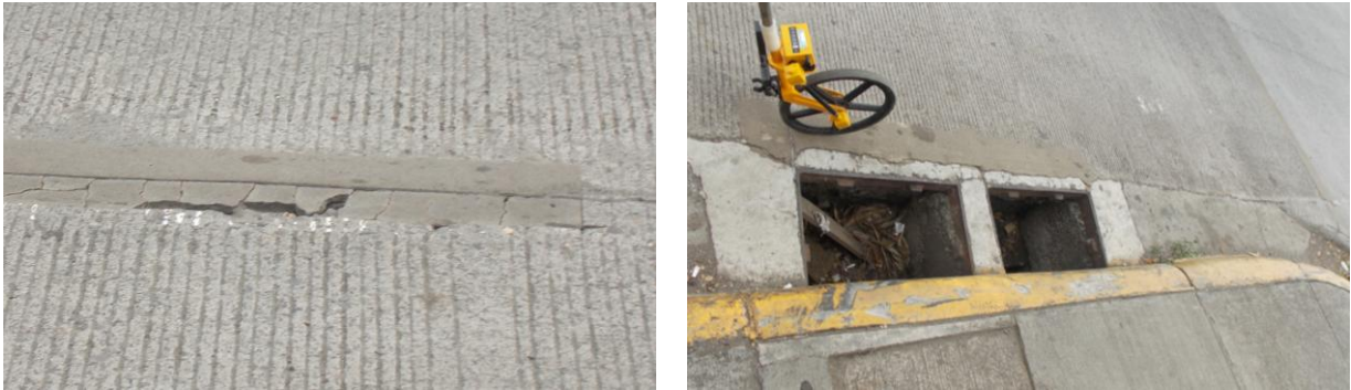
Figura A15: Estado de reparación y cabezal, est. 1+060,5 y 1+078,8; sentido San Francisco – La Colina
