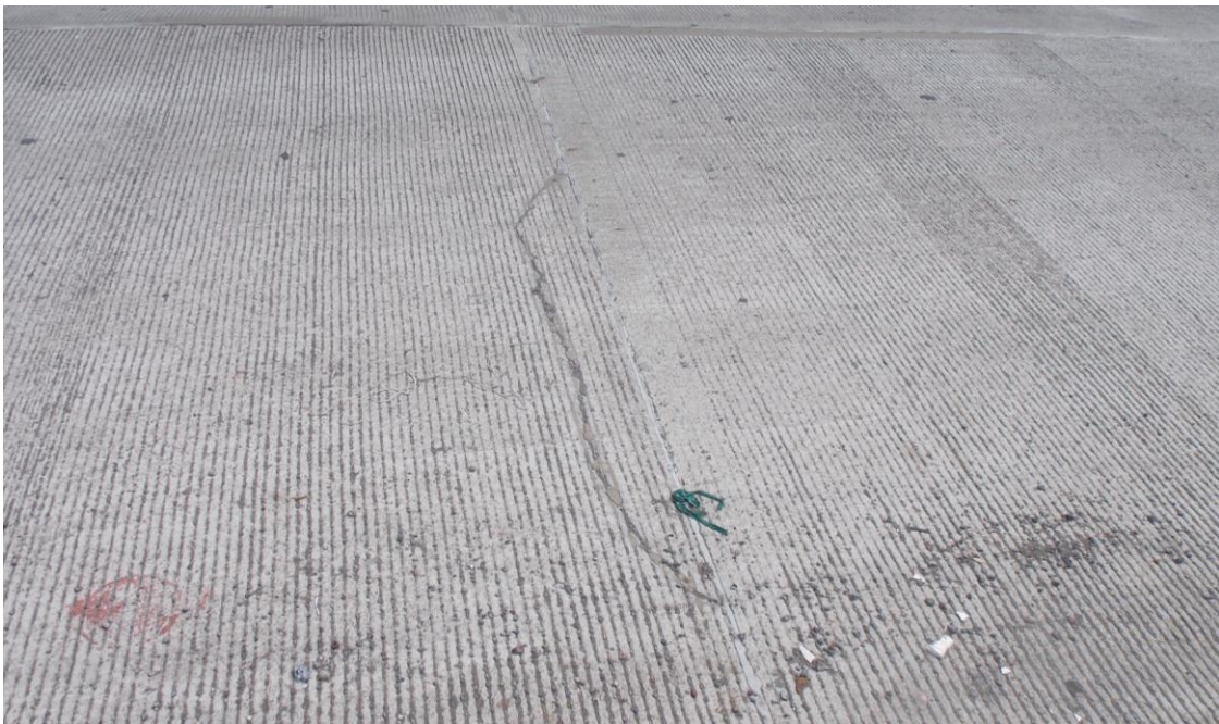
Figura A6: Grieta en el borde de la losa, est. 0+670,6; sentido Zapote – San Francisco
