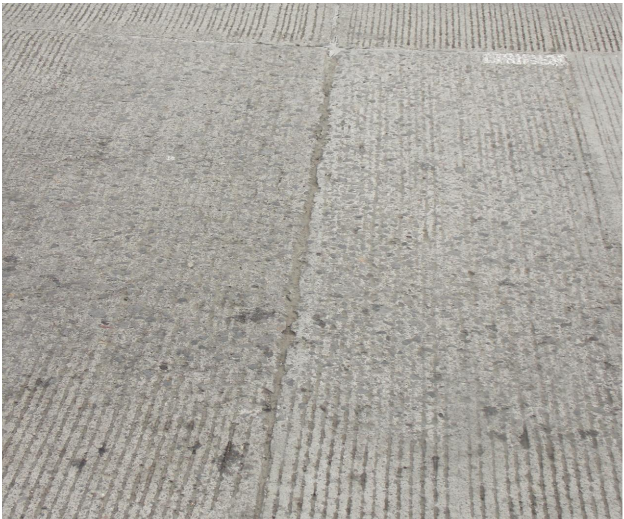
Figura A16: Estado de la junta y losas, est. 1+147,8; sentido San Francisco – La Colina
