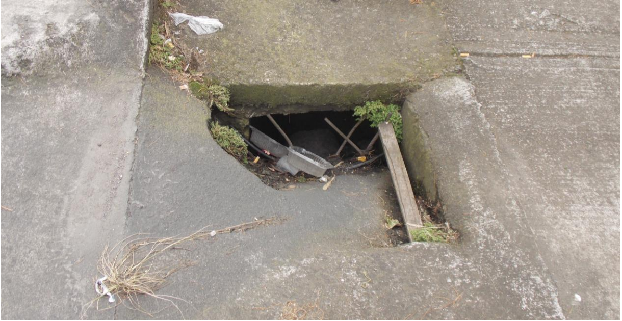
Figura A3: Estado del cabezal de entrada, est. 0+422,0; sentido Zapote – San Francisco
