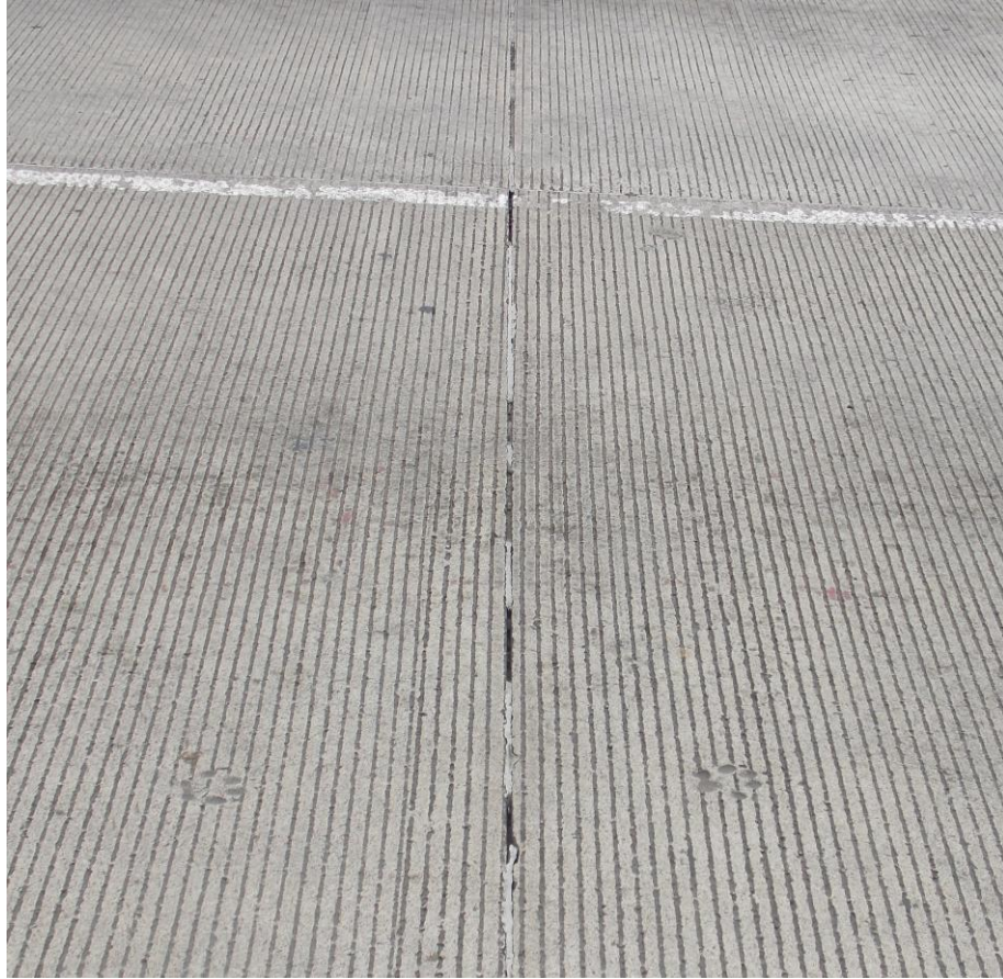
Figura A17: Estado de la junta, est. 1+288,2; sentido San Francisco – La Colina
