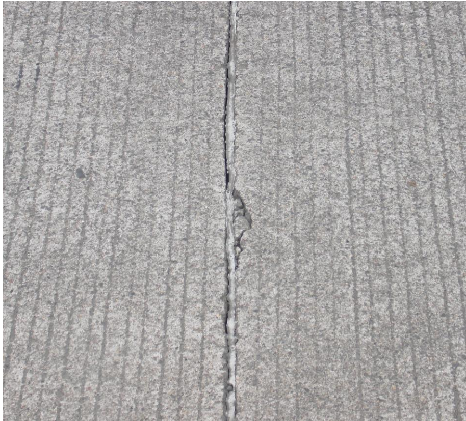
Figura A4: Estado de la junta, est. 0+486,7; sentido Zapote – San Francisco
