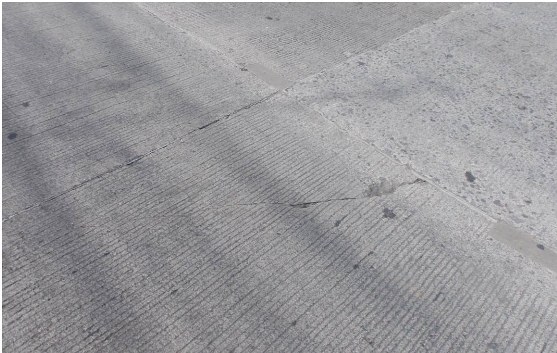
Figura A10: Grieta de borde, est. 0+313,7; sentido San Francisco – La Colina
