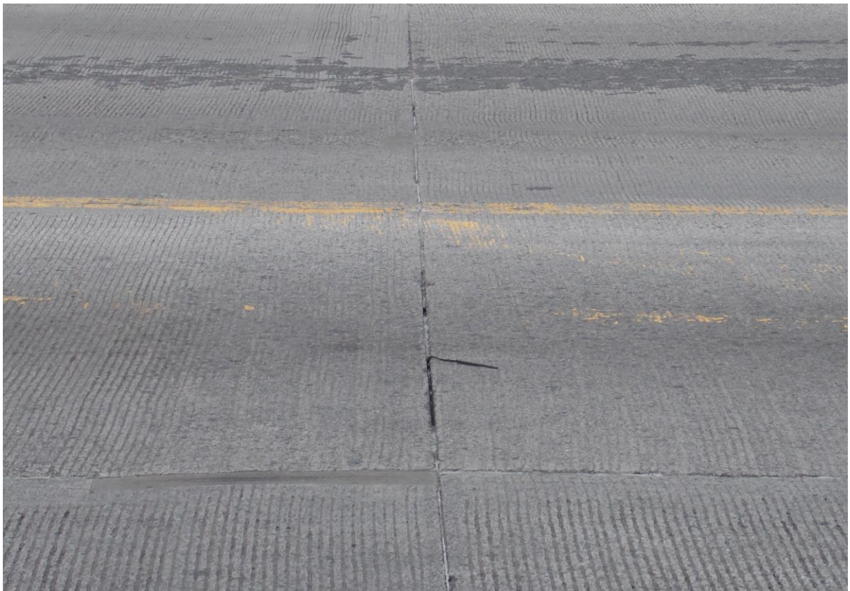
Figura A12: Estado de junta en losa interna, est. 0+585,8; sentido San Francisco – La Colina
