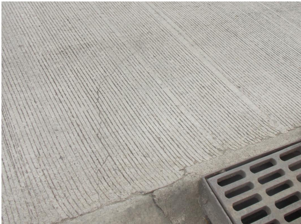
Figura A14: Grieta en borde de losa, est. 0+989,3; sentido San Francisco – La Colina
