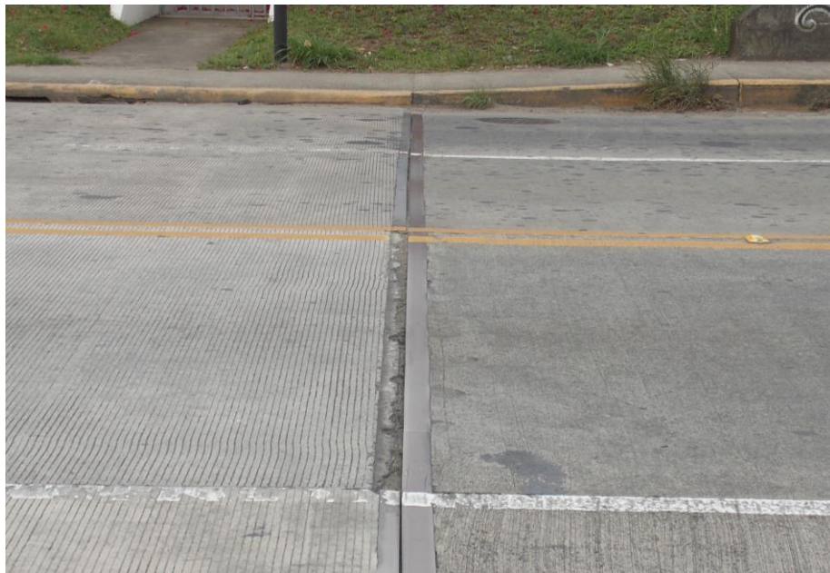
Figura A18: Junta del puente Tiribi, est. 1+316,3; sentido San Francisco – La Colina
