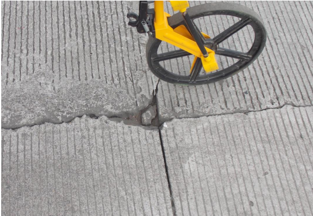
Figura A13: Estado de la junta, est. 0+701,7; sentido San Francisco – La Colina
