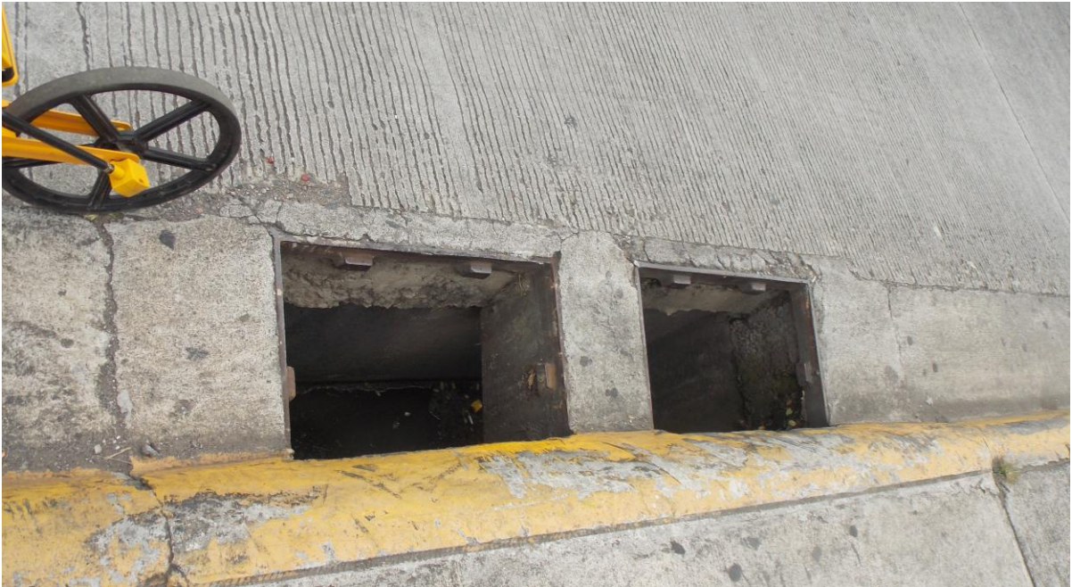
Figura A11: Estado cabezal entrada, est. 0+508,1; sentido San Francisco – La Colina
